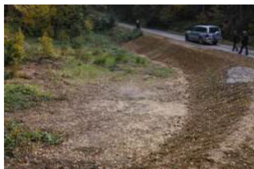
Zbiorniki na spływy powierzchniowe w N-ctwie Piwniczna
