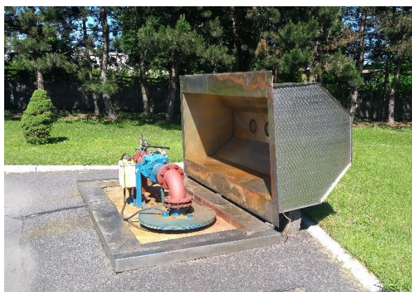
Fot. 1. Punkt sieci regionalnej Głównych Zbiorników Wód Podziemnych
