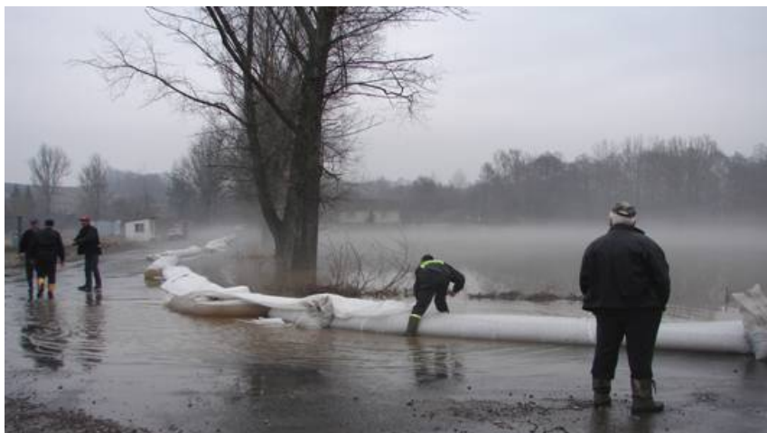
Fotografia nr 2.10. Sprawianie zapory przeciwpowodziowej wykonanej w formie rękawa foliowego w osłonie z tkaniny plastikowej
