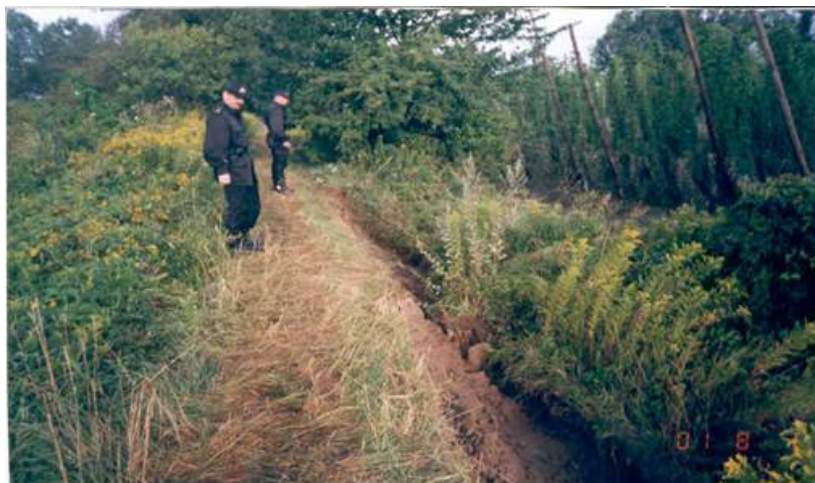
Fotografia nr 2.2. Osunięcie skarpy wału, widok po ustąpieniu wody
