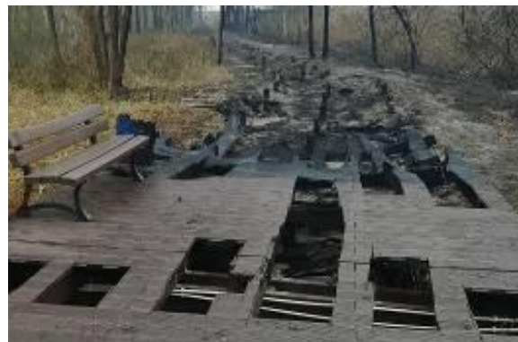
Rys. 20. Zniszczenia po pożarze.
