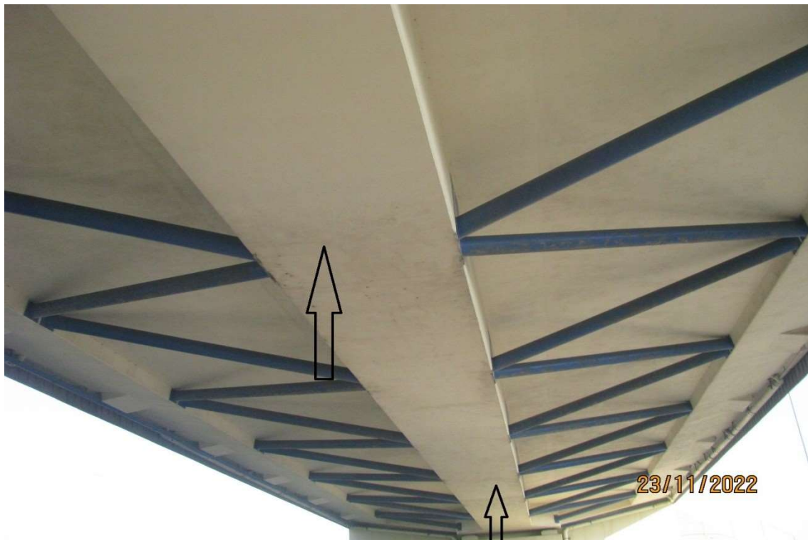
Fot. 19. Usytuowanie uszkodzeń korozyjnych na spodzie dźwigara - nad obiema jezdniami.
