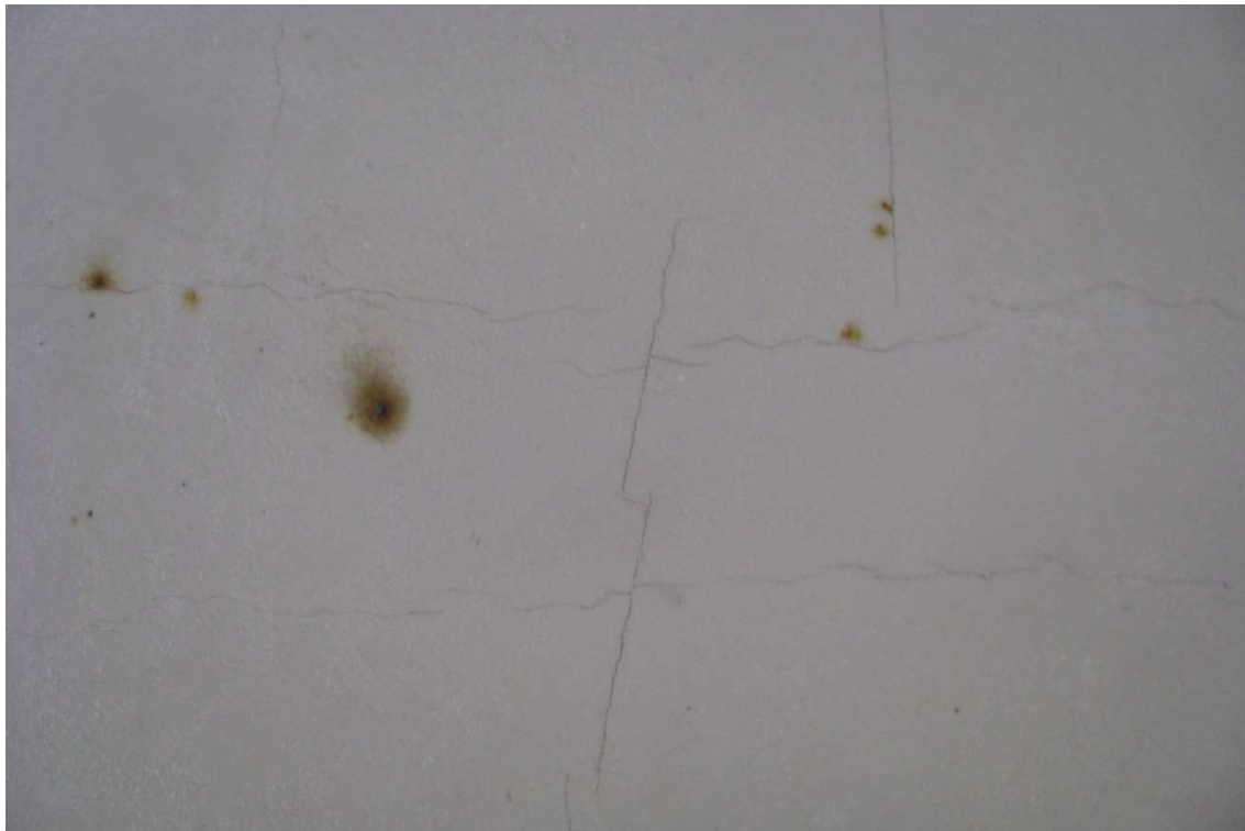
Fot. 21. Szczegół uszkodzeń korozyjnych ze zdjęcia jw - rdzawe wykwity i zarysowania betonu spowodowane korozją zbrojenia.
