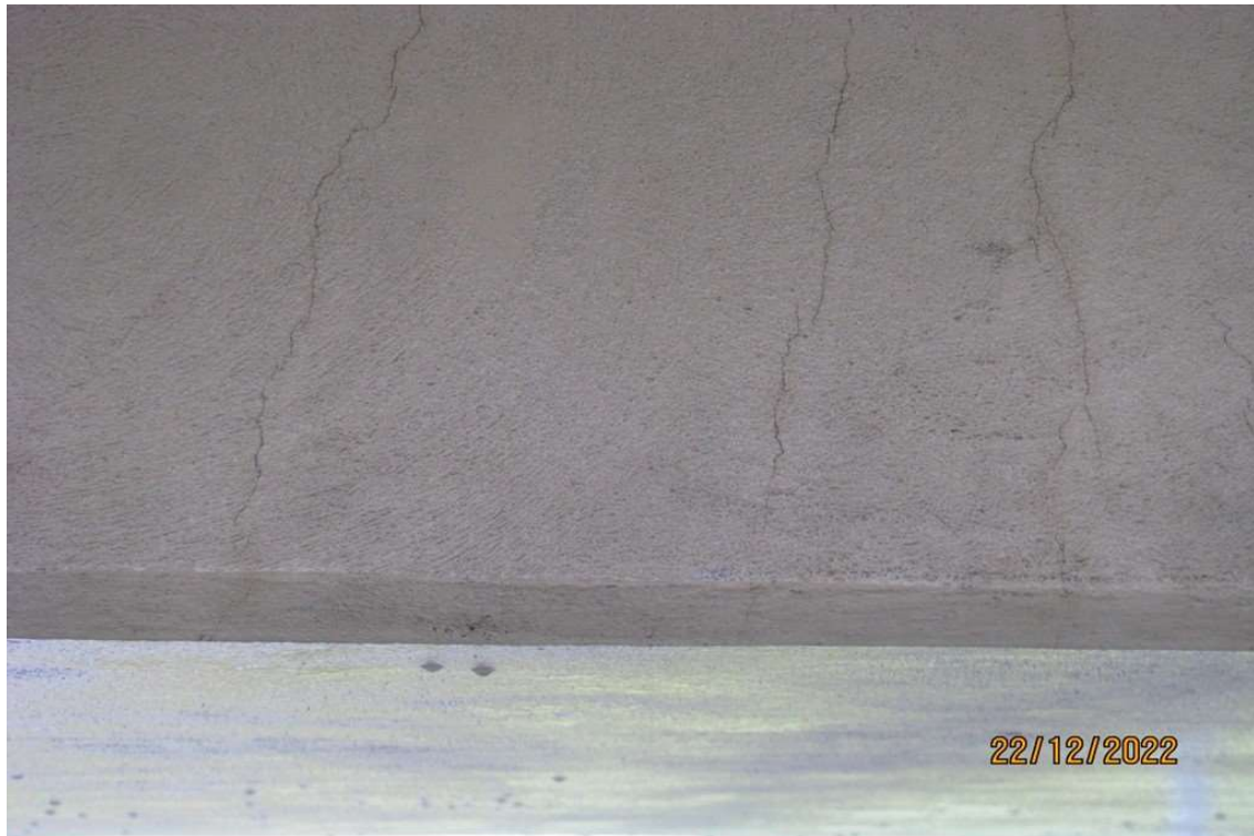
Fot. 23. Zarysowania betonu dźwigara sprężonego konstrukcji w przęśle nad jezdnią.
