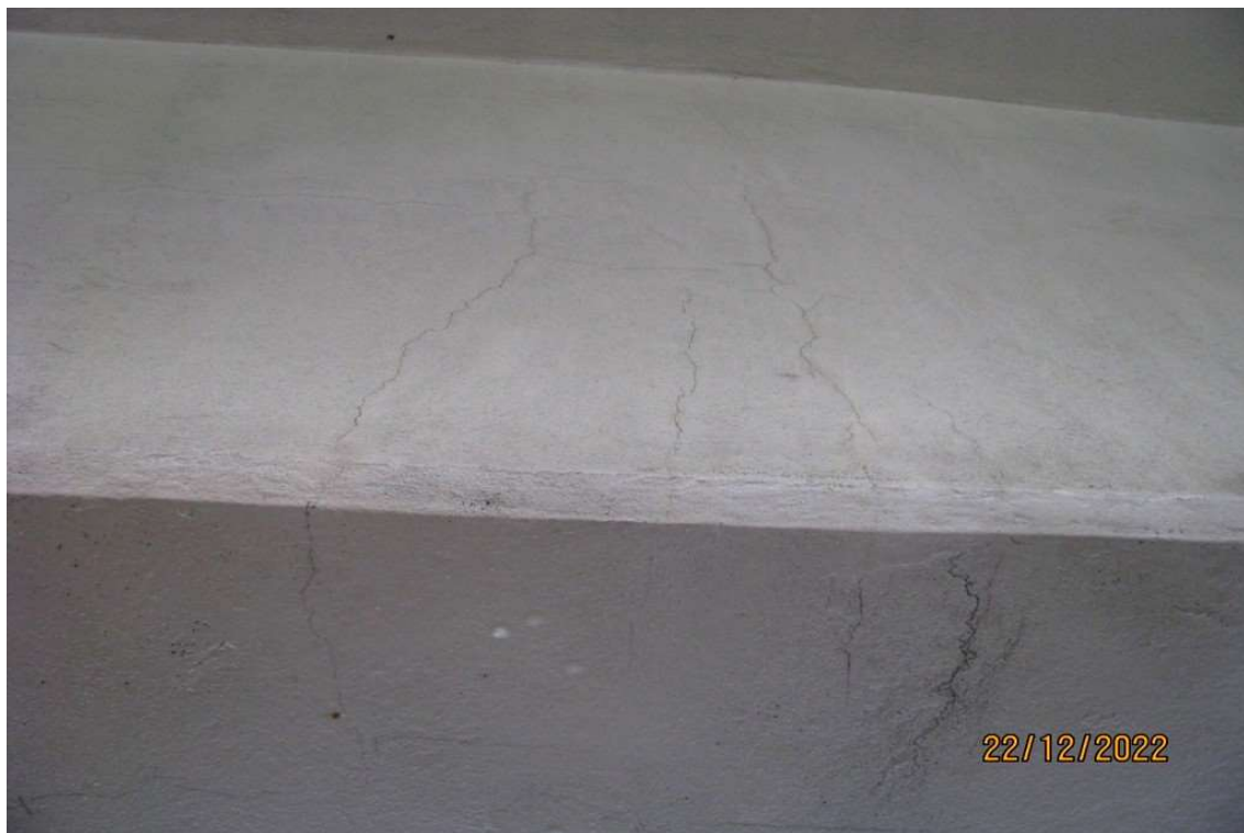
Fot. 24. Zarysowania betonu dźwigara sprężonego konstrukcji w przęśle nad jezdnią.
