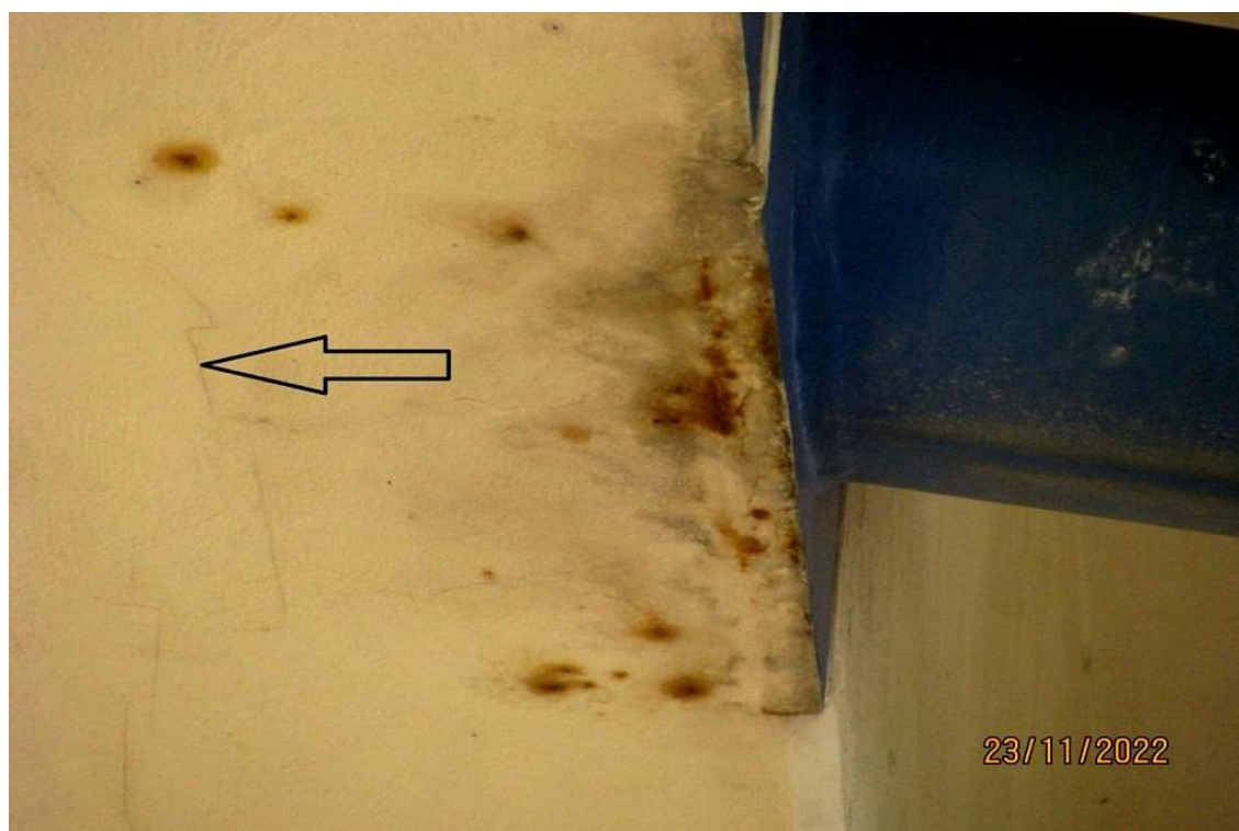
Fot. 17. Rdzawe wykwity i zarysowania betonu na spodzie dźwigara w miejscu zamocowania zastrzału konstrukcji pomostu, spowodowane korozją zbrojenia.
