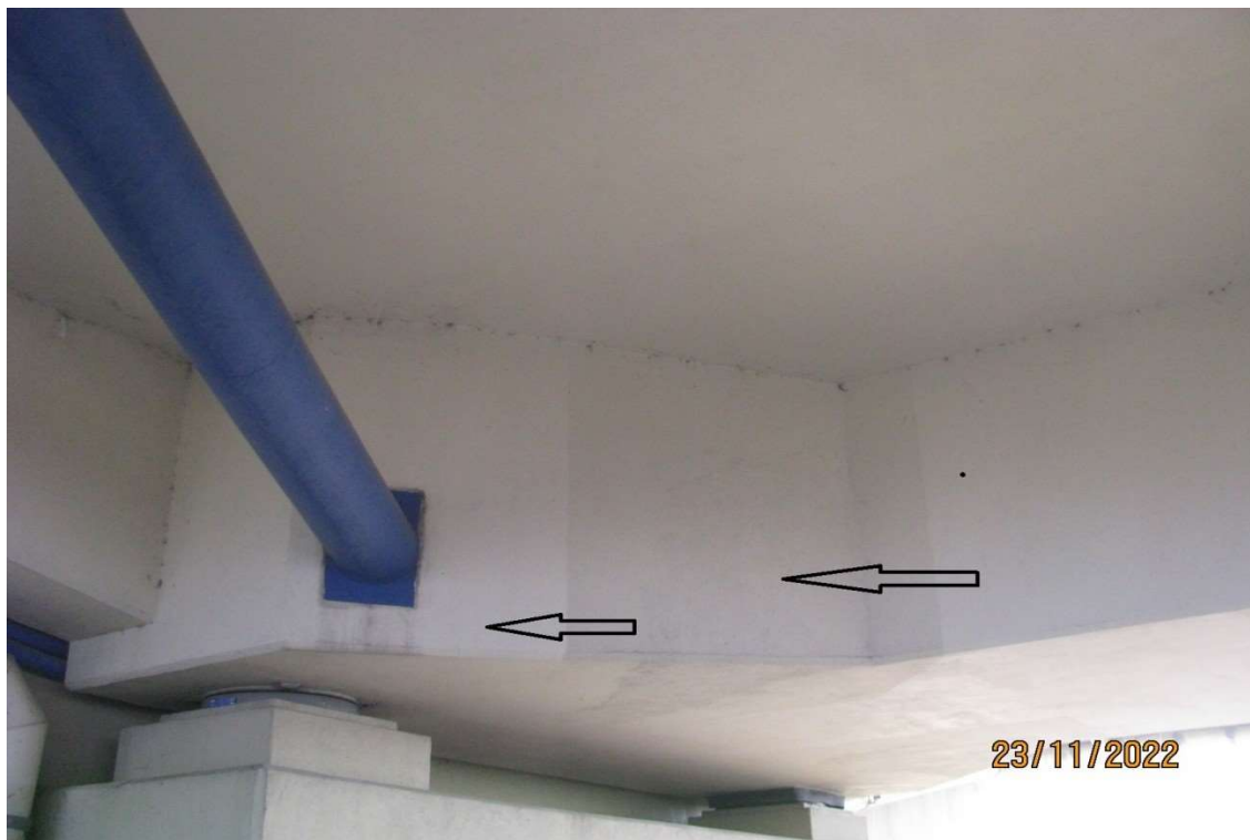
Fot. 15. Oparcie przęsła na przyczółku z zaznaczeniem zarysowań betonu.
