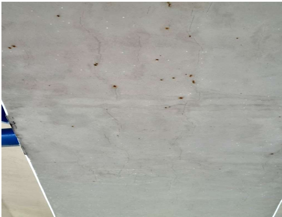
Fot. 20. Szczegół uszkodzeń korozyjnych ze zdjęcia jw - rdzawe wykwity i zarysowania betonu spowodowane korozją zbrojenia.
