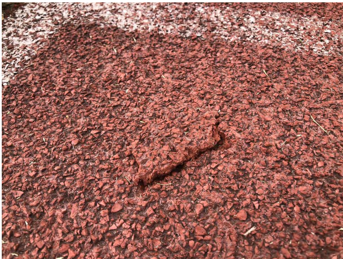
Fot. 3 Uszkodzenie mechaniczne nawierzchni
