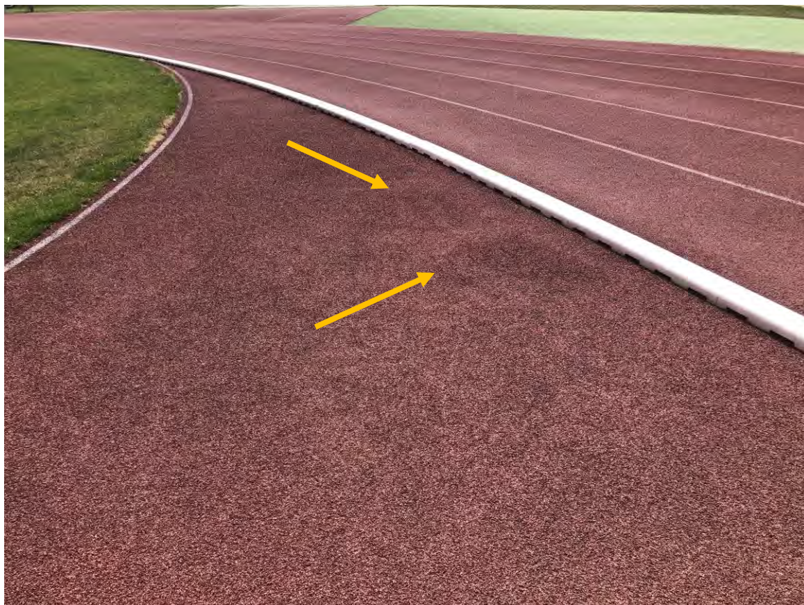
Fot. 8 Dwa „purchle” świadczące o odspojeniu nawierzchni od podłoża
