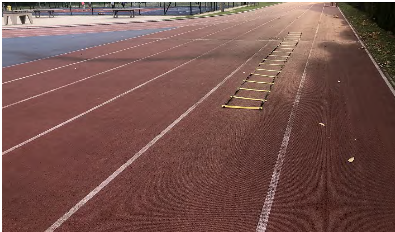
Fot. 3 Widoczne niewielkie wytarcie linii
