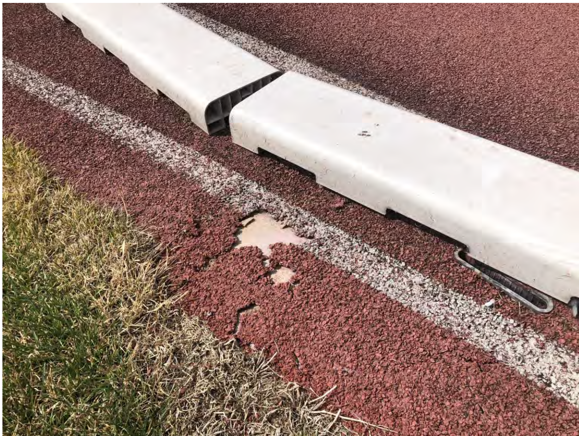
Fot. 6 Uszkodzenie nawierzchni przy odwodnieniu
