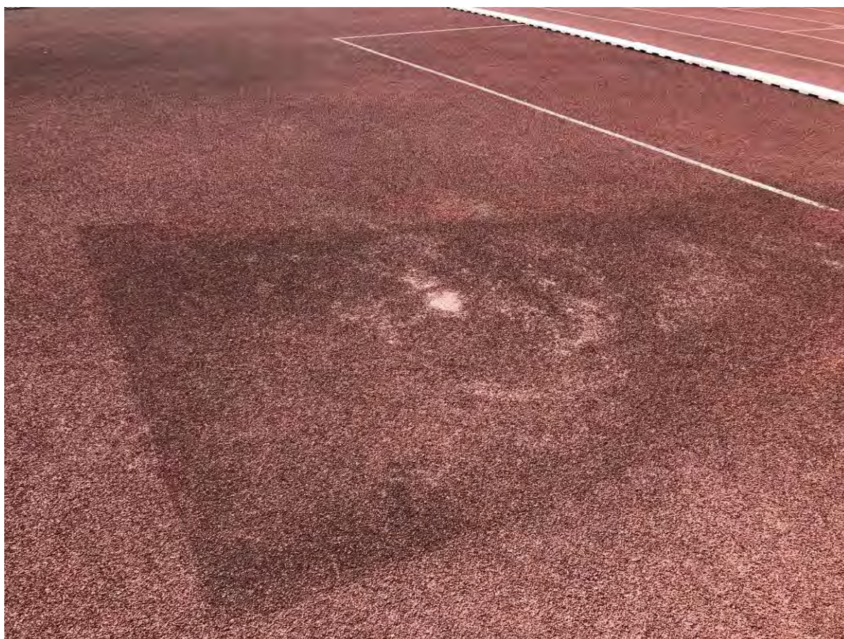
Fot. 11 Miejsce po dokonanej naprawie nawierzchni
