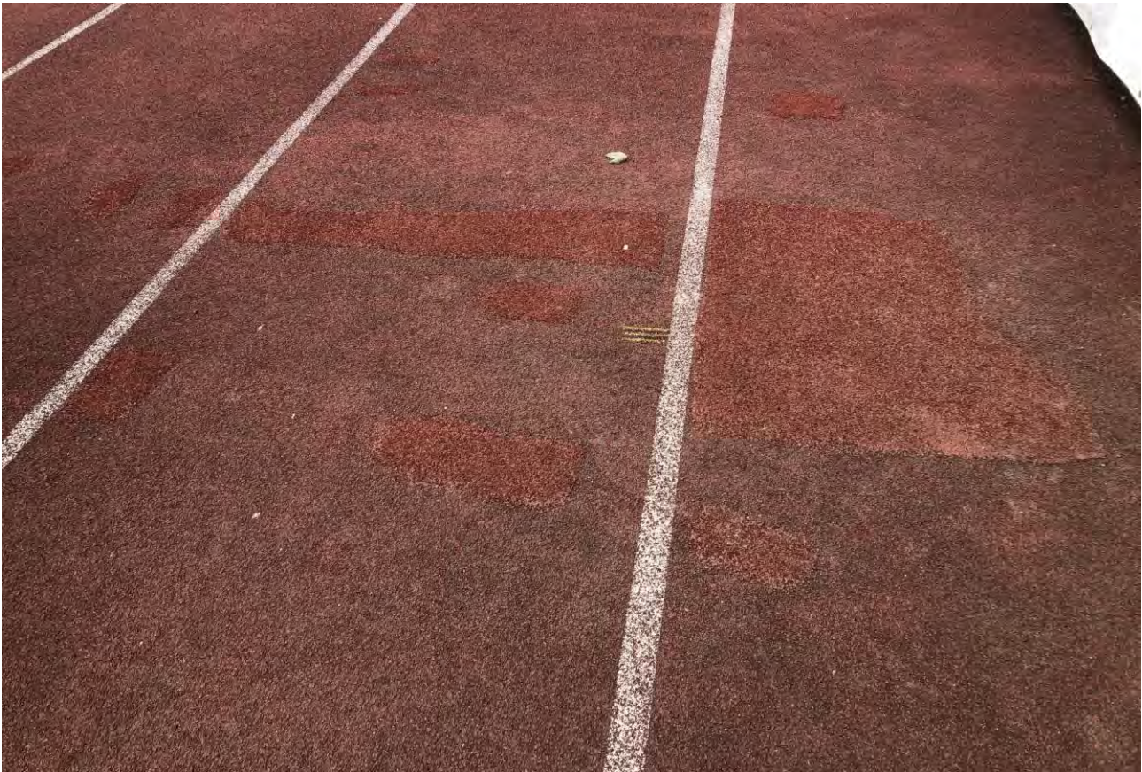
Fot. 4 Nieestetycznie wykonane lokalne naprawy nawierzchni
