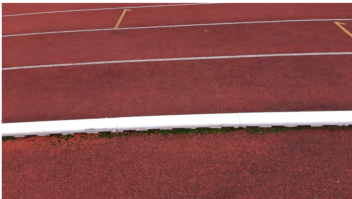
Fot. 20 Przykład organicznych zabrudzeń nawierzchni syntetycznej
