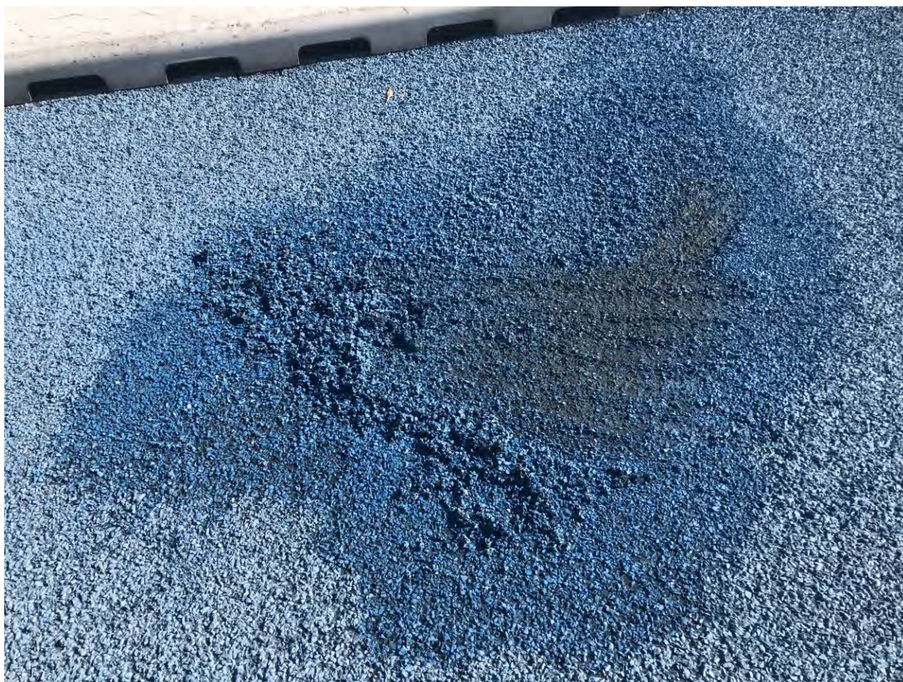
Fot. 5 Obecność luźnego granulatu EPDM na zakolu D
