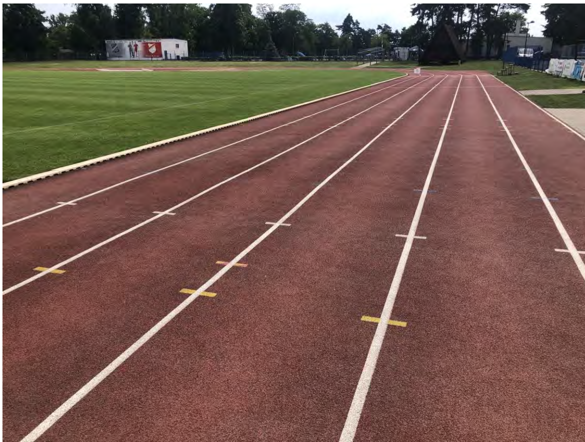
Fot. 6 Widoczne ślady wytarcia na środkach torów
