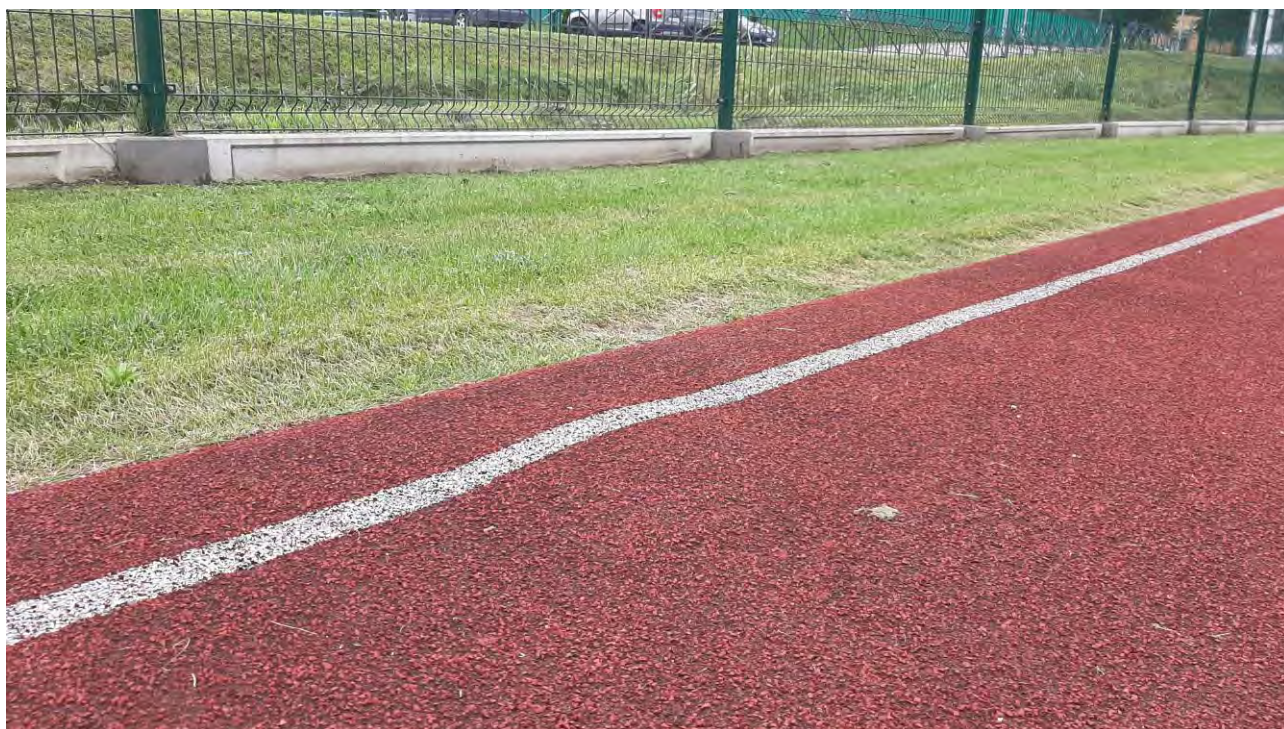
Fot 7 Widoczne wybrzuszenie (w tyle, za ogrodzeniem znajduje się rów z wodą)
