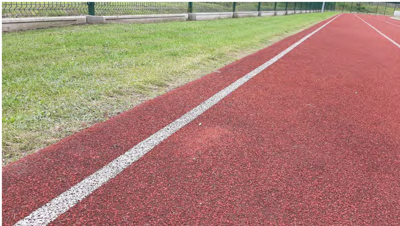
Fot 8 Widoczne wybrzuszenie
