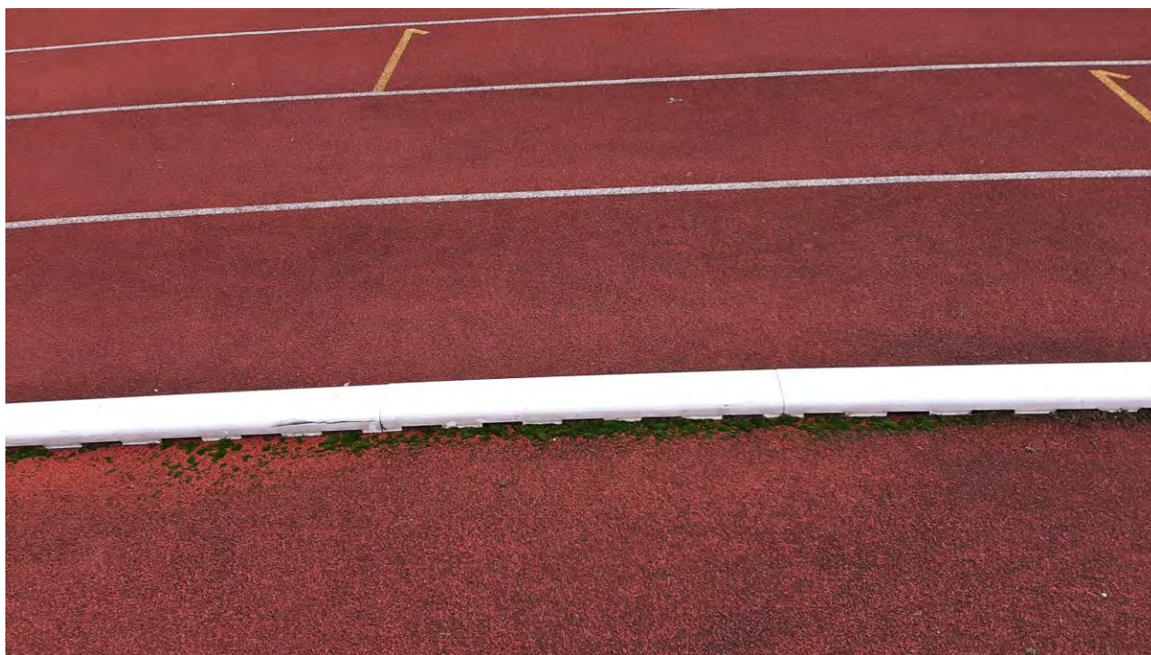
Fot. 6 Widoczne porostanie nawierzchni zielonymi wykwitami
