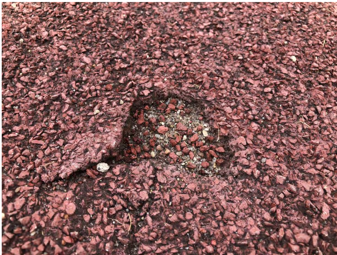
Fot. 7 Uszkodzenie nawierzchni na zakolu D
