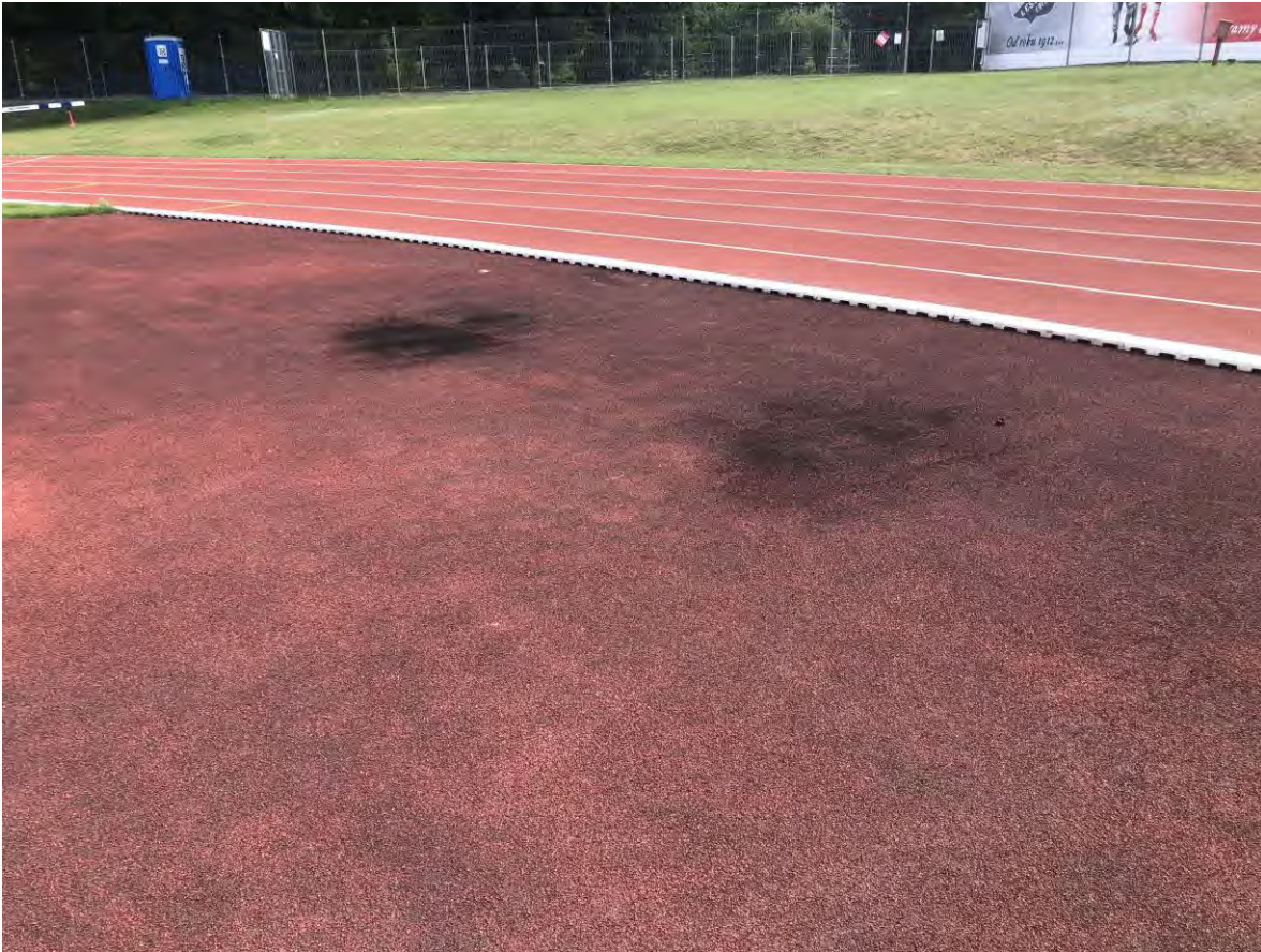
Fot. 8 Miejsca zalegania wody po opadach deszczu
