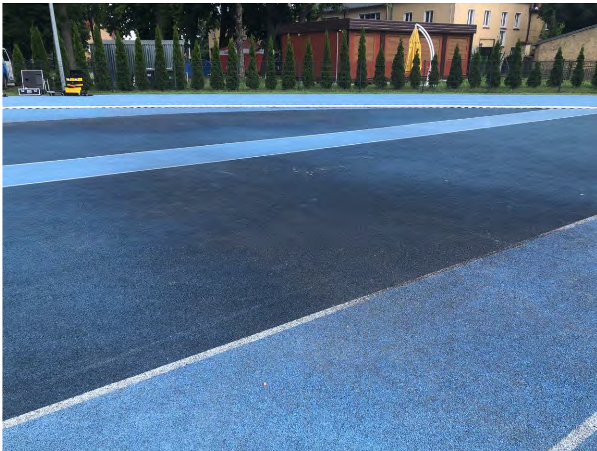
Fot. 6 Widoczne ślady po zastoinach wodnych
