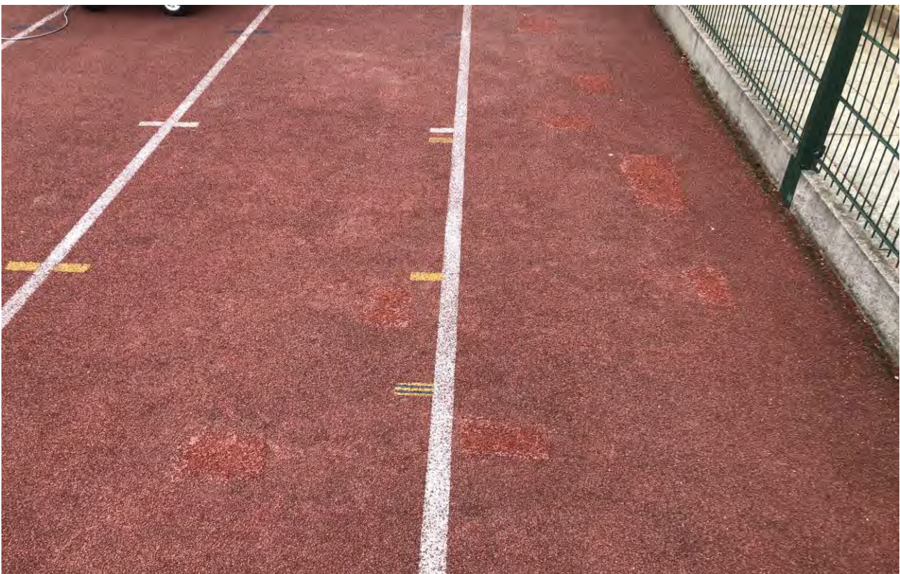
Fot. 5 Nieestetycznie wykonane lokalne naprawy nawierzchni
