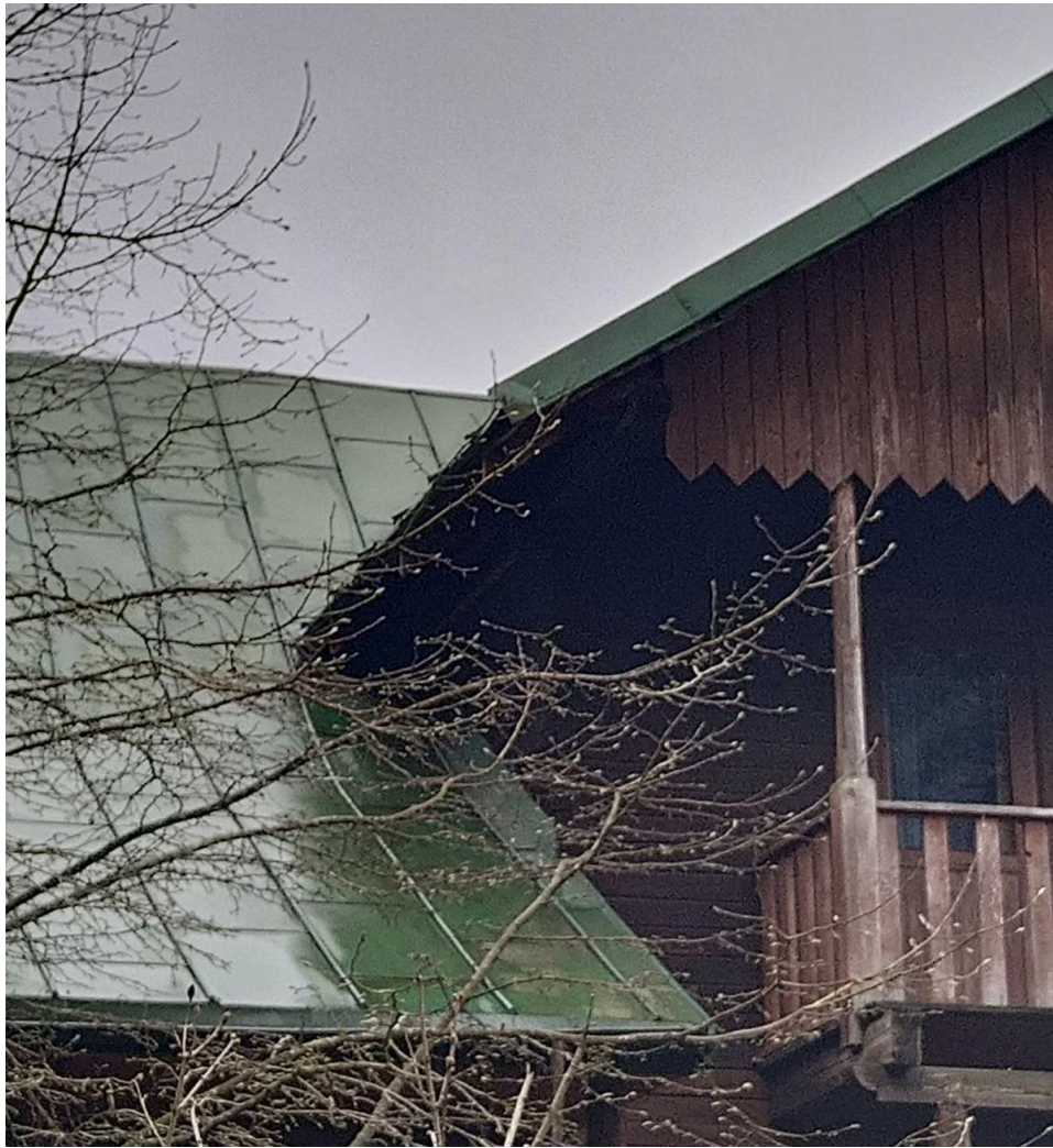
Fot. 2 Budynek mieszkalny – uszkodzone rynny
