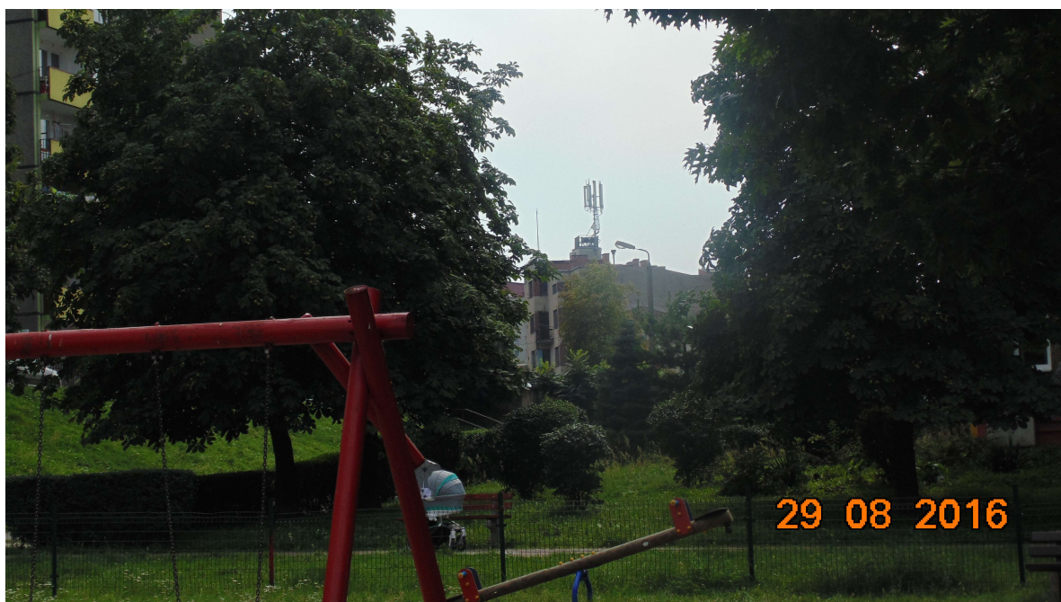
Fot. 3. Fragment instalacji radiokomunikacyjnej na budynku przy ul. Szpitalnej
