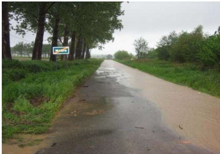
Fot. 10.1. Pobocze zawyżone oraz niedrożne rowy uniemożliwiają spływ wody z nawierzchni
