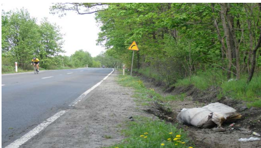
Fot. 10.2. Worki ze śmieciami wyrzucane do rowów utrudniają poprawne odwodnienie rowu
