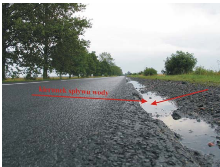
Fot. 11.1. Zatrzymanie spływającej z nawierzchni wody przy krawędzi jezdni przez źle wyprofilowane pobocze
