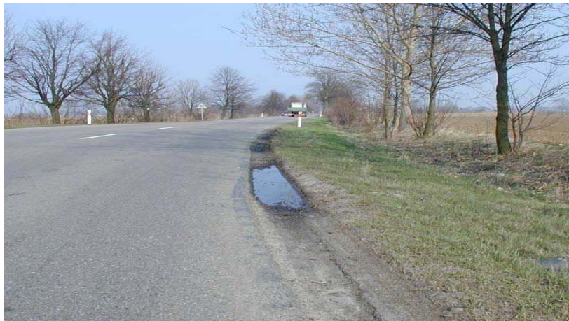
Fot. 10.3. Brak systematycznego utrzymania stanu poboczy
