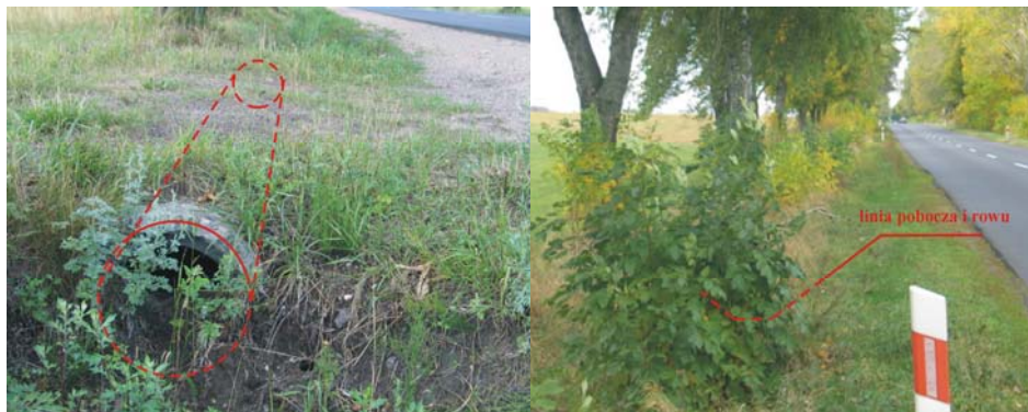
Fot. 11.4. Brak systematycznego utrzymania rowów i urządzeń odwadniających powoduje poważne zakłócenia w prawidłowym odwodnieniu nawierzchni
