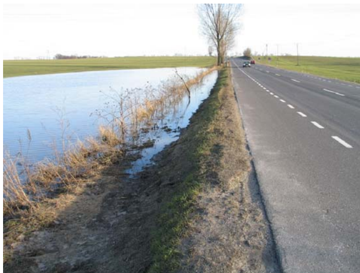
Fot. 11.5. Droga w terenie pagórkowatym z „zamkniętym” przez korpus drogi spływem wody do niższego punktu zlewni po drugiej stronie drogi
