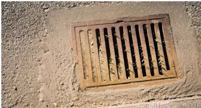
Fot. 11.6. Niedrożny wpust deszczowy
