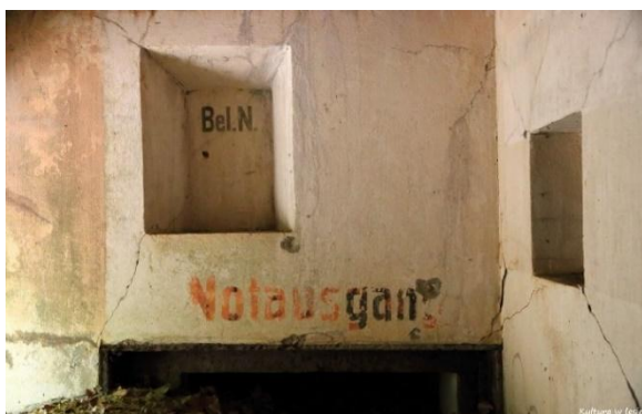
Fotografia 15 Napisy eksploatacyjne w niszy na oświetlenie i nad wyjściem ewakuacyjnym w schronie bojowym Ru.6, leśnictwo Złotowo, oddział 284
