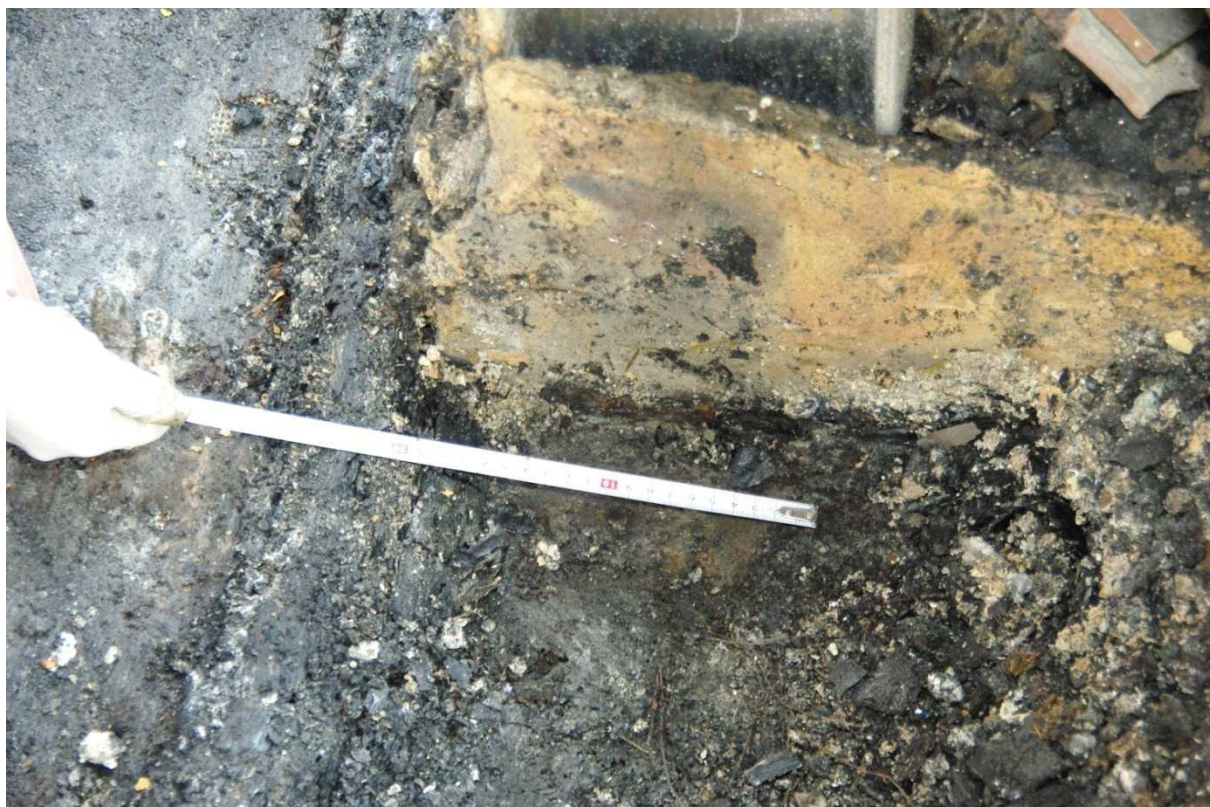
Fot. 7. Wypalenie wykładziny. Źródło: KMP Kamień Pomorski.
