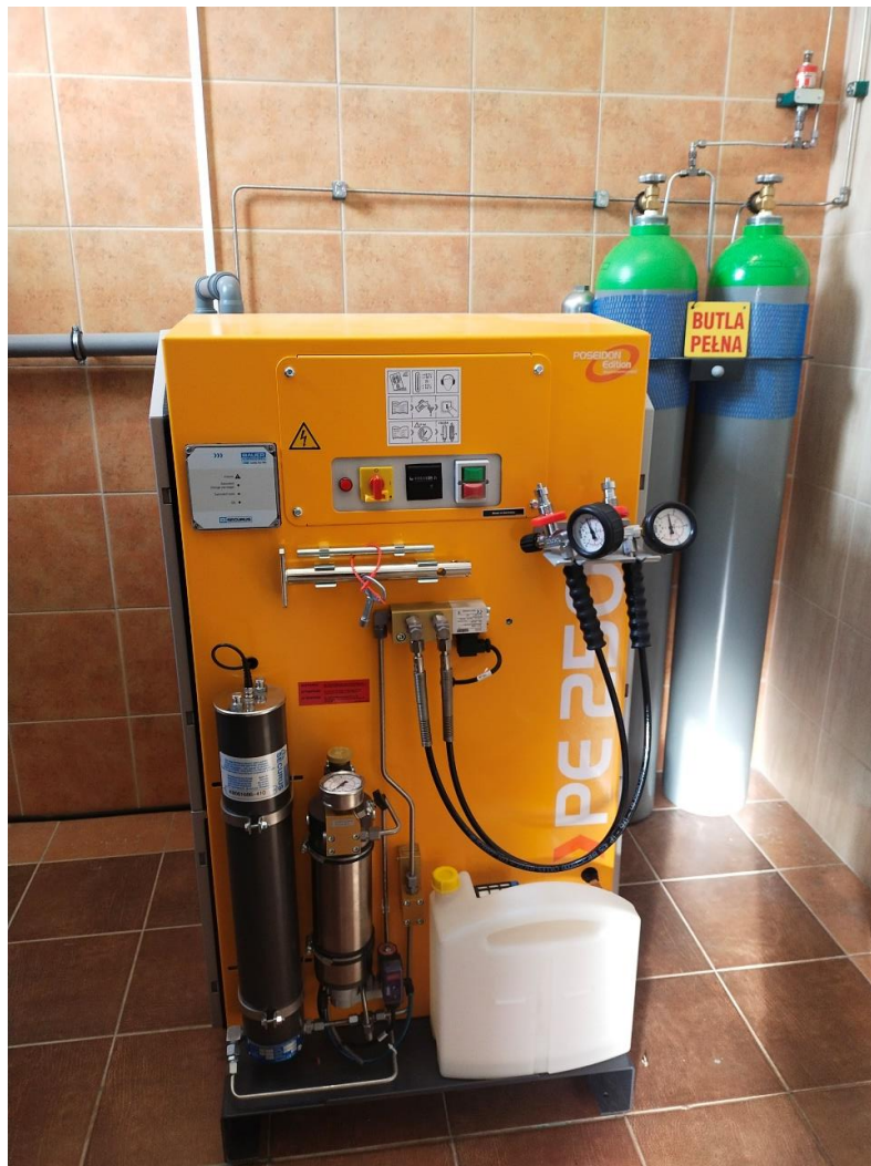
Zdjęcie – Sprężarka powietrzna
