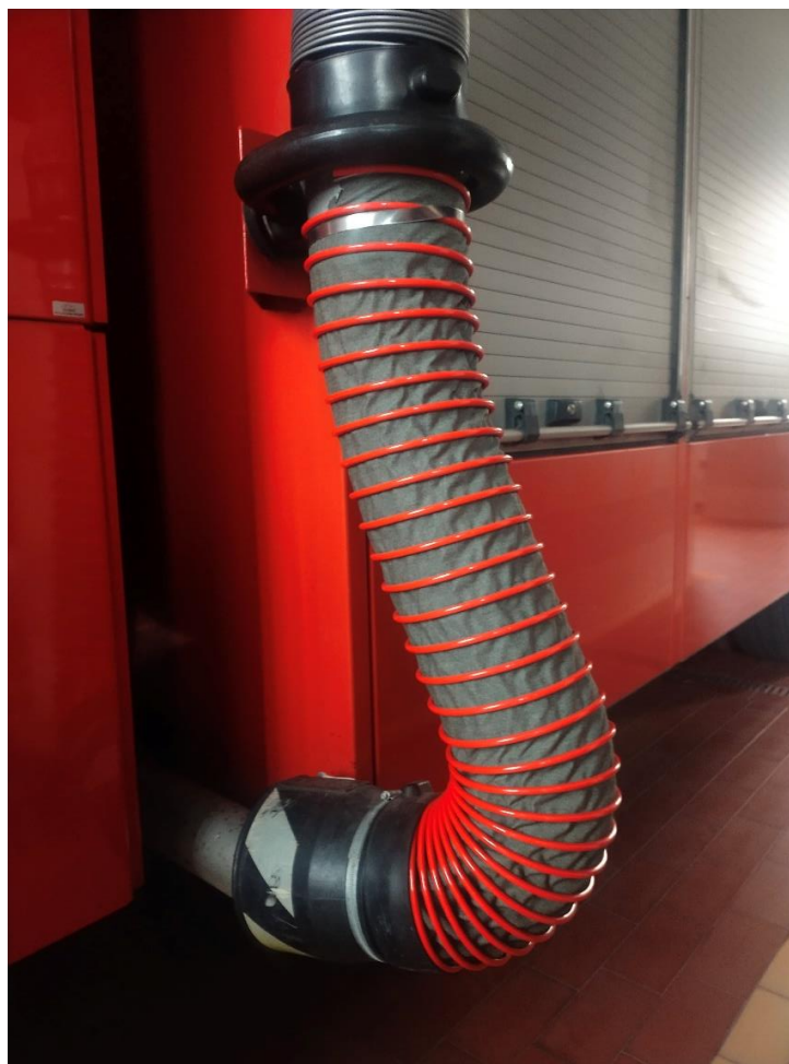
Zdjęcie – Wymienione elementy systemu odsysania spalin
