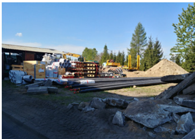
Dzięki inwestycji działdowskiego Przedsiębiorstwa Ciepłowniczego ok. 70% energii produkowanej w całym systemie ciepłowniczym w Działdowie będzie pochodzić z ciepłowni biomasowej (fot. PC Sp. z o.o. w Działdowie)
