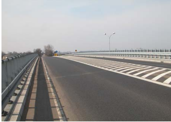
Rys. 8.1. Prawidłowo ukształtowane pochylenia na obiekcie mostowym
