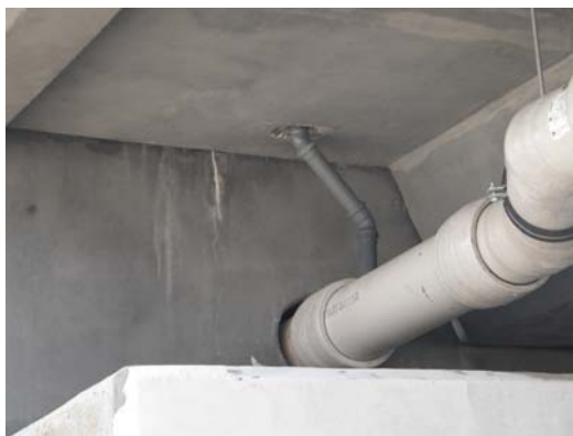
Rys. 8.18. Odprowadzenie wody z sączka do przewodu zbiorczego. Widoczny przeciek przez nieprawidłowo doklejone zakończenie hydroizolacji przy urządzeniu dylatacyjnym
