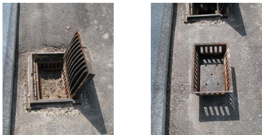
Rys. 8.8. Nieprawidłowy osadnik zanieczyszczeń wykonany w postaci odlewu, ograniczający możliwość przelewu wody przez wpust
