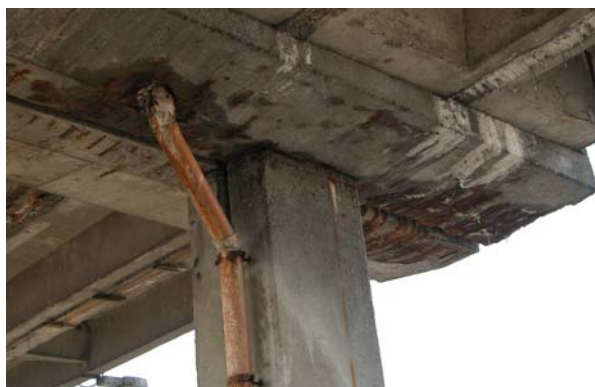
Rys. 8.7. Przepięki wody na obwodzie wpustu mostowego od spodu płyty
