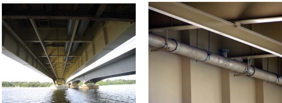
Rys. 6.9. Przewody zbiorcze umieszczone za pierwszym dźwigarem
