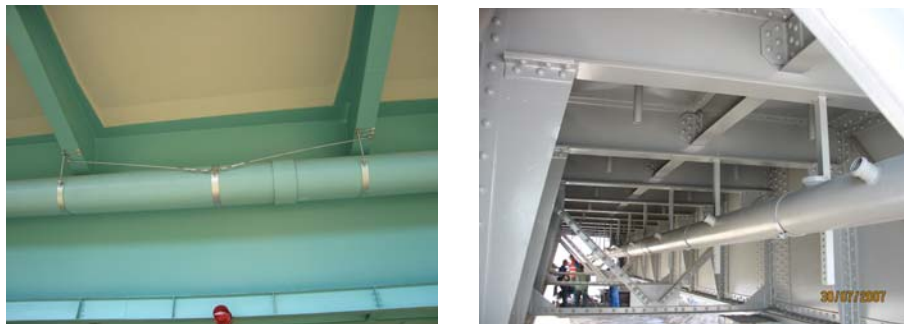
Rys. 6.10. Kolorystyczne dopasowanie przewodów zbiorczych do konstrukcji obiektu
