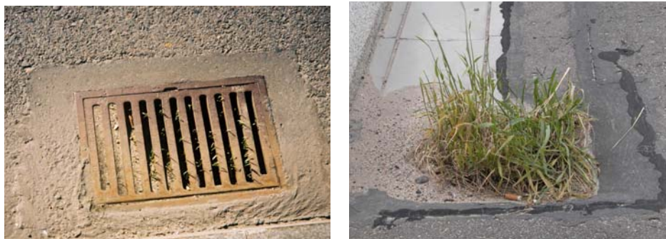
Rys. 8.6. Niedrożne wpusty mostowe
