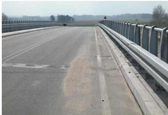
Rys. 8.2. Piasek zbierający się w linii ścieku na skutek złego wyprofilowania przeciwspadku przy krawężniku
