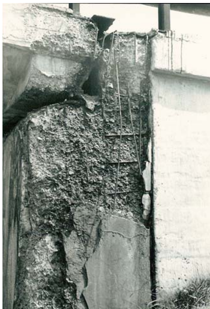
Rys. 8.21. Skutki niewłaściwego odwodnienia obiektu mostowego w strefie dylatacji
