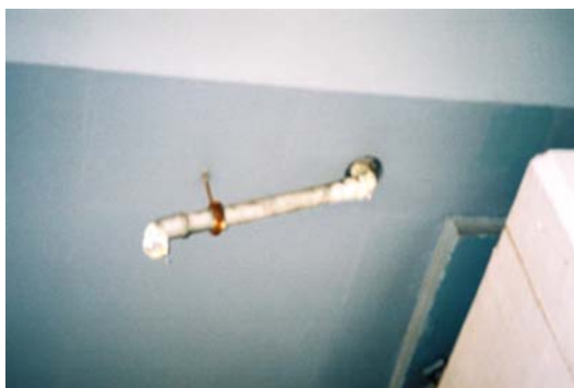
Rys. 8.11. Sączek wypełniony produktami korozji
