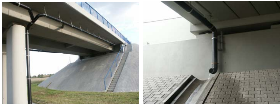
Rys. 3.3. Instalacje odprowadzające wykonane z polietylenu o wysokiej gęstości (PEHD)
