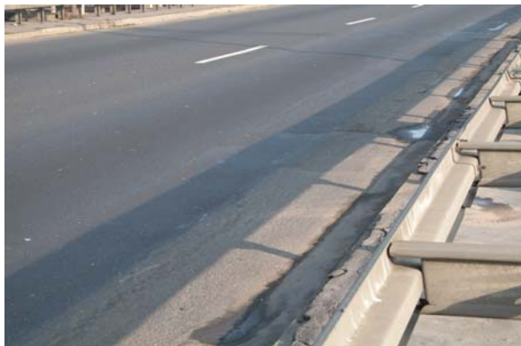
Rys. 8.3. Zdeformowana nawierzchnia – widoczne koleiny przy krawężniku
