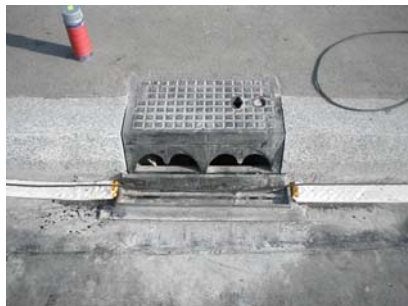
Rys. 6.5 Prawidłowo wykonany wpust krawężnikowy
