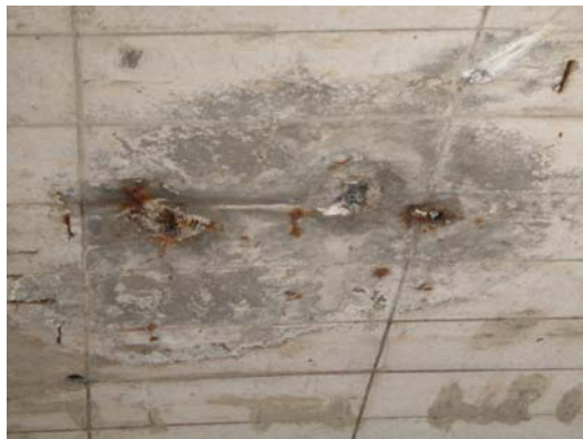
Rys. 8.10. Całkowicie skorodowane rurki sączków. Widok od spodu płyty
