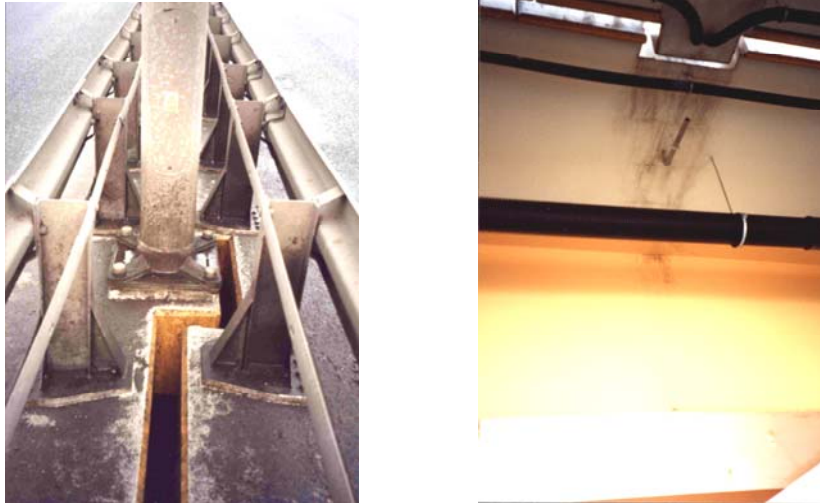
Rys. 8.16. Skutki braku ciągłości kapinosa
