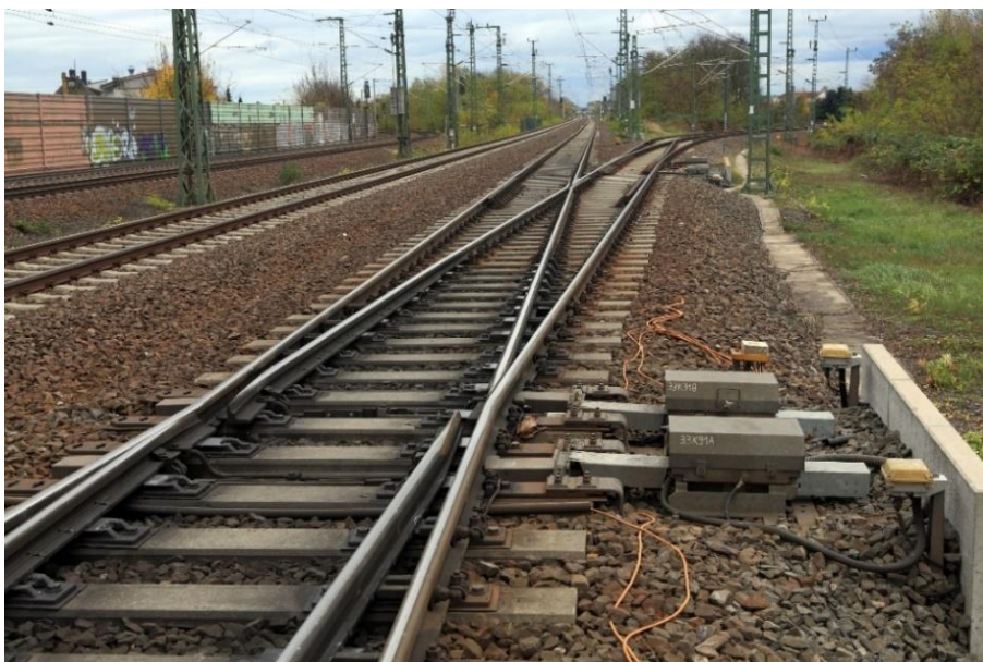
Rys. 7.2.5.1. Rozwiązanie „A” – skrzyżowanie torów z ruchomymi iglicami zamiast krzyżownic podwójnych [Fot. Falk2, de.wikipedia.org, dostępne na licencji Creative Commons, 2014]
