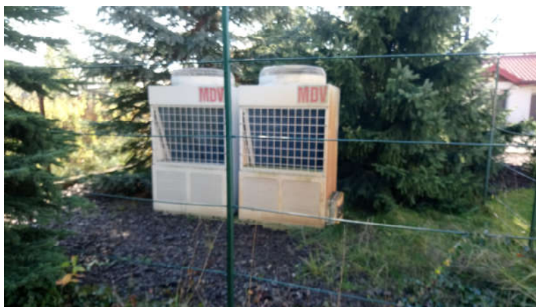
Fot. 2: Klimatyzacja – jednostka zewnętrzna
