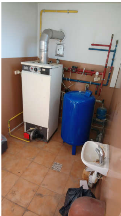
Fot. 1: Wnętrze kotłowni z widocznym kotłem i zbiornikiem hydroforowym
