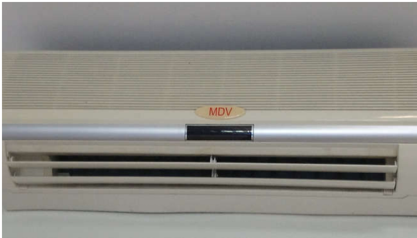
Fot. 3: Klimatyzacja – jednostka wewnętrzna ścienna
