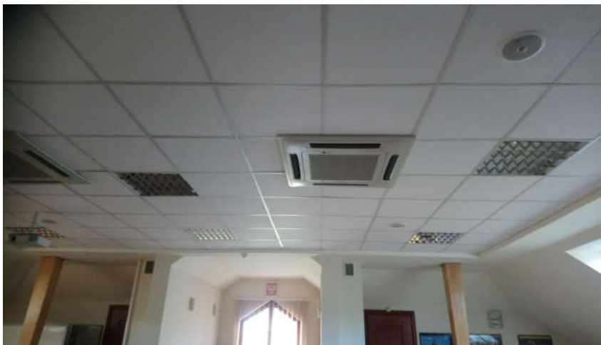
Fot. 4: Sufit systemowy nad salą narad z widocznymi jednostkami klimatyzacyjnymi sufitowymi oraz oprawami oświetleniowymi 4x18W
