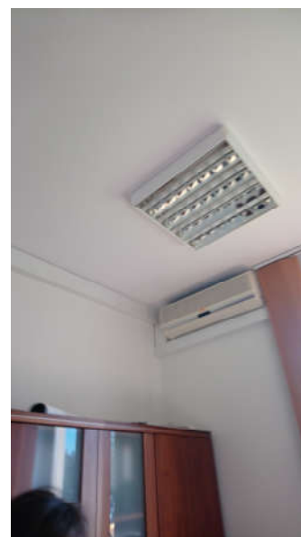
Fot. 6: Jednostka ścienna klimatyzacji oraz oprawa 4x18W
