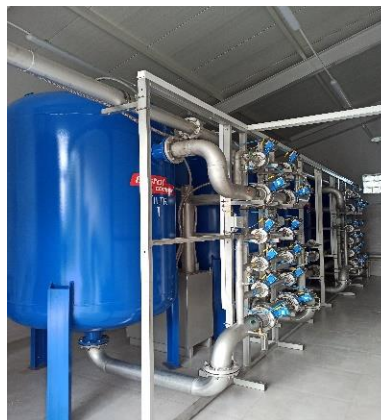
Zdjęcie 2) System filtrów uzdatniających wodę
