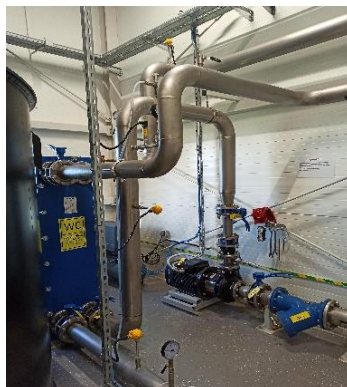
Zdjęcie 2) Urządzenia uzdatniające wodę termalną
