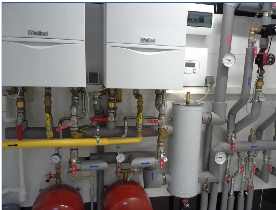
fot. 1 Zagórski systemy grzewcze: instalacja centralnego ogrzewania
