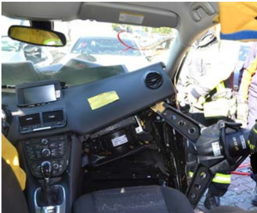
Rys. 203. Wypychanie deski rozdzielczej przy pomocy rozpieracza. Z progu pojazdu muszą być zdjęte lub odchylone gumowe i/lub plastikowe elementy, aby zapobiec wyskoczeniu rozpieracza
