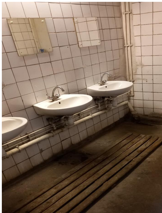
Niewłaściwy stan higieniczny pomieszczenia umywalni dla pracowników-
