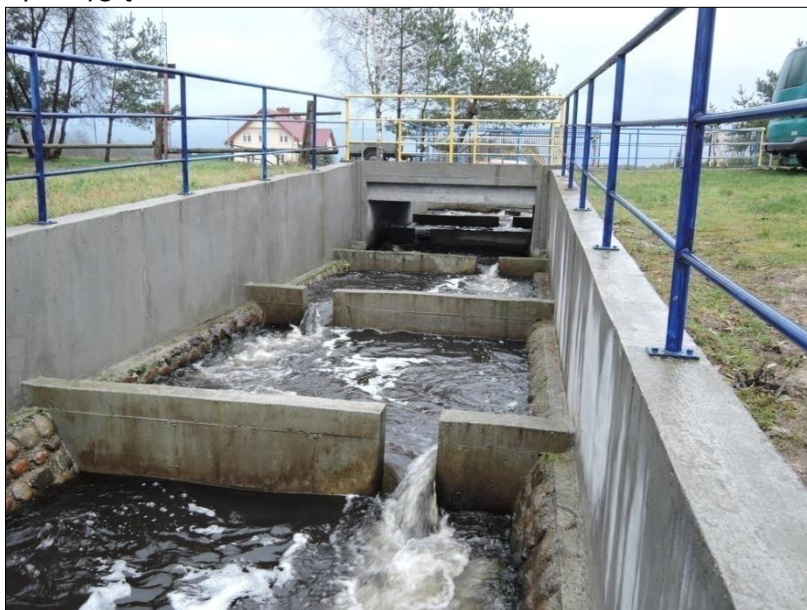
Ryc. 23. Przepławka typu bystrze przy MEW w Rzesznikowie - szczeliny znajdują się w ściankach naprzemian i
