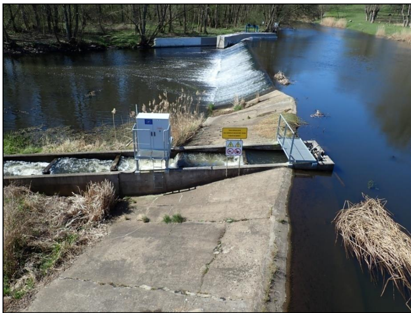
Ryc. 6. Stacja do automatycznego monitoringu przechodzących ryb przez przepławkę w Płotach - podwodne urządzenia rejestrujące zamontowano w pierwszej komorze na górnym stanowisku
