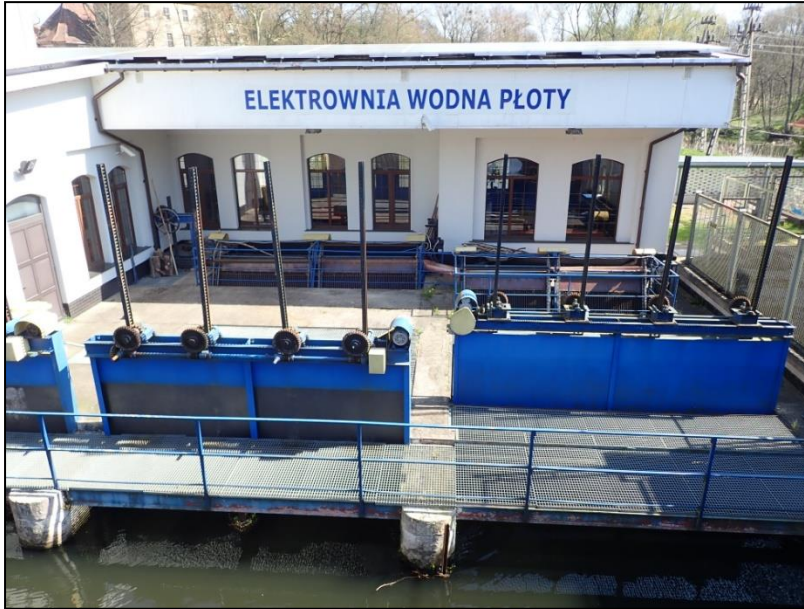
Ryc. 83. Wlot na turbiny Elektrowni Wodnej w Płotach jest chroniony barierą elektryczno-elektroniczną ograniczającym straty tanie Regi
