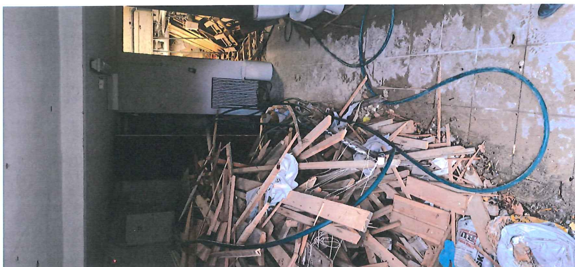
Składowanie materiałów palnych w pomieszczeniach technicznych, piwnica:
