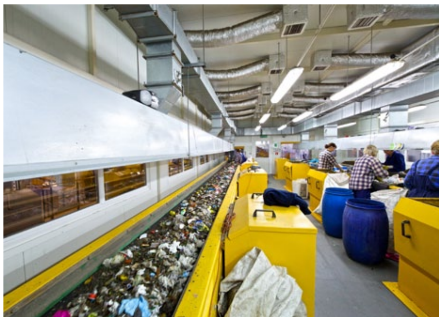
Zakład Unieszkodliwiania Odpadów Komunalnych „Orli Staw” (kabina sortownicza) wybudowany w 2006 r., współfinansowany ze środków ISPA/FS. Obecnie nowy projekt w zakresie modernizacji ZUOK jako Regionalnego Centrum Recyklingu jest w ocenie merytorycznej NFOŚiGW. Koszt całkowity inwestycji: 96 mln zł, a dotacja z POIiŚ 2014–2020 (działanie 2.2): 53 mln zł. Zakończenie planowane na październik 2022 r.
