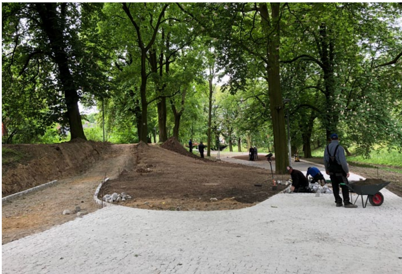
Budowa kościańskiego traktu rekreacyjnego (etap VI). Koszt całkowity inwestycji: ok. 3,4 mln zł, a dotacja z POIiŚ 2014-2020 (działanie 2.5): blisko 3 mln zł. Zakończenie projektu planowane pod koniec 2018 r.
