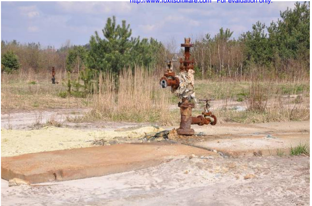
Fot. 5. Trudno uznać to za staranny demontaż i jakąkolwiek rekultywację.
