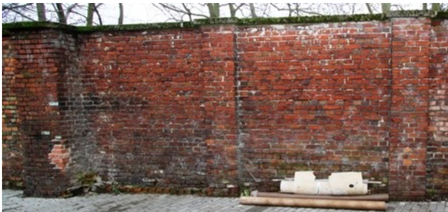
Nakrywa cementowa na szczycie ogrodzenia jest skorodowana posiada liczne ubytki materiału.
