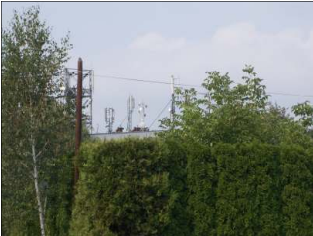
Fot. 3. Fragment instalacji radiokomunikacyjnej na dachu hotelu przy ul. Łukowej
