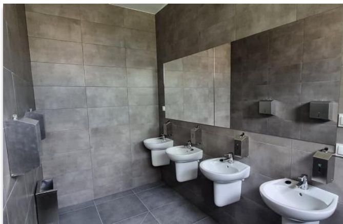
Rys. 6. Pomieszczenie sanitarne Zespołu Szkół Technicznych w Pleszewie
