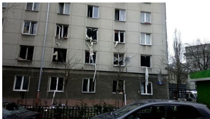
Zniszczenia po wybuchu gazu przy ul. Śliskiej – fot. www.warszawa.naszemiasto.pl
