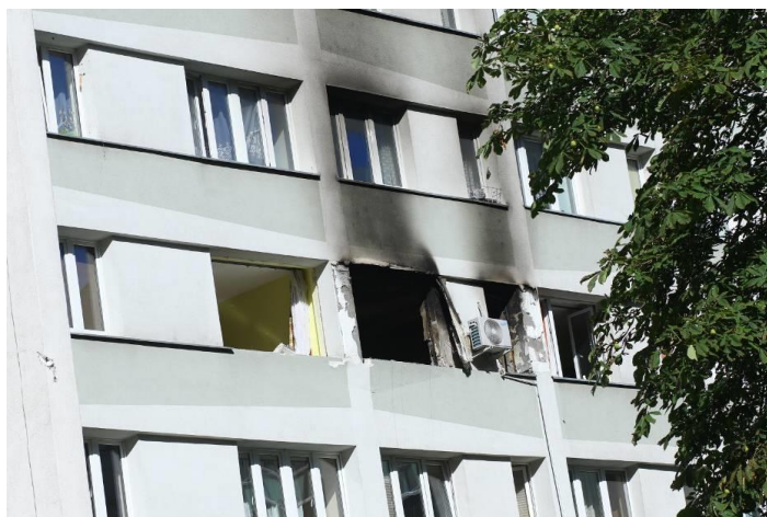
Zniszczenia budynku po wybuchu gazu przy ul. Noakowskiego – fot. www.warszawa.tvp.pl
