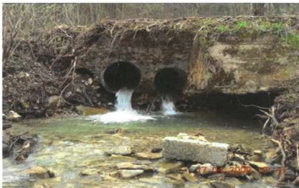
Zdjęcie nr 2a. Wysoki próg przy wylocie przepustu w km 0+127 - widok po powodzi 2009 r.
