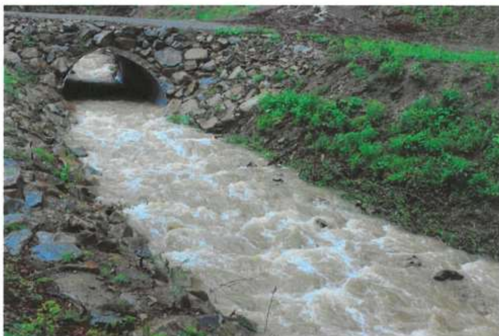
Zdjęcie nr 9b. Wylot przepustu w km 1+440 po przebudowie - widok po powodzi maj 2014r.
