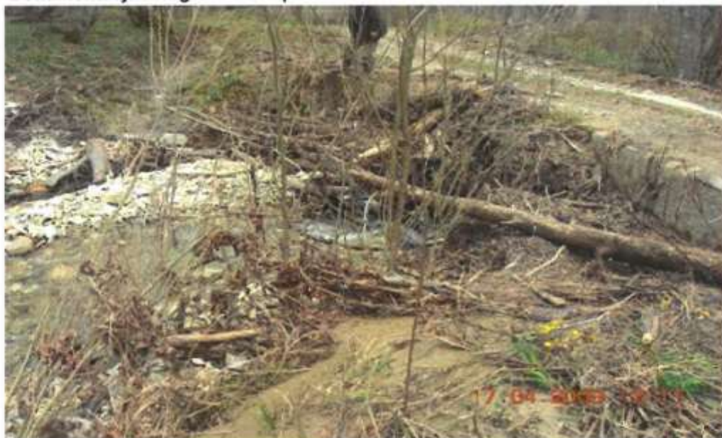
Zdjęcie nr 1a. Zamulony wlot przepustu w km 0+127 warstwą mułu przekraczającą 2 m - widok po powodzi 2009 r.
