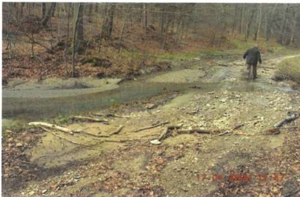
Zdjęcie nr 8a. Zamulony wlot przepustu w km 1+440 warstwą mułu o grubości przekraczającej 3 m – widok po powodzi 2009r.
