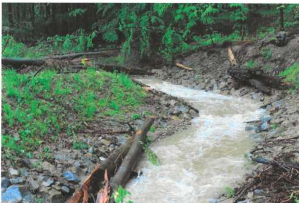
Zdjęcie nr 10b. Bystrze w miejscu stopnia betonowego w km 1+458 - widok po powodzi maj 2014r.
