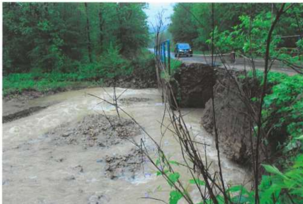
Zdjęcie nr 1. Silnie uszkodzona droga powiatowa Makowa – Arłamów (przez potok Turnica).
