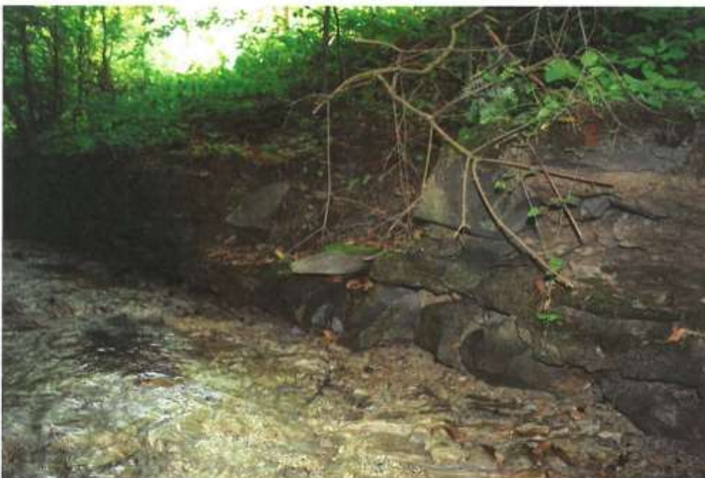
Zdjęcie nr 7a. Uszkodzony mur oporowy z lat 70-tych na zaprawie cementowej w km 1+231 – widok po powodzi 2009r.
