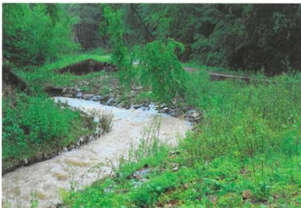
Zdjęcie nr 3b. Zabezpieczenie muru oporowego przy drodze leśnej w km 0+410 - widok po powodzi maj 2014r.
