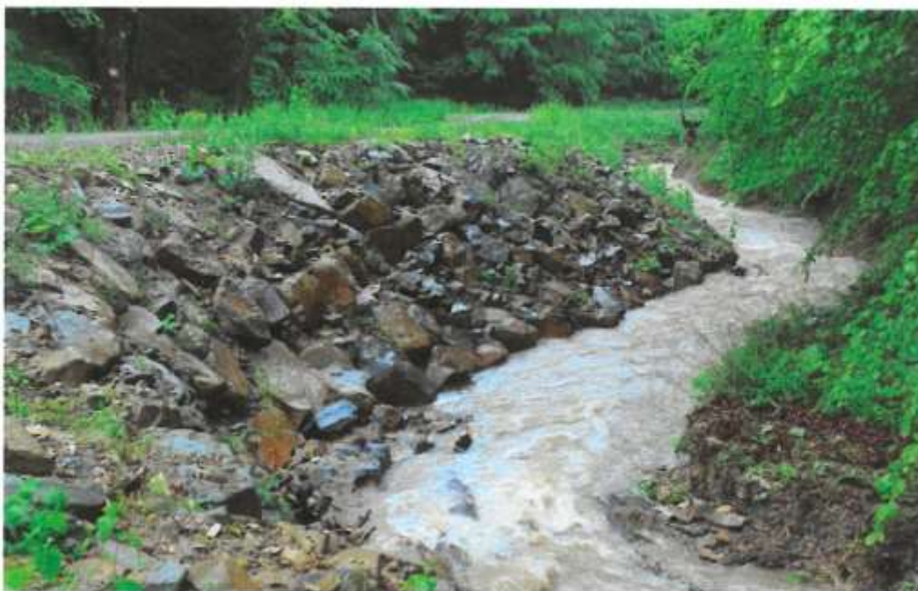
Zdjęcie nr 7b. Zabezpieczenie drogi narzutem kamiennym w miejsce uszkodzonego muru oporowego, powyżej przepustu w km 1+231 - widok po powodzi maj 2014r.
