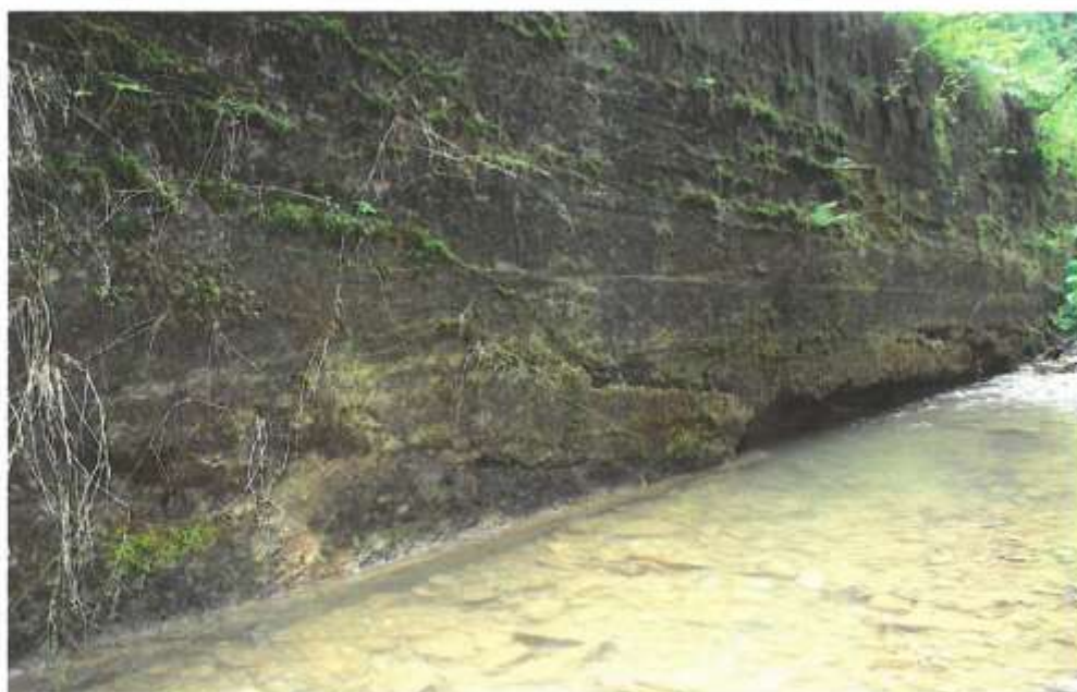
Zdjęcie nr 3a. Uszkodzony i podmyty mur oporowy w km 0+410 - widok po powodzi 2009 r.
