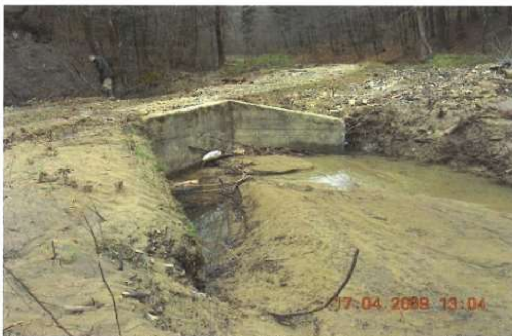
Zdjęcie nr 5a. Zamulony wlot przepustu w km 0+497 warstwą mułu ok. 2 m – widok po powodzi 2009r.
