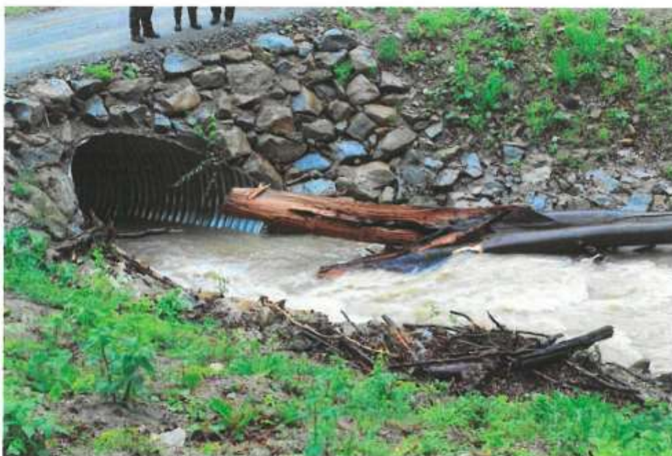
Zdjęcie nr 8b. Wlot przepustu w km 1+440 po przebudowie - widok po powodzi maj 2014r.
