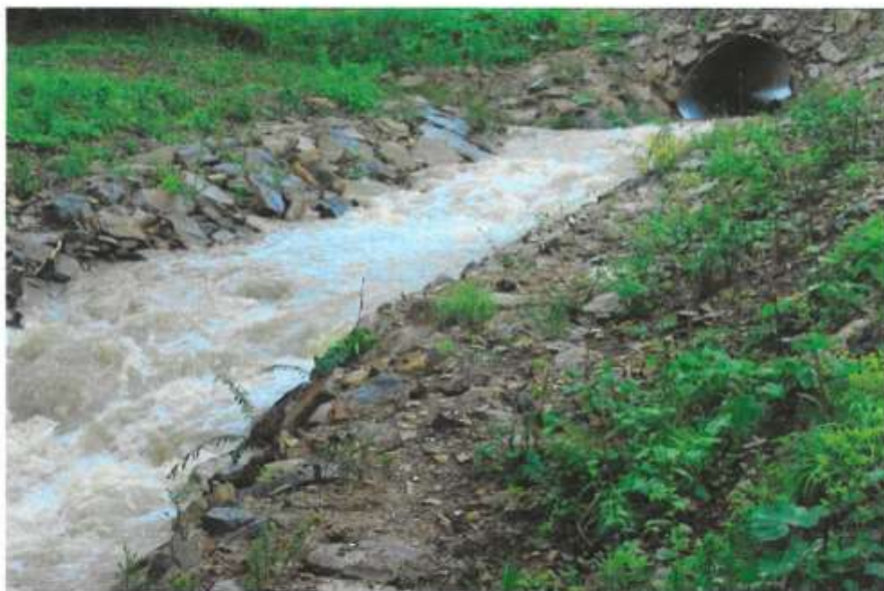
Zdjęcie nr 2b. Wylot przepustu w km 0+127 po przebudowie - widok po powodzi maj 2014r.
