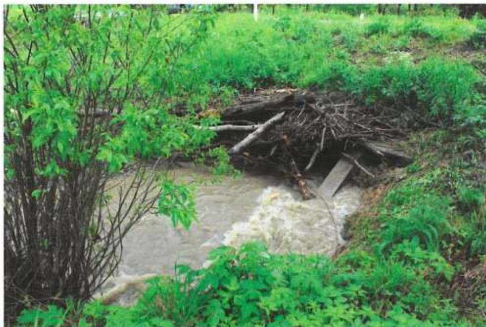
Zdjęcie nr 3. Zamulony wlot przepustu na potoku Wyrwa w ciągu drogi leśnej nr 2 Kwaszenina.
