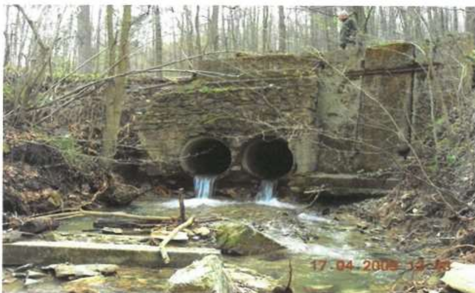
Zdjęcie nr 9a. Wylot przepustu w km 1+440 z wysokim progiem i uszkodzoną ścianką czołową oraz uszkodzonym nasypem drogi leśnej – widok po powodzi 2009r.
