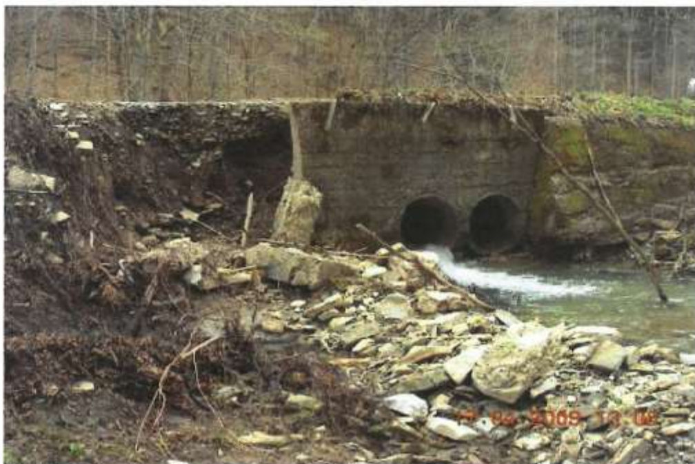
Zdjęcie nr 6a. Wysoki próg przy wylocie przepustu w km 0+497, uszkodzona ścianka czołowa i nasyp drogi leśnej – widok po powodzi 2009r.
