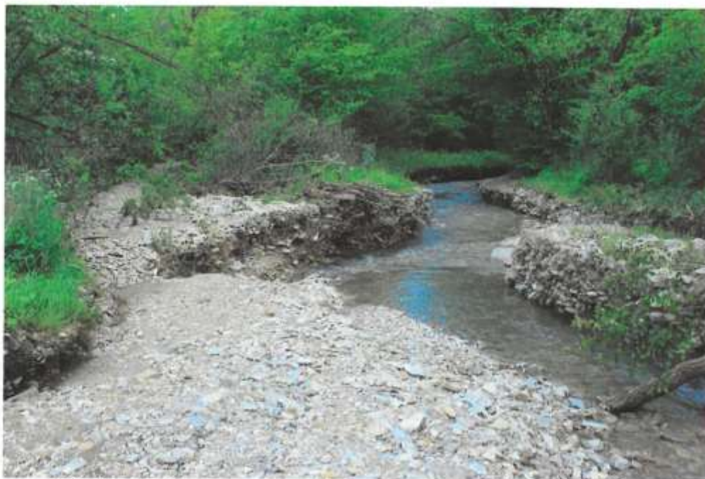
Zdjęcie nr 7. Zniszczona przez wody powodziowe droga dojazdowa do doliny Borysławki.
