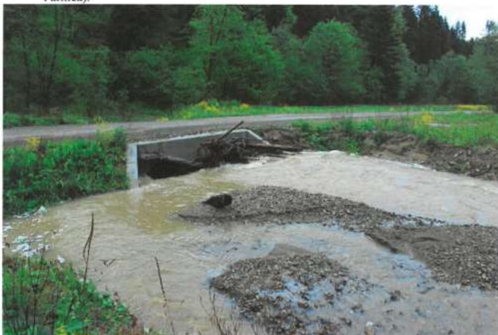
Zdjęcie nr 2. Zamulony wlot przepustu na potoku Paportniańskim w ciągu drogi leśnej Arłamów – Paportno.
