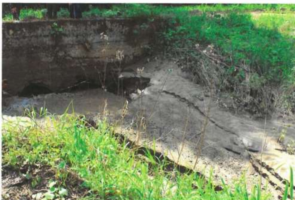
Zdjęcie nr 5. Przerwana ciągłość biologiczna potoku Tym - po zamuleniu przepustu potok popłynął rowem przydrożnym i drogą leśną.
