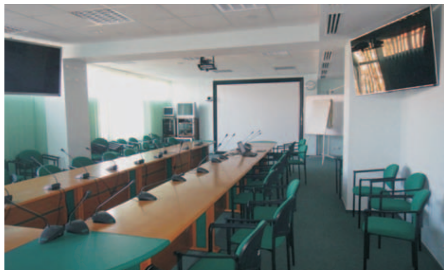
Sala zarządzania kryzysowego, na wprost ekran obrotowej ściany wizyjnej, na którym można projektować jeden duży obraz o wysokiej rozdzielczości
