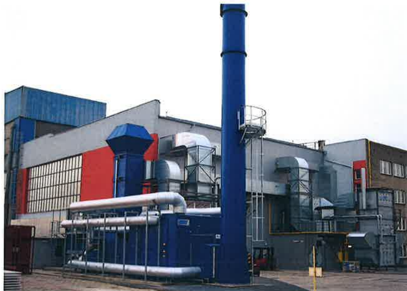
Zdjęcie nr 11.1 Malarnia wyposażona w instalację usuwającą lotne związki organiczne
