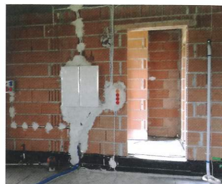
Ściana między garażem a przedpokojem powinna być ocieplona materiałem niepalnym, drzwi powinny mieć klasę EI 30
