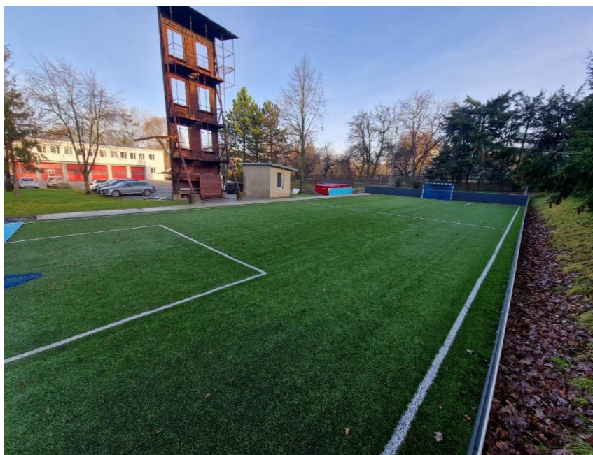
Zdjęcie 15. Przygotowanie i budowa nowego boiska wraz z zabezpieczeniem bandami, montażem oświetlenia oraz przygotowanie piłkochwyłów.
