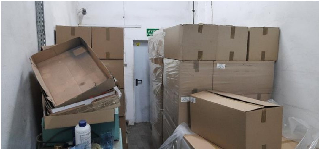
Zdjęcie 2. Składowanie materiałów palnych na drogach ewakuacyjnych.
