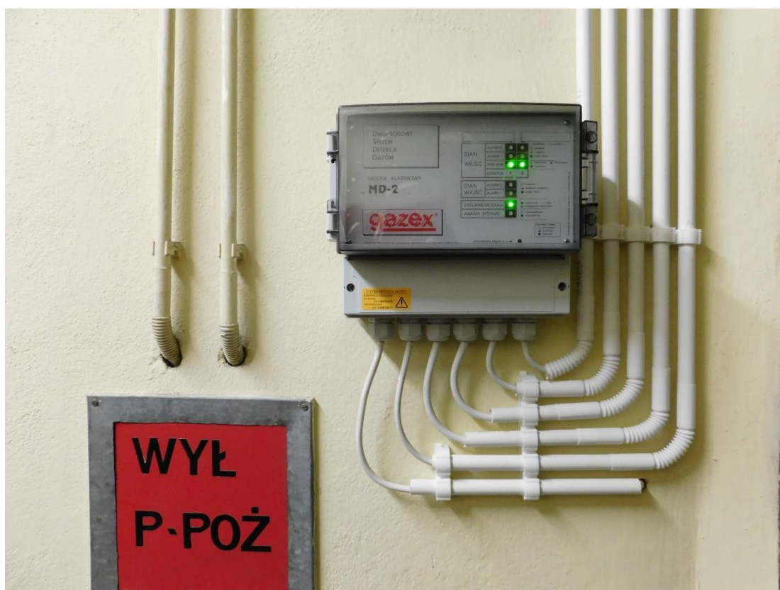
Zdjęcie 46. Instalacja detekcji gazu w pomieszczeniu kotłowni.
