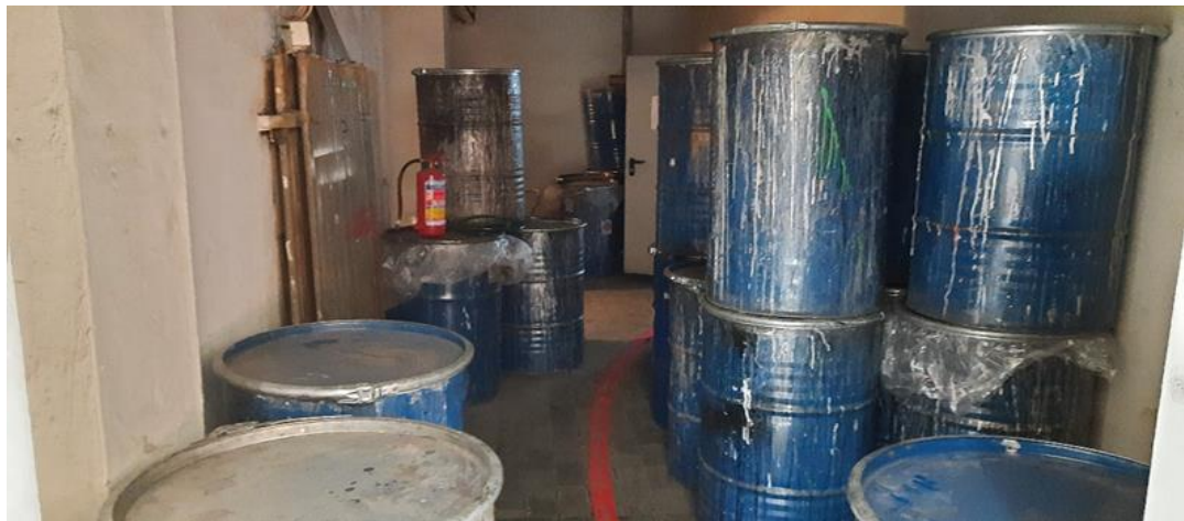
Zdjęcie 3. Składowanie materiałów palnych na drogach ewakuacyjnych.
