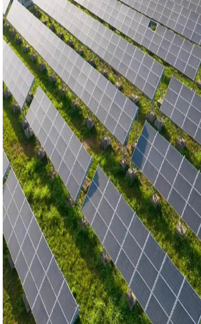
2 niezamontowane na budynkach (czyli wolnostojące) instalacje odnawialnych źródeł energii
