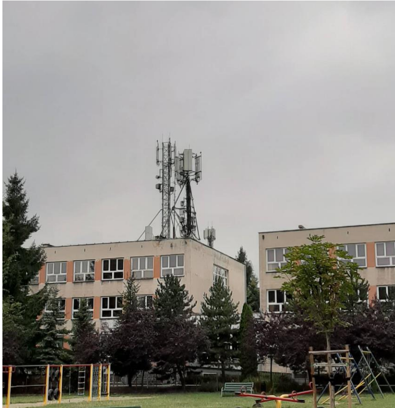
Fot. 1: Widok anten stacji bazowych: ID: KRA0080_F, ID: BT 20000, ID: 2695, zlokalizowanych pod adresem: Os. Dywizjonu 303 66, 31-875 Kraków
