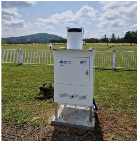
Kolektor opadu mokrego na stacji w Lesku
