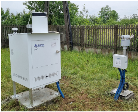
Kolektor opadu mokrego i deszczomierz na stacji w Gołuchowie
