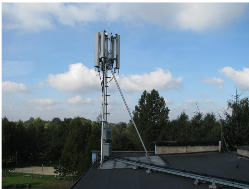
Fot. 5. Instalacja radiokomunikacyjna objęta pomiarami kontrolnymi – Jastrzębie Zdrój
