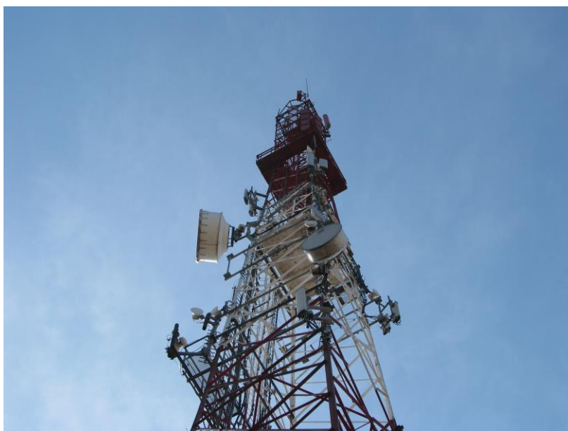
Fot. 2. Źródła PEM wysokiej częstotliwości – Telewizyjna Stacja Retransmisyjna Cieszyn
