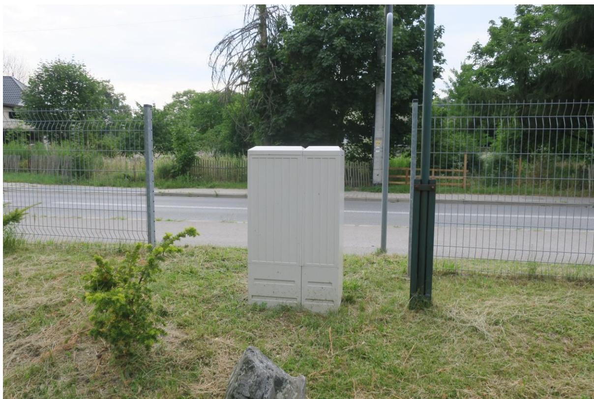
Fot. 1 – skrzynka elektryczna do obudowania ogrodzeniem panelowym ocynkowanym
