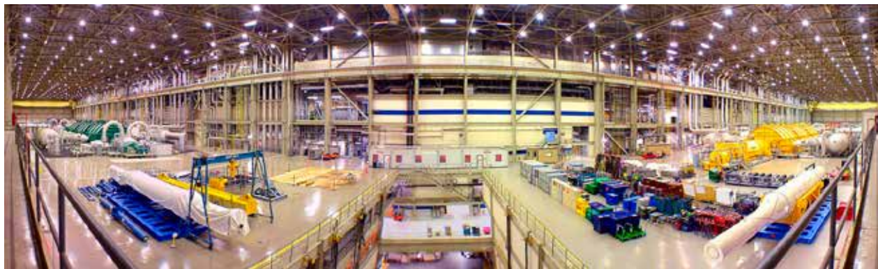
Fot. 2. Maszynownia elektrowni jądrowej Darlington (zezwoleń OPG 2007) Photo. 2. Darlington turbine hall (courtesy of OPG 2007)
