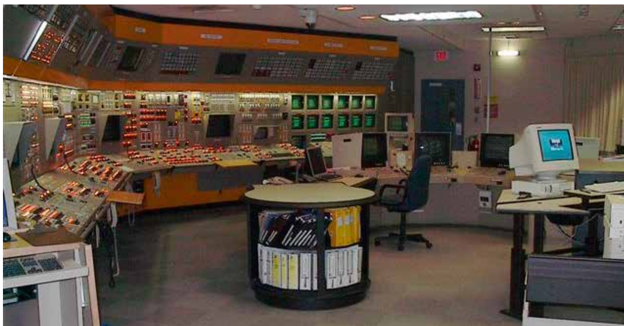
Fot. 3. Symulator nastawni bloku D2 (zezwoleń OPG 2007) Photo. 3. Darlington D2 Control Room simulator (courtesy of OPG 2007)
