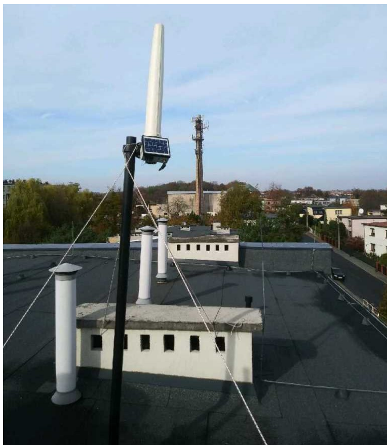
Rys. 3 Miejsce montażu SMS PEM – Szkoła Podstawowa nr 10 w Tarnobrzegu – widok na SBTk
