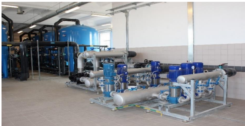
Stacja uzdatniania wody w Nisku
