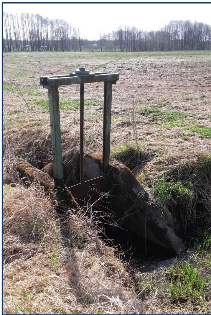
Rycina 14 Zastawka ze zdekompletowanym mechanizmem wyciągowym i rozmytą skarpgą za przyczółkiem – Kołaczkowo, woj. kujawsko-pomorskie (fot. B. Kierasiński)
