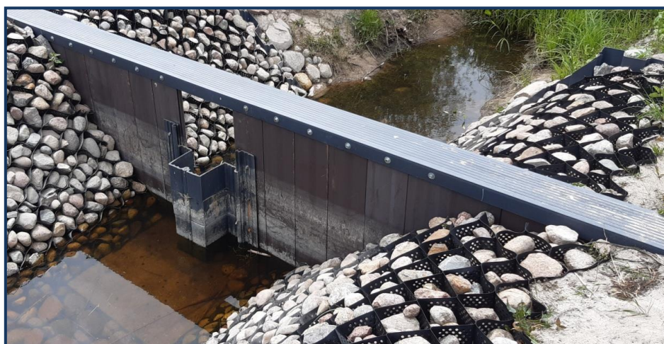
Rycina 8 Zastawka U-kształtna zainstalowana na obiekcie melioracyjnym Grabów nad Pilicą (woj. mazowieckie). Projekt INOMEL, autorzy projektu urządzenia: T. Szymczak, A. Kodura, M. Kubrak (ITP-PIB). Fot. B. Kierasiński
