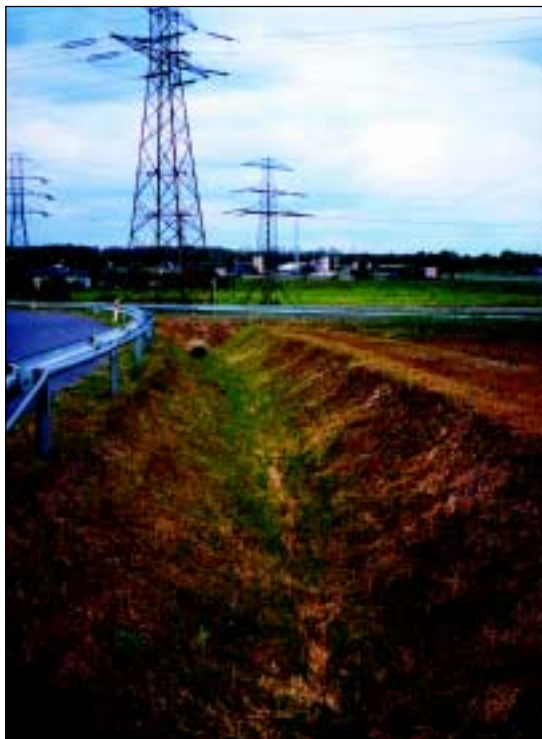
Fot. 1. Przyautostradowy rów odwadniający trawiasty (fot. H. Sawicka-Siarkiewicz)
