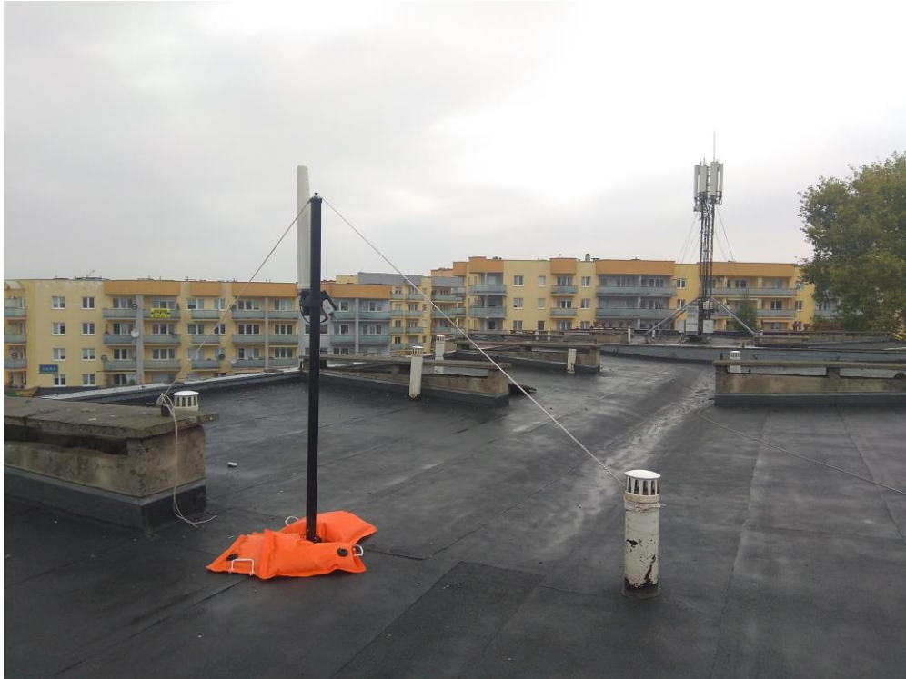
Rys. 2 Miejsce montażu pilotażowego SMS PEM – dach SP nr 20 w Gorzowie Wielkopolskim – widok na sąsiednie anteny SBTK
