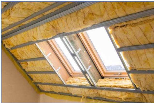
Pic. 2 domoweklimaty: mineral wool insulation
