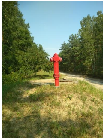
Fot. 6 Punkt czerpania wody - Rurociąg Wodociągu Północnego
