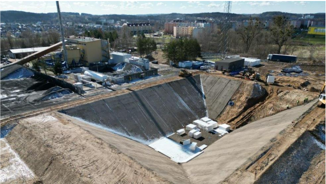
Rysunek 8. Wybudowany w ramach projektu NCBR pn. „Ciepłownia Przyszłości” w ciepłowni w Lidzbarku Warmińskim magazyn ciepła typu PTES (ang. Pit Thermal Energy Storage) o pojemności cieplnej ok. 1 GWh, na początkowym etapie budowy wiosną 2023 r. Na kolejnym etapie zainstalowane zostały wymienniki ciepła, a zbiornik został zaizolowany, uszczelniony i wypełniony wodą. Następnie zaś dla ograniczenia strat ciepła dodatkowo przykryto zbiornik od góry izolowaną pokrywą. Tak duży zbiornik, dobrze zaizolowany, prawie nie traci ciepła (w ciągu kilku zimowych tygodni straty ciepła są na poziomie kilku procent). Zdjęcie Euros Energy.
