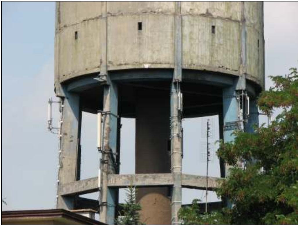
Fot. 3. Fragment instalacji radiokomunikacyjnej na wieży ciśień
