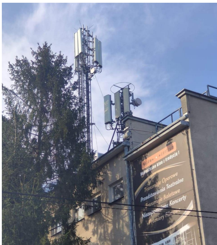
Fot. 1: Widok anten stacji bazowych: ID: 51658, ID: KRA0242_A, zlokalizowanych pod adresem: ul. Pychowicka 7, 30-364 Kraków
