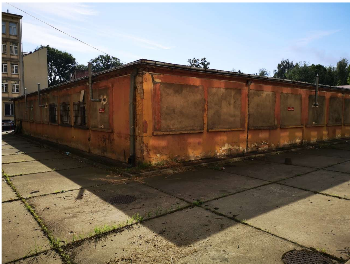
Fot.16 teren za budynkiem, zdegradowane elementy nawierzchni, uskoki pomiędzy płytami, budynek po Archiwum Narodowym planowany do rozbiórki.
