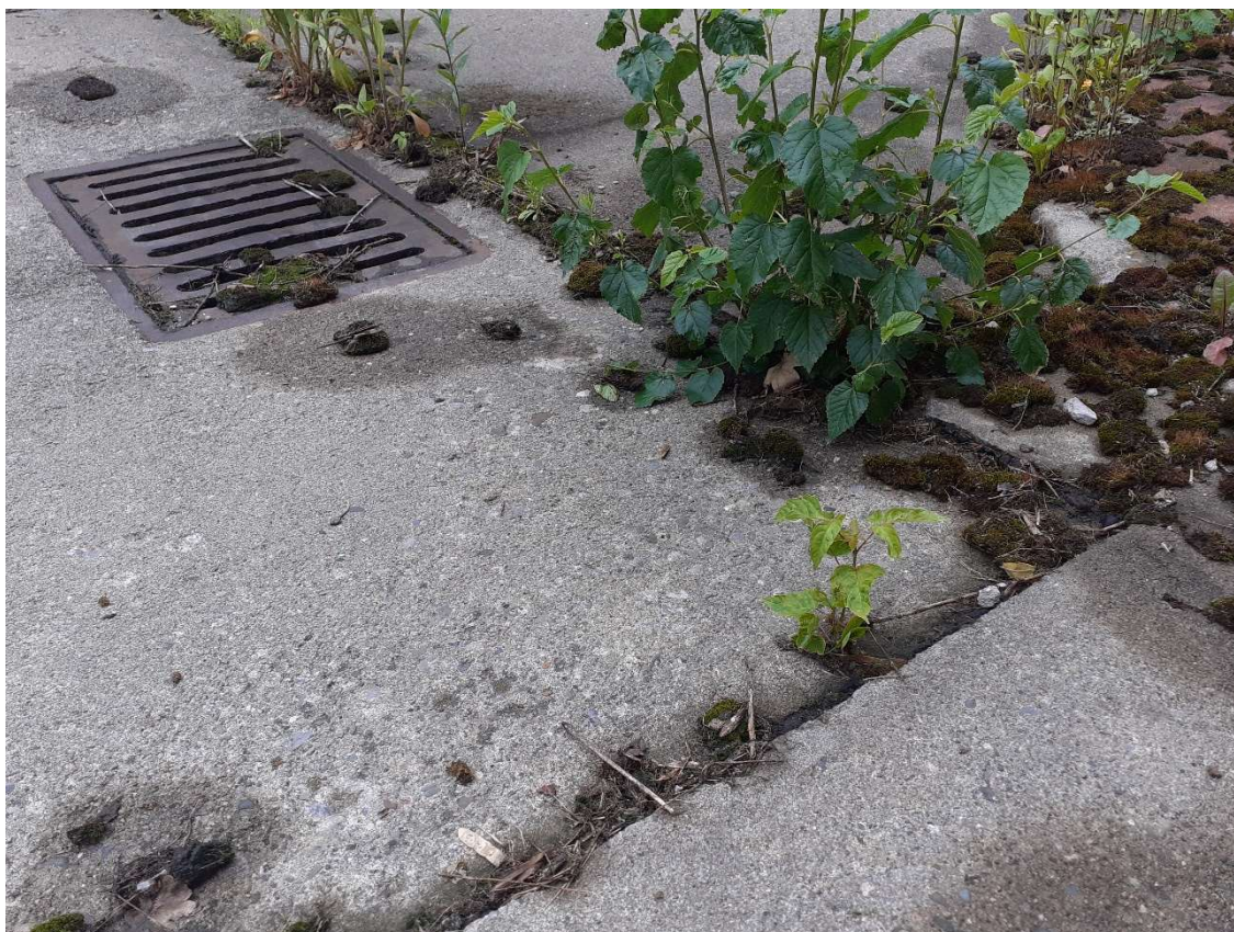
Fot.37 teren za budynkiem, zdegradowana nawierzchnia, uskoki pomiędzy płytami.
