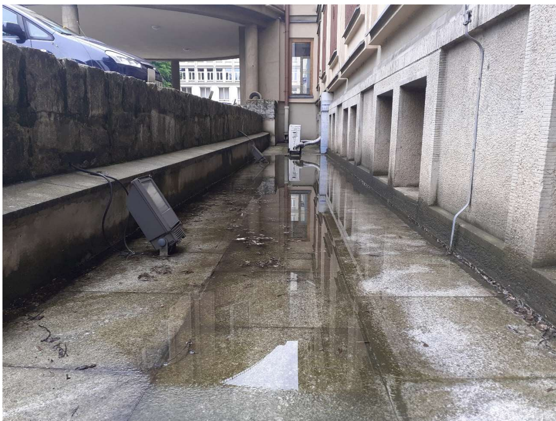
Fot.62 teren przed budynkiem, brak odpowiedniego odwodnienia – zastoiska wody przed budynkiem, podczas obfitych deszczy poziom wody dochodzi do okien i zalewa wnętrze budynku.
