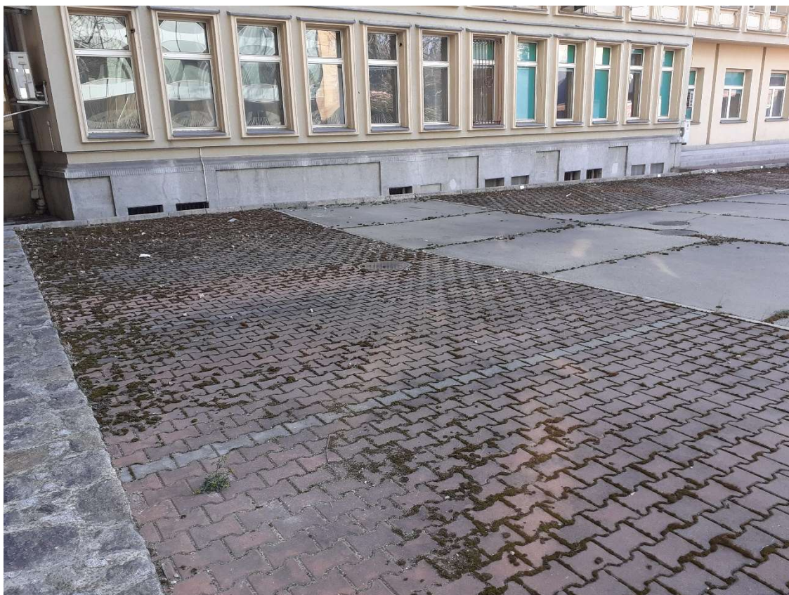
Fot.58 teren za budynkiem, zdegradowana nawierzchnia, murki terenowe, uskoki pomiędzy płytami.
