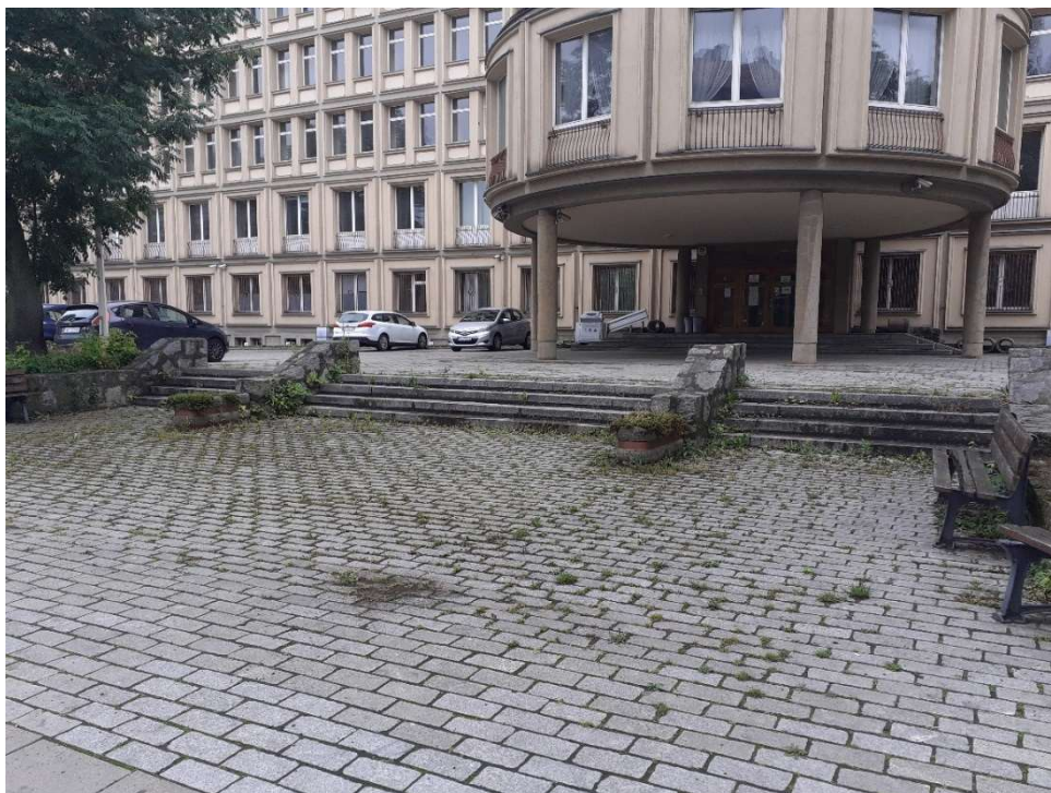
Fot.1 teren przed schodami i schody główne z nierównościami, brak odwodnienia, widoczne nierówności ze śladami po kałużach i zastoiskach wody.
