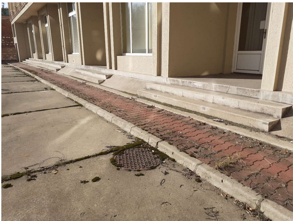
Fot.13 teren za budynkiem, zdegradowane elementy nawierzchni, brak odpowiedniego odwodnienia.
