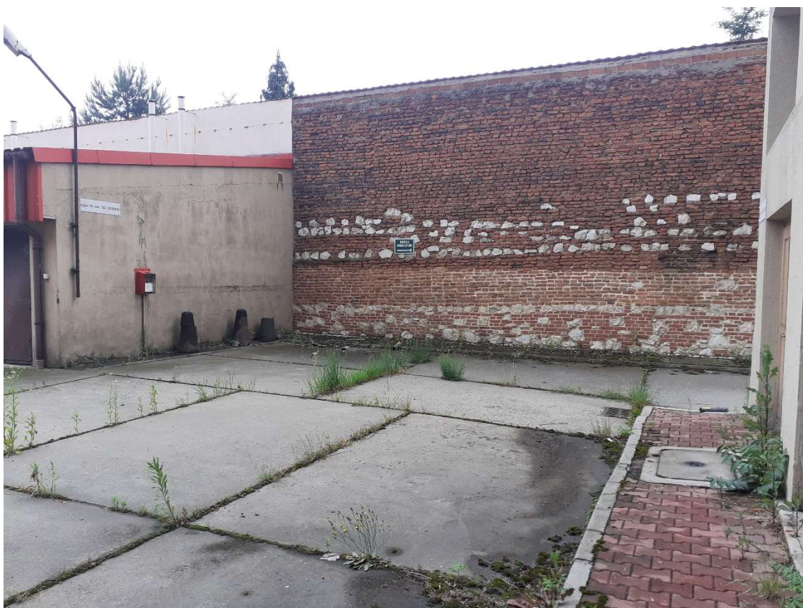
Fot.32 teren za budynkiem, zdegradowana nawierzchnia, uskoki pomiędzy płytami, brak odpowiedniego odwodnienia terenu.
