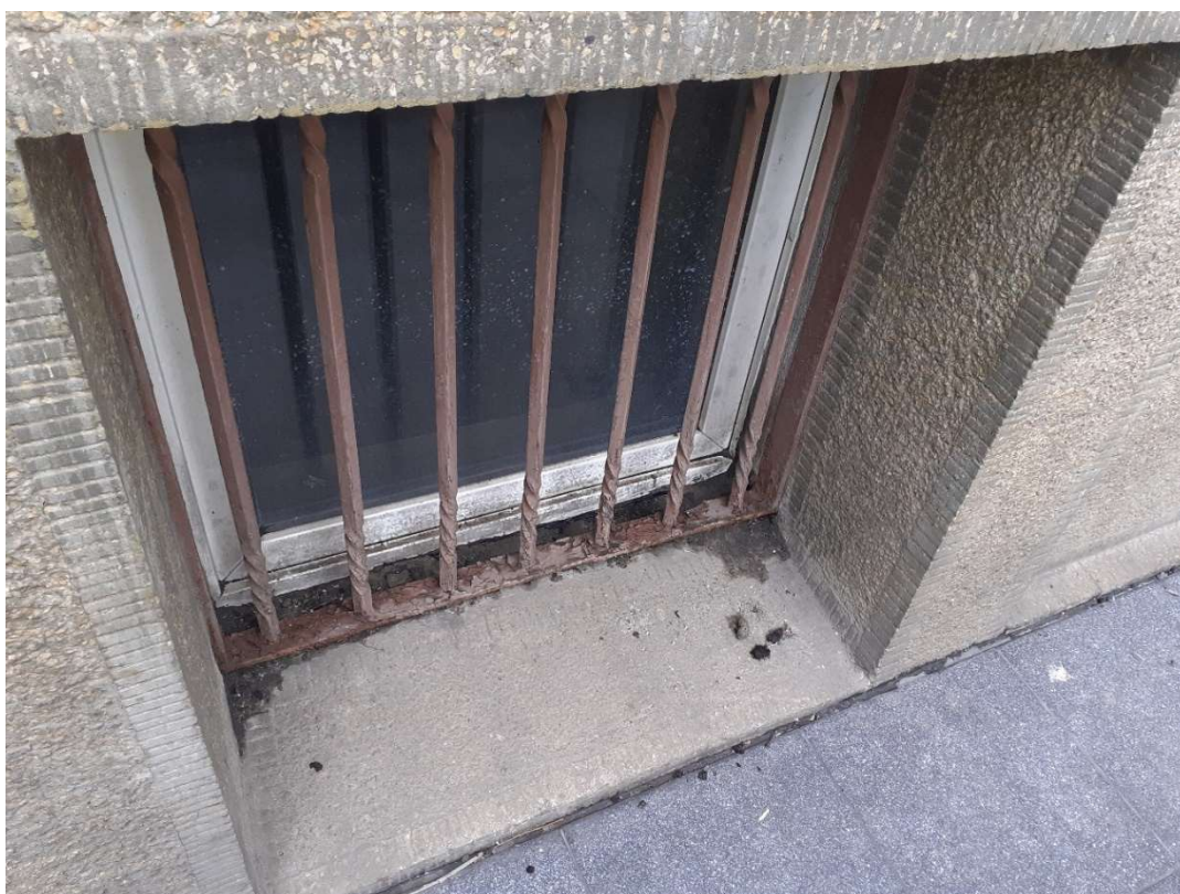
Fot.53 teren za budynkiem, zdegradowana nawierzchnia, brak odpowiedniego odwodnienia – poziom wody przy obfitych opadach dochodzi do okien i zalewa wnętrze budynku – przy oknach widoczne ślady po wodzie deszczowej, która zalewa wnętrze budynku.
