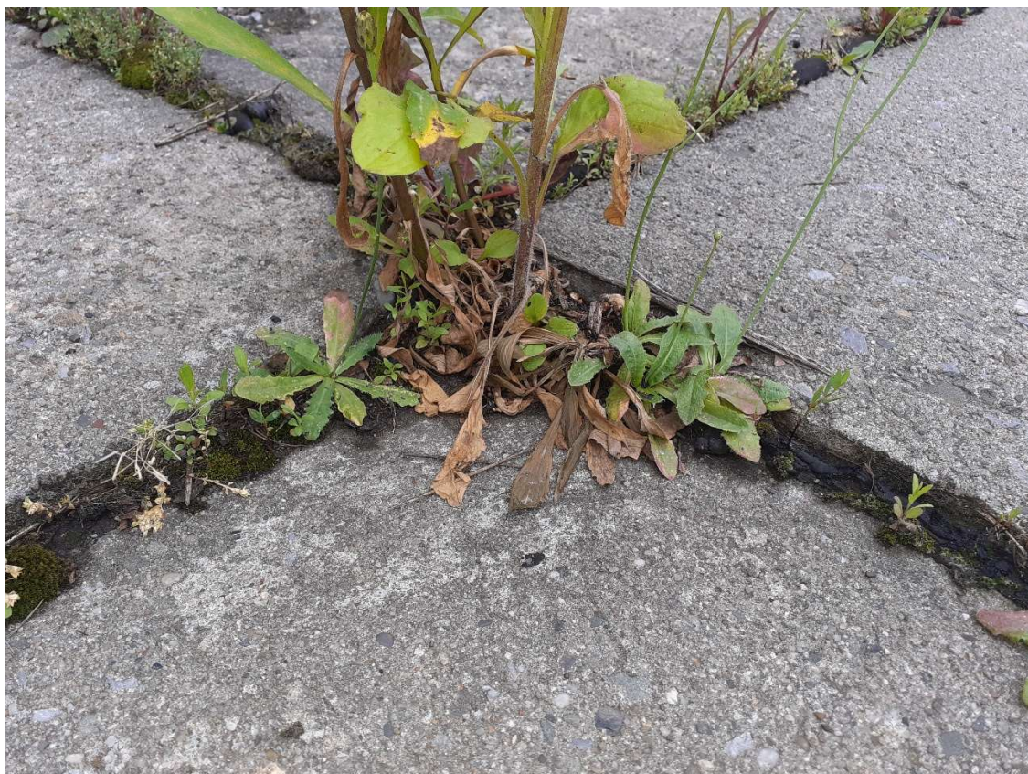
Fot.39 teren za budynkiem, zdegradowana nawierzchnia, uskoki pomiędzy płytami..
