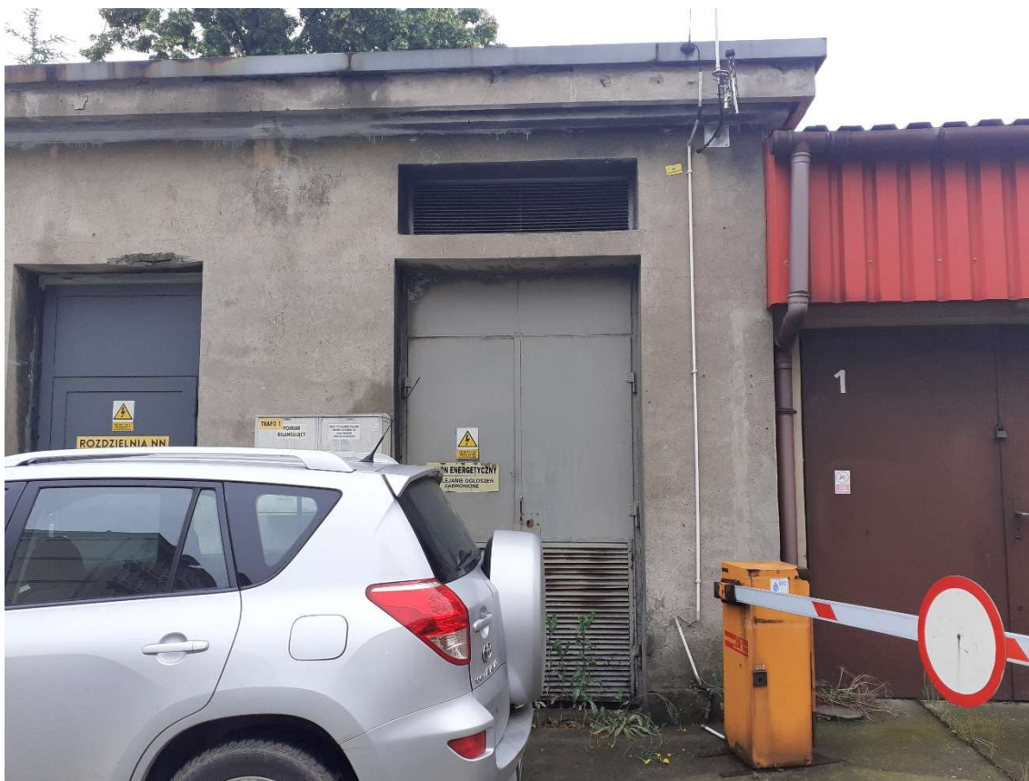
Fot.27 teren za budynkiem, zdegradowana nawierzchnia, budynek stacji trafo i budynek garaży.
