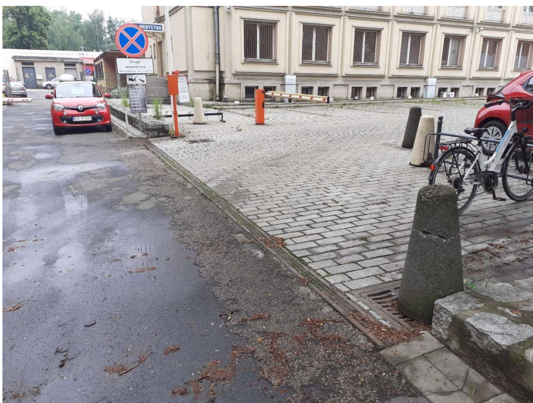
Fot.75 teren przed budynkiem, brak odpowiedniego odwodnienia, zdegradowana nawierzchnia, widoczne nierówności nawierzchni z zastoiskami wody.
