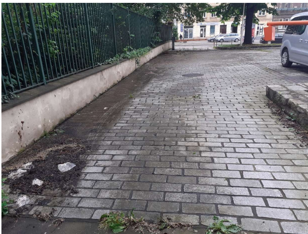
Fot.69 teren z boku budynku, brak odpowiedniego odwodnienia, zdegradowane murki terenowe, murki ogrodzeniowe.
