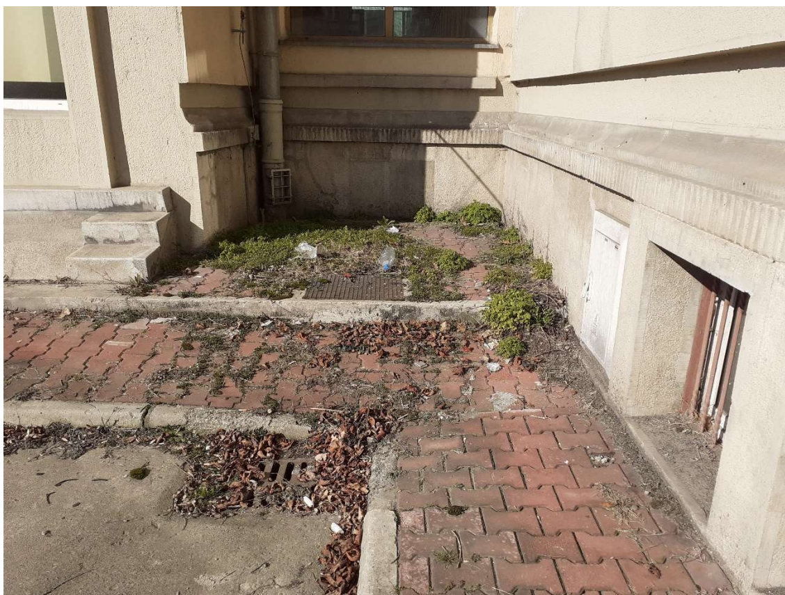
Fot.11 teren za budynkiem – komory podziemne do ewentualnej likwidacji lub renowacji/modernizacji, zdegradowane elementy nawierzchni.
