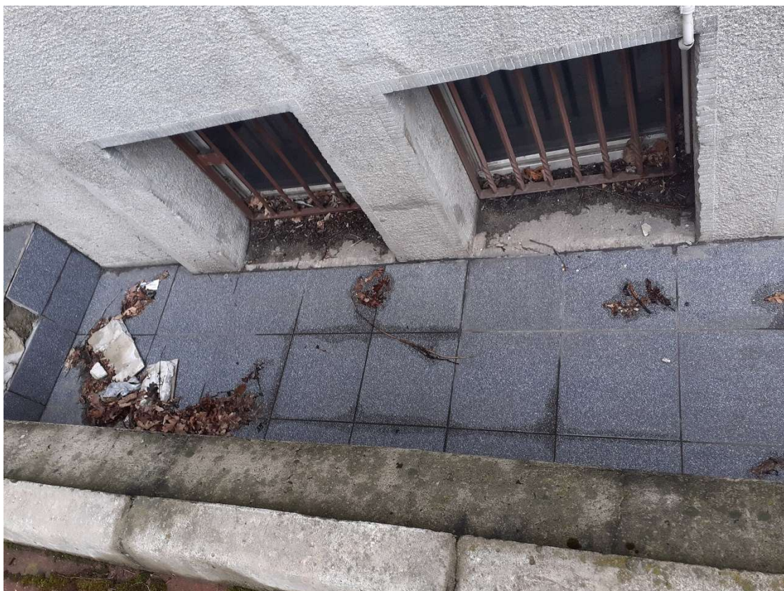
Fot.45 teren za budynkiem, zdegradowana nawierzchnia, brak odpowiedniego odwodnienia – poziom wody przy obfitych opadach dochodzi do okien i zalewa wnętrze budynku – przy oknach widoczne ślady po wodzie deszczowej, która zalewa wnętrze budynku, płytki gresowe w większości odspojone – słychać głuchy odgłos przy uderzaniu płytek – do zastąpienia inną, adekwatną nawierzchnią.
