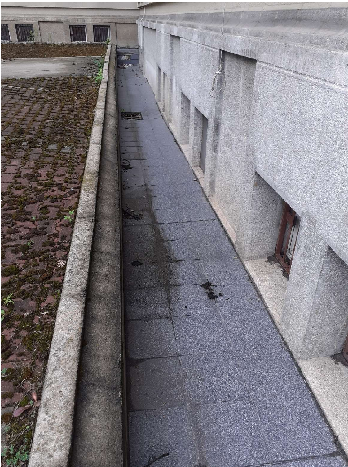
Fot.44 teren za budynkiem, zdegradowana nawierzchnia, brak odpowiedniego odwodnienia – poziom wody przy obfitych opadach dochodzi do okien i zalewa wnętrze budynku – przy oknach widoczne ślady po wodzie deszczowej, która zalewa wnętrze budynku, płytki gresowe w większości odspojone – słychać głuchy odgłos przy uderzaniu płytek – do zastąpienia inną, adekwatną nawierzchnią.
