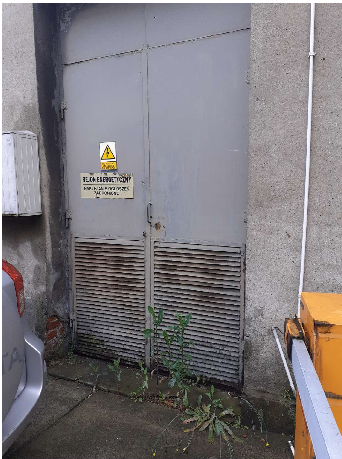
Fot.28 teren za budynkiem, zdegradowana nawierzchnia, elewacja budynku stacji trafo.
