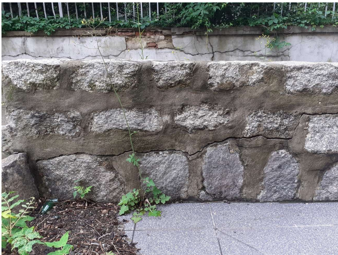
Fot.56 teren za budynkiem, zdegradowane murki terenowe do renowacji – widok z boku.
