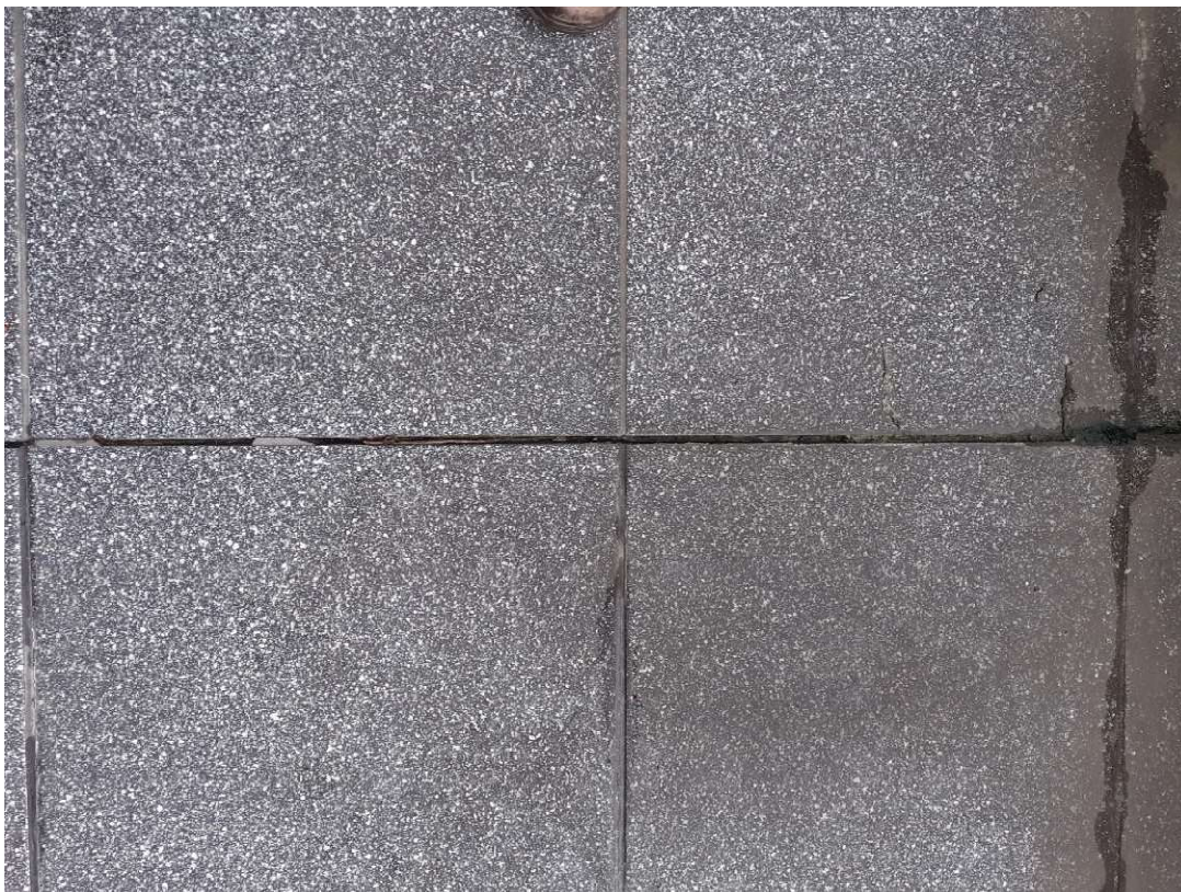
Fot.50 teren za budynkiem, zdegradowana nawierzchnia, brak fugi pomiędzy płytkami gresowymi, płytki w większości odspojone – głuchy odgłos przy lekkim uderzeniu w takie płytki.
