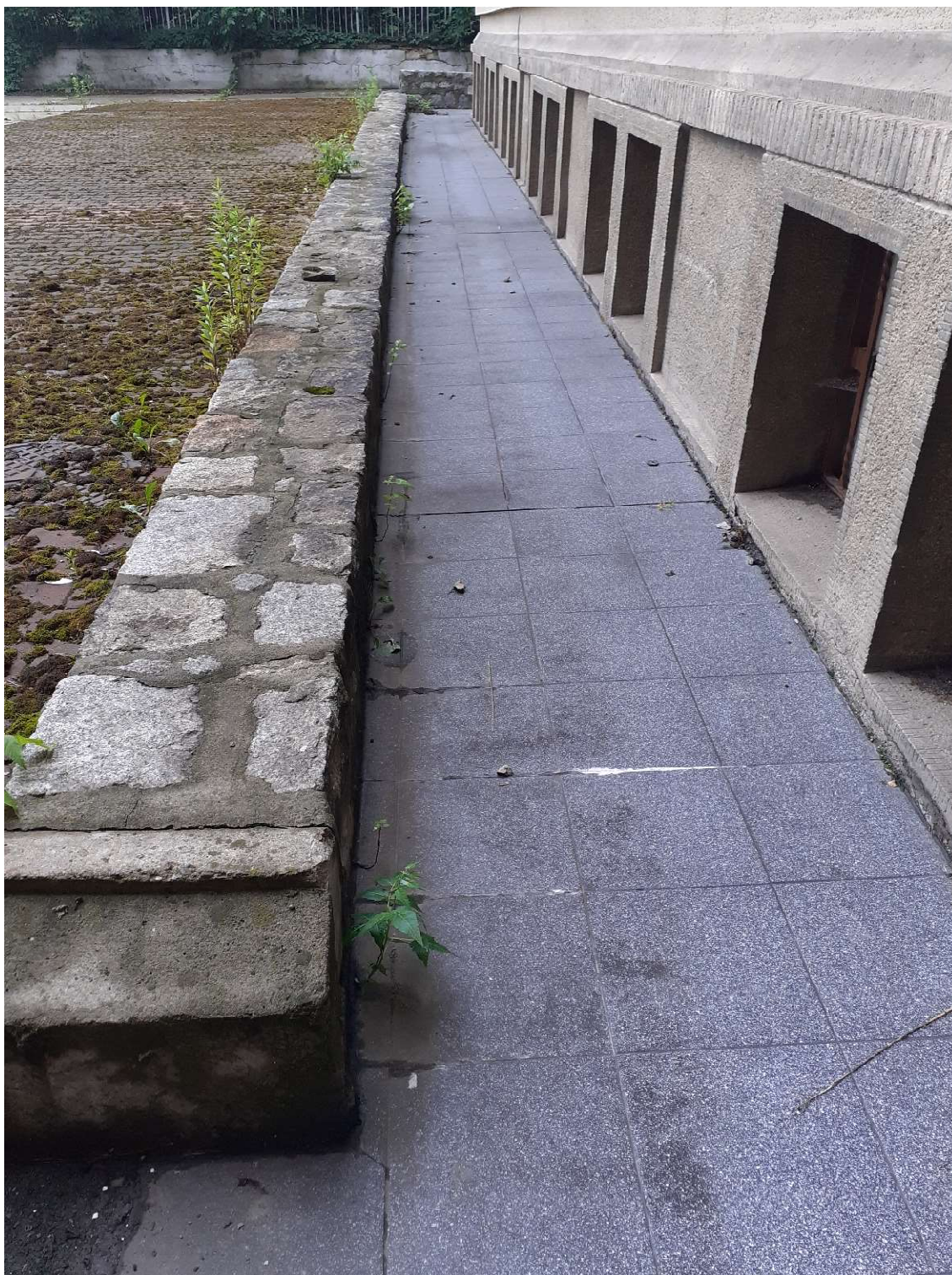
Fot.49 teren za budynkiem, zdegradowana nawierzchnia, brak odpowiedniego odwodnienia – poziom wody przy obfitych opadach dochodzi do okien i zalewa wnętrze budynku – przy oknach widoczne ślady po wodzie deszczowej, która zalewa wnętrze budynku, płytki gresowe w większości odspojone – słychać głuchy odgłos przy uderzaniu płytek – do zastąpienia inną, adekwatną nawierzchnią, zdegradowane murki terenowe do renowacji.
