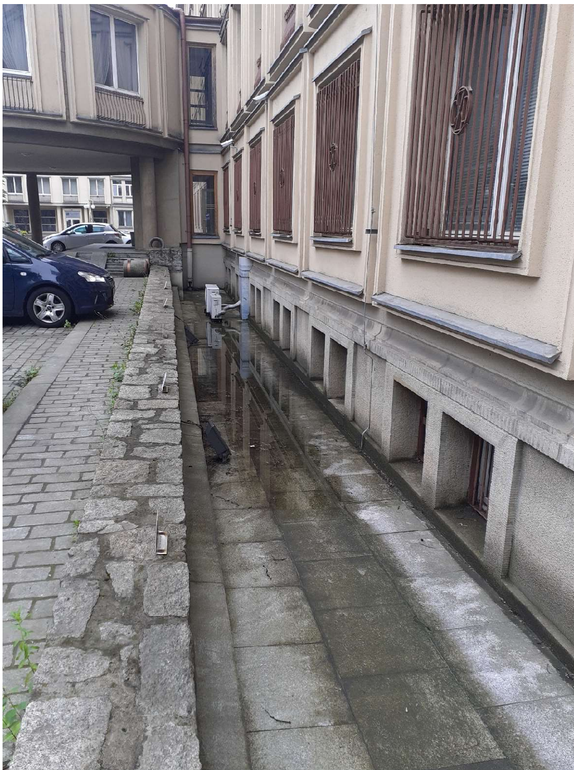
Fot.63 teren przed budynkiem, brak odpowiedniego odwodnienia – zastoiska wody przed budynkiem, podczas obfitych deszczy poziom wody dochodzi do okien i zalewa wnętrze budynku – przy oknach widoczne ślady wilgoci po wodzie opadowej.
