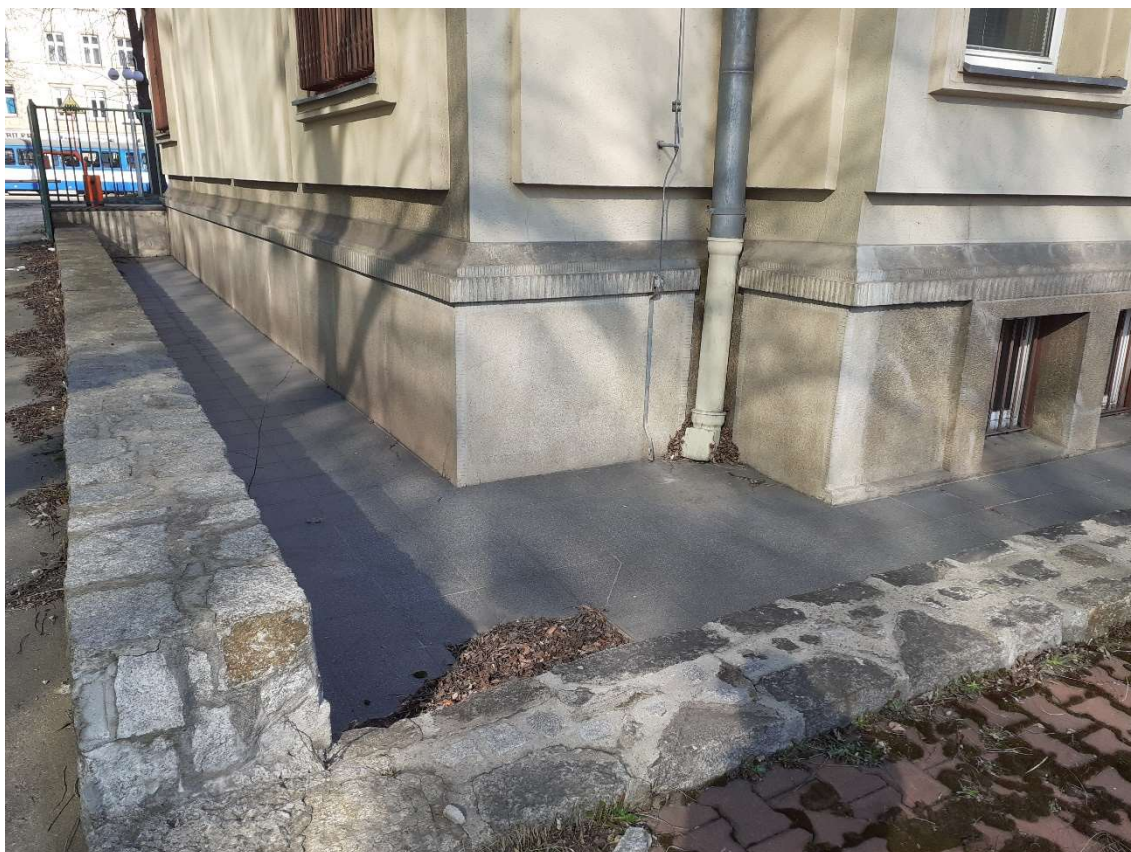
Fot.60 teren za budynkiem, brak odpowiedniego odwodnienia.
