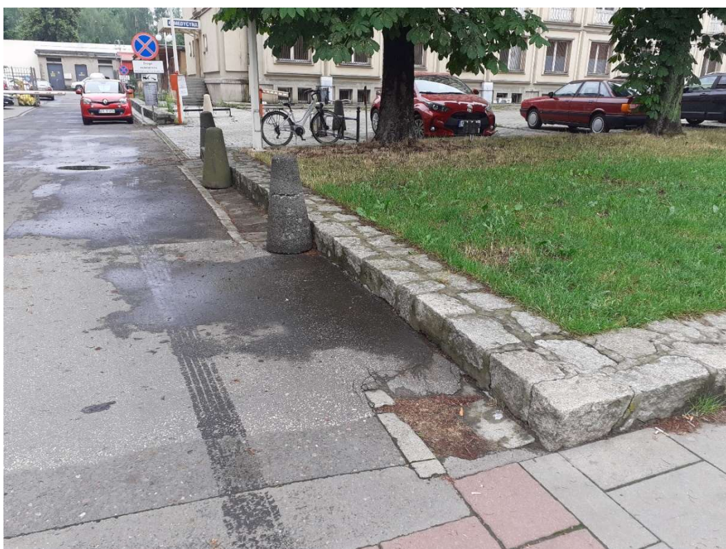
Fot.73 teren przed budynkiem, brak odpowiedniego odwodnienia, zdegradowana nawierzchnia, widoczne nierówności nawierzchni.
