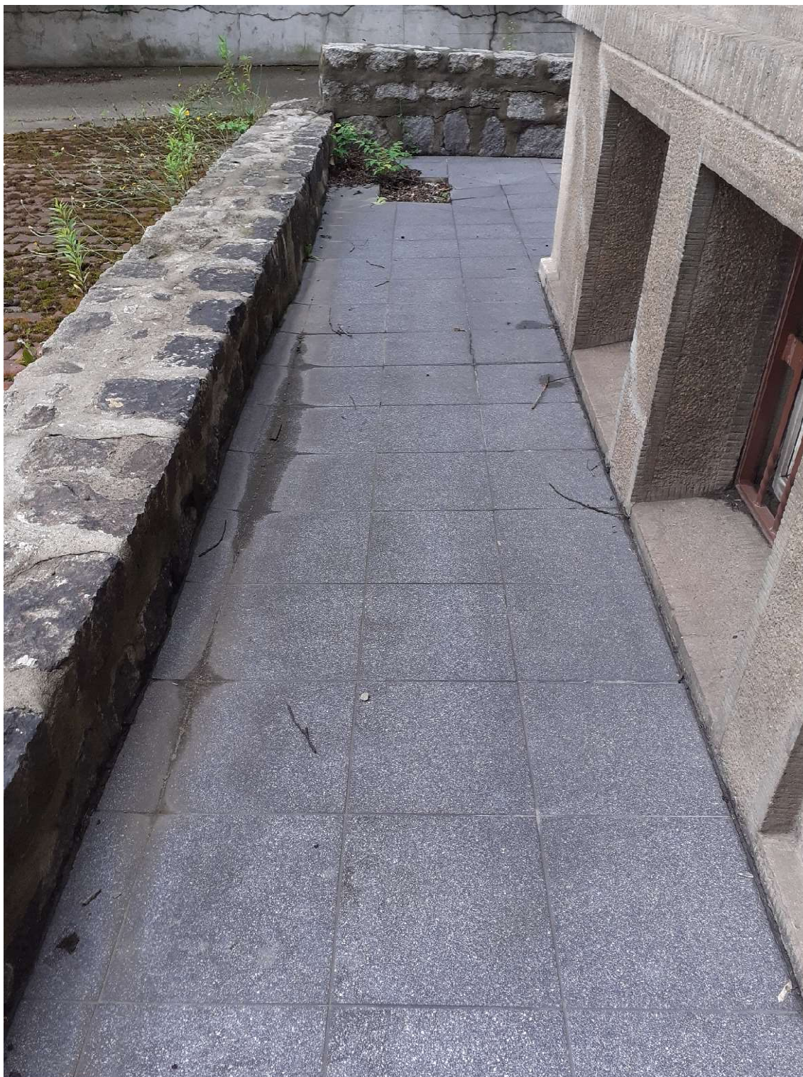
Fot.54 teren za budynkiem, zdegradowana nawierzchnia, brak odpowiedniego odwodnienia – poziom wody przy obfitych opadach dochodzi do okien i zalewa wnętrze budynku – przy oknach widoczne ślady po wodzie deszczowej, która zalewa wnętrze budynku, płytki gresowe w większości odspojone – słychać głuchy odgłos przy uderzaniu płytek – do zastąpienia inną, adekwatną nawierzchnią, zdegradowane murki terenowe do renowacji.
