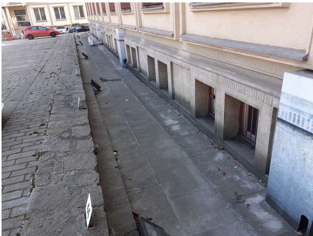
Fot. 2 teren bezpośrednio przed budynkiem – brak odpowiedniego odwodnienia, przy oknach widoczne ślady po wodzie która zalewa wnętrze budynku, zdegradowane elementy nawierzchni, murki oporowe, murki terenowe do renowacji.
