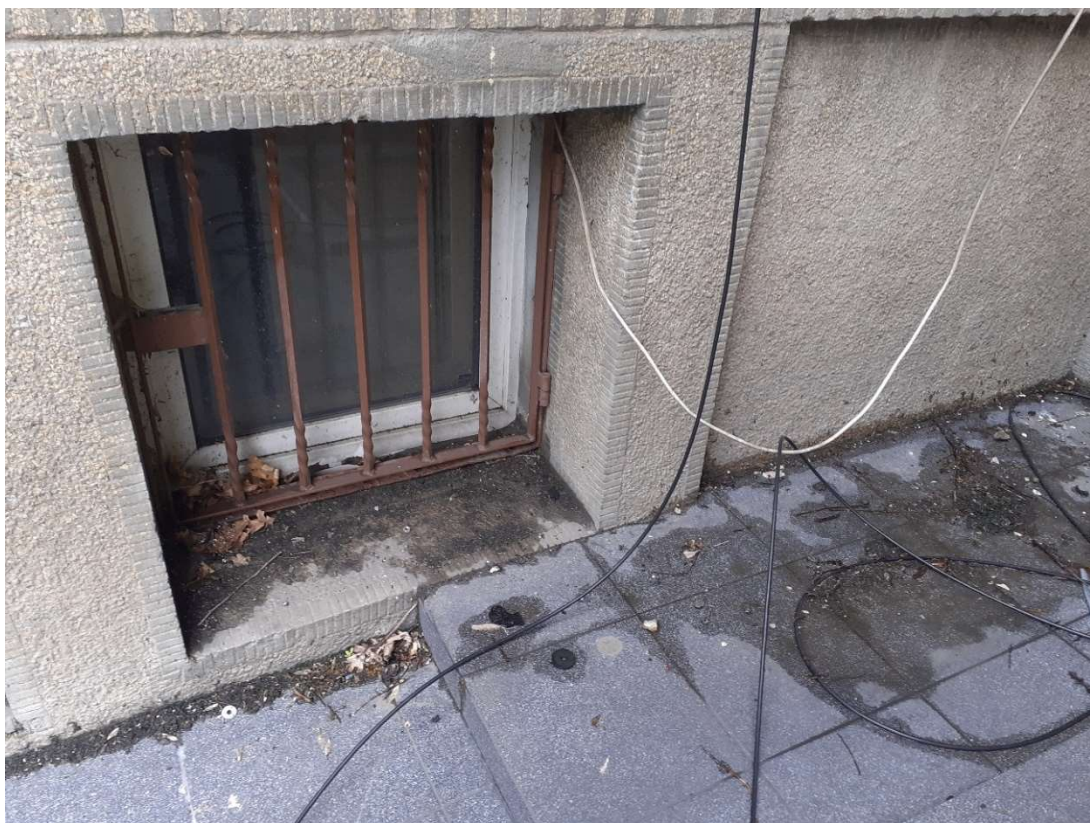
Fot.47 teren za budynkiem, zdegradowana nawierzchnia, brak odpowiedniego odwodnienia – poziom wody przy obfitych opadach dochodzi do okien i zalewa wnętrze budynku – przy oknach widoczne ślady po wodzie deszczowej, która zalewa wnętrze budynku, płytki gresowe w większości odspojone – słychać głuchy odgłos przy uderzaniu płytek – do zastąpienia inną, adekwatną nawierzchnią.
