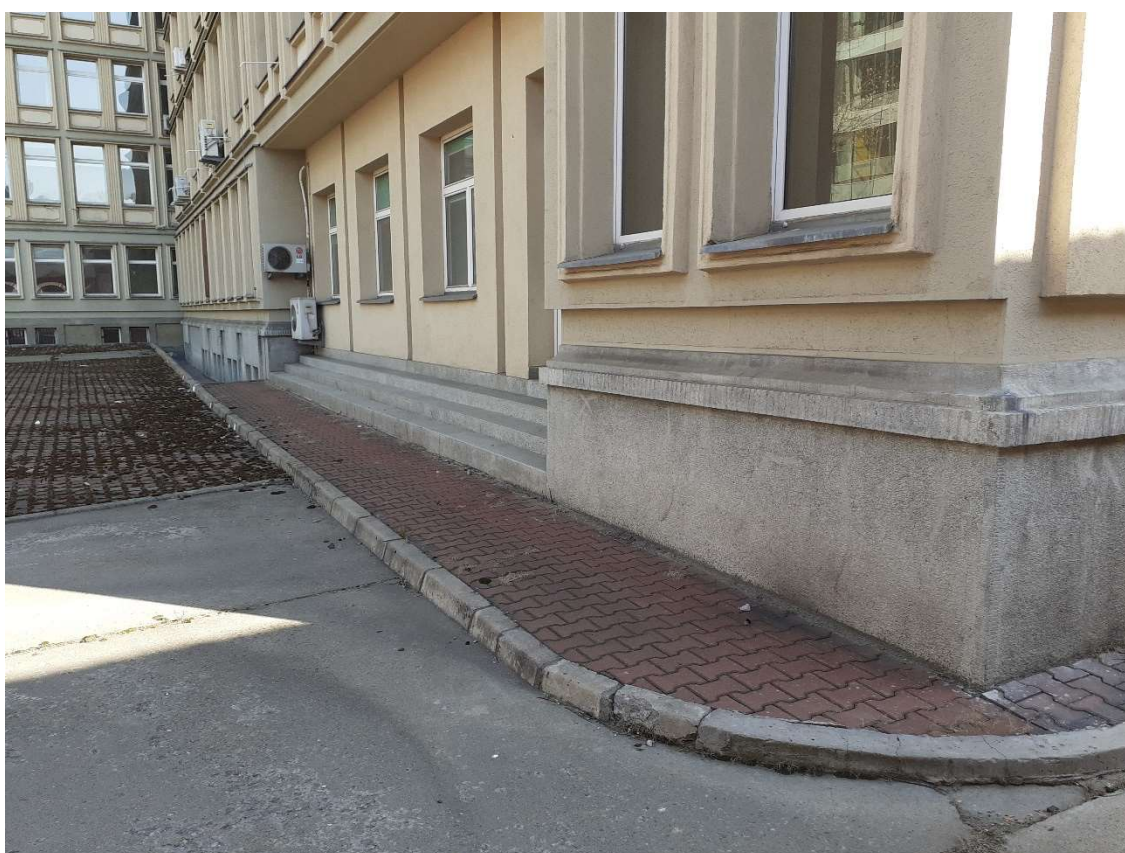
Fot.40 teren za budynkiem, zdegradowana nawierzchnia, uskoki pomiędzy płytami.
