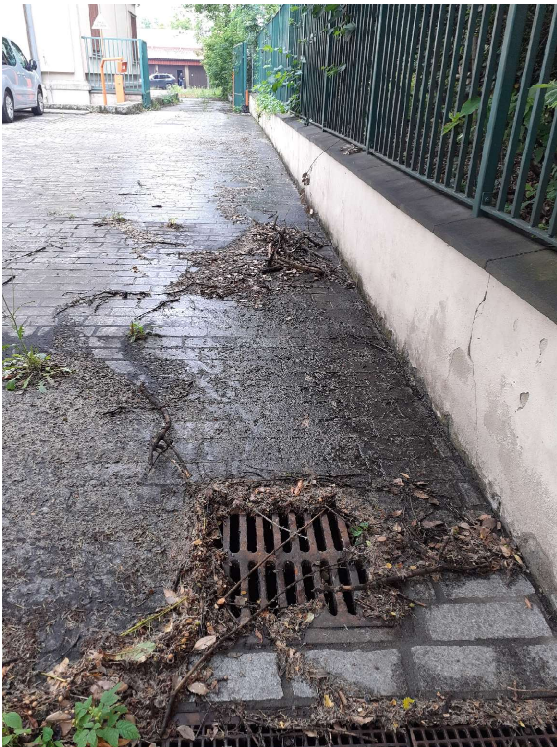
Fot.71 teren z boku budynku, brak odpowiedniego odwodnienia, zdegradowane murki terenowe, murki ogrodzeniowe.
