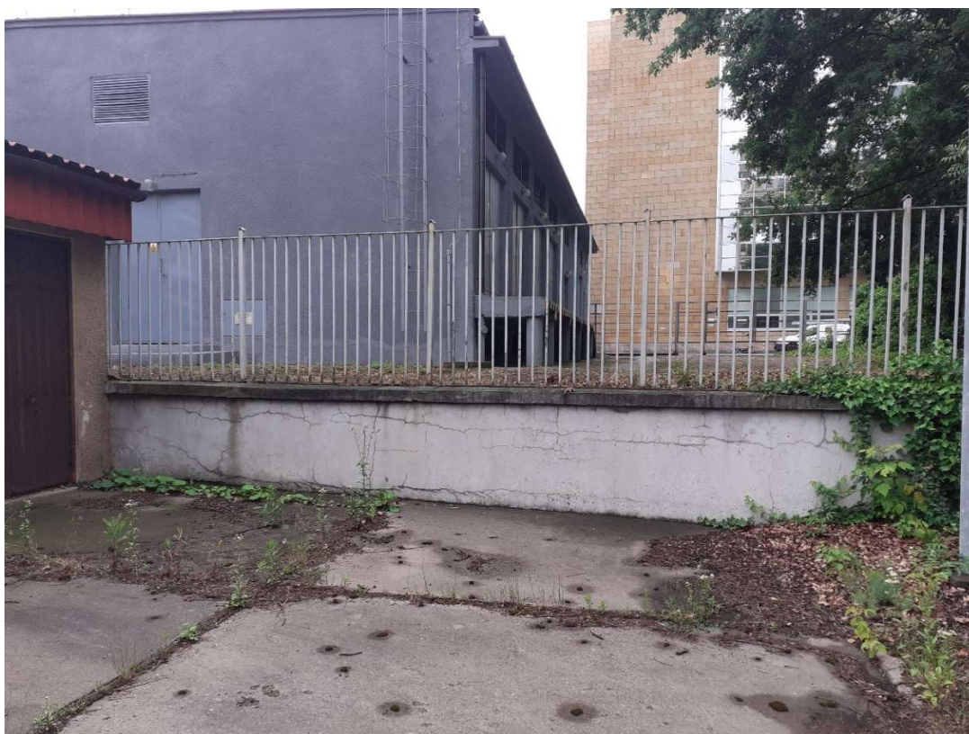
Fot.65 teren za budynkiem, brak odpowiedniego odwodnienia, zdegradowana nawierzchnia, uskoki pomiędzy płytami, zdegradowana powierzchnia murków terenowych, murków ogrodzeniowych.
