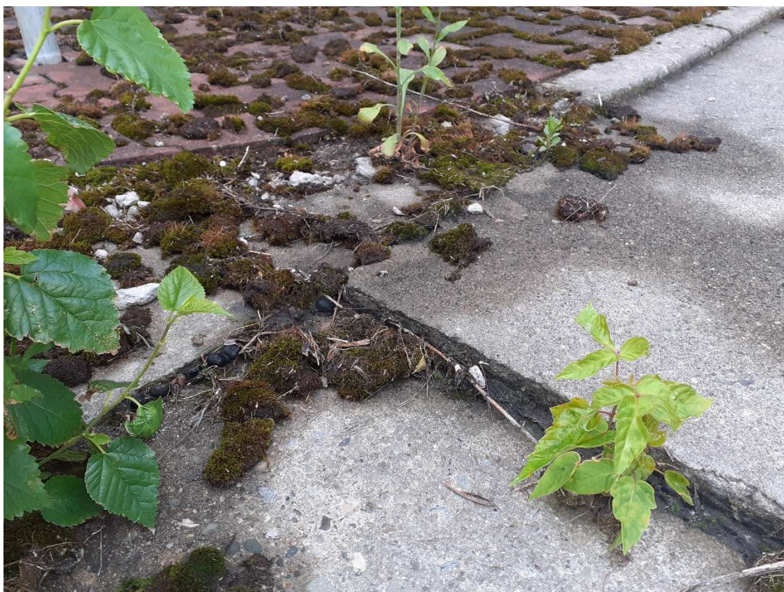
Fot.38 teren za budynkiem, zdegradowana nawierzchnia, uskoki pomiędzy płytami.
