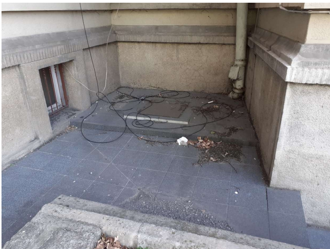
Fot.48 teren za budynkiem, zdegradowana nawierzchnia.
