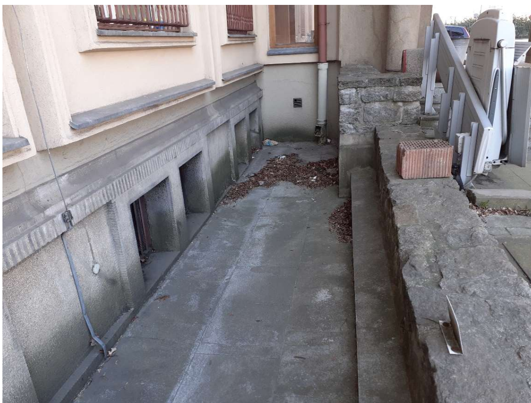
Fot. 4 teren przed budynkiem – brak odpowiedniego odwodnienia, przy oknach widoczne ślady po wodzie która zalewa wnętrze budynku, zdegradowane elementy nawierzchni, murki oporowe, murki terenowe do renowacji.
