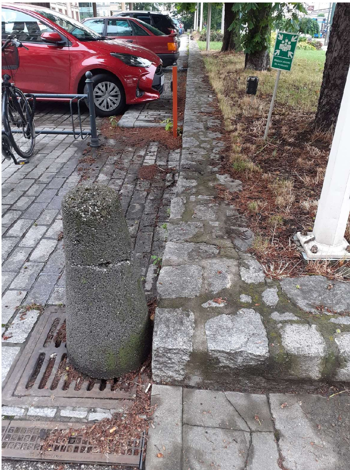
Fot.76 teren przed budynkiem, brak odpowiedniego odwodnienia, zdegradowana nawierzchnia, zdegradowane murki terenowe.
