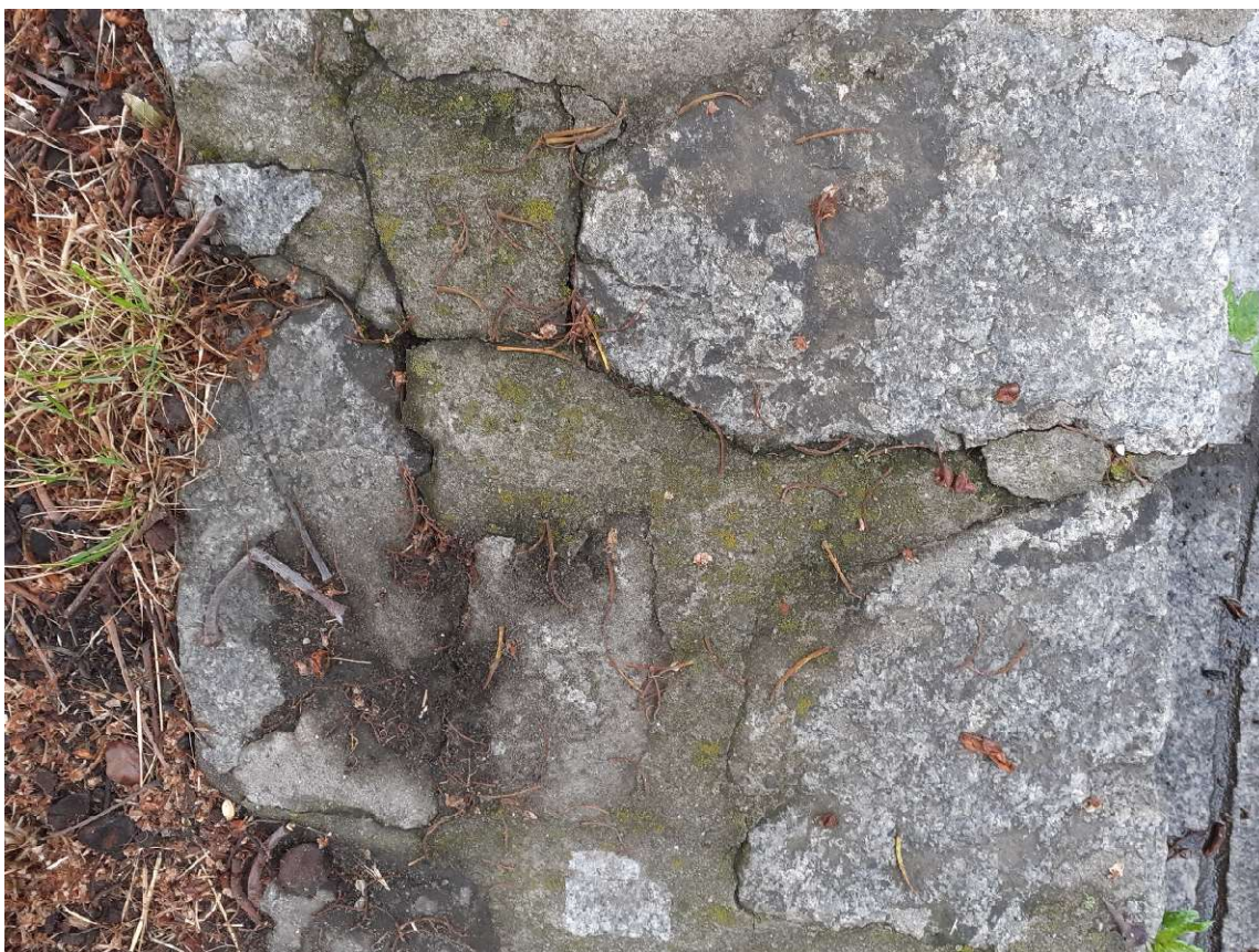
Fot.77 teren przed budynkiem, zdegradowane murki terenowe.
