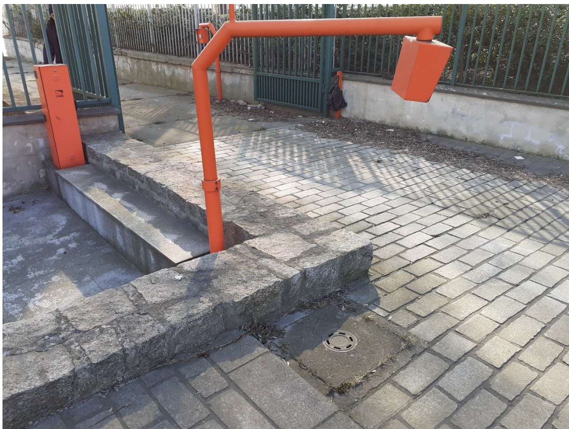
Fot.70 teren z boku budynku, brak odpowiedniego odwodnienia, zdegradowane murki terenowe, murki ogrodzeniowe.
