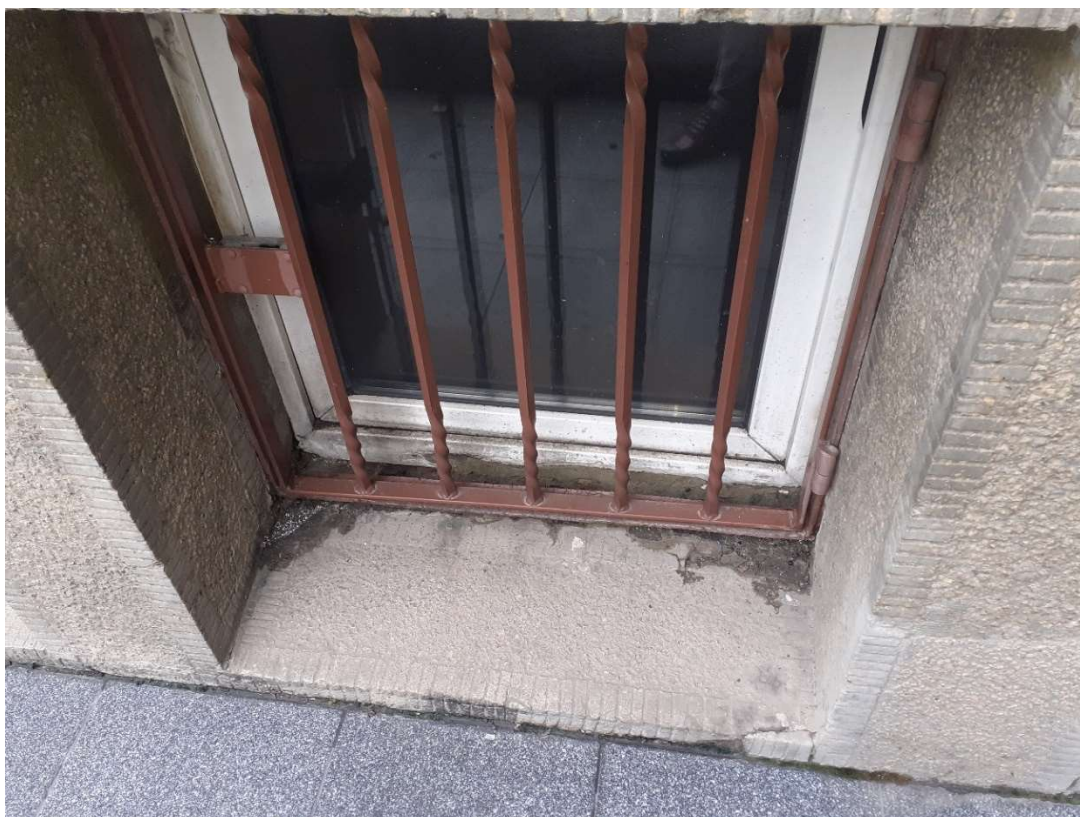
Fot.51 teren za budynkiem, zdegradowana nawierzchnia, brak odpowiedniego odwodnienia – poziom wody przy obfitych opadach dochodzi do okien i zalewa wnętrze budynku – przy oknach widoczne ślady po wodzie deszczowej, która zalewa wnętrze budynku.
