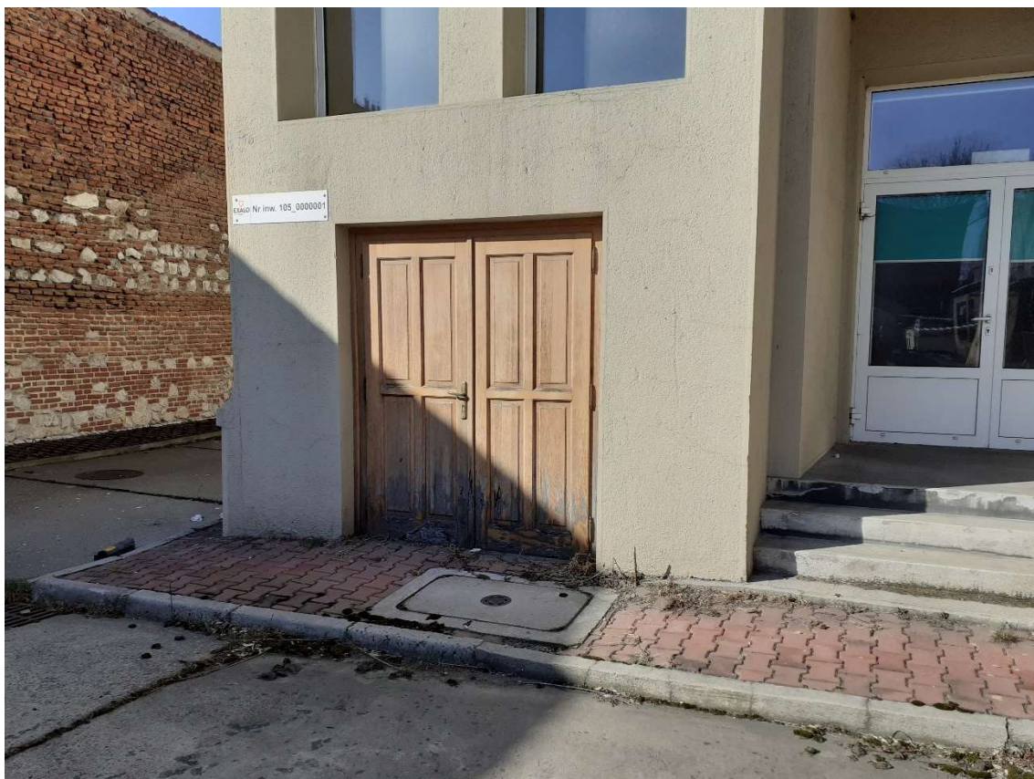
Fot.14 teren za budynkiem, zdegradowane elementy nawierzchni, brak odpowiedniego odwodnienia, studzienka koliduje z planowaną kratką przed drzwiami do budynku.
