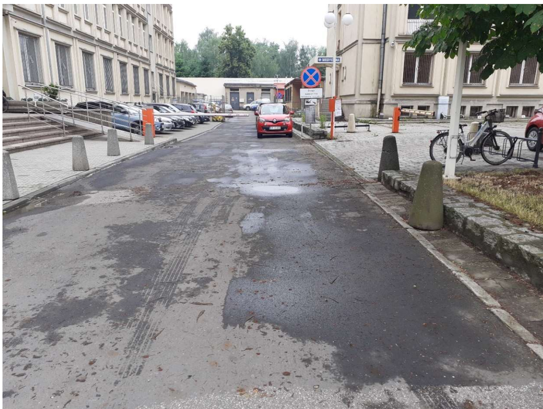
Fot.74 teren przed budynkiem, brak odpowiedniego odwodnienia, zdegradowana nawierzchnia, widoczne nierówności nawierzchni z zastoiskami wody.
