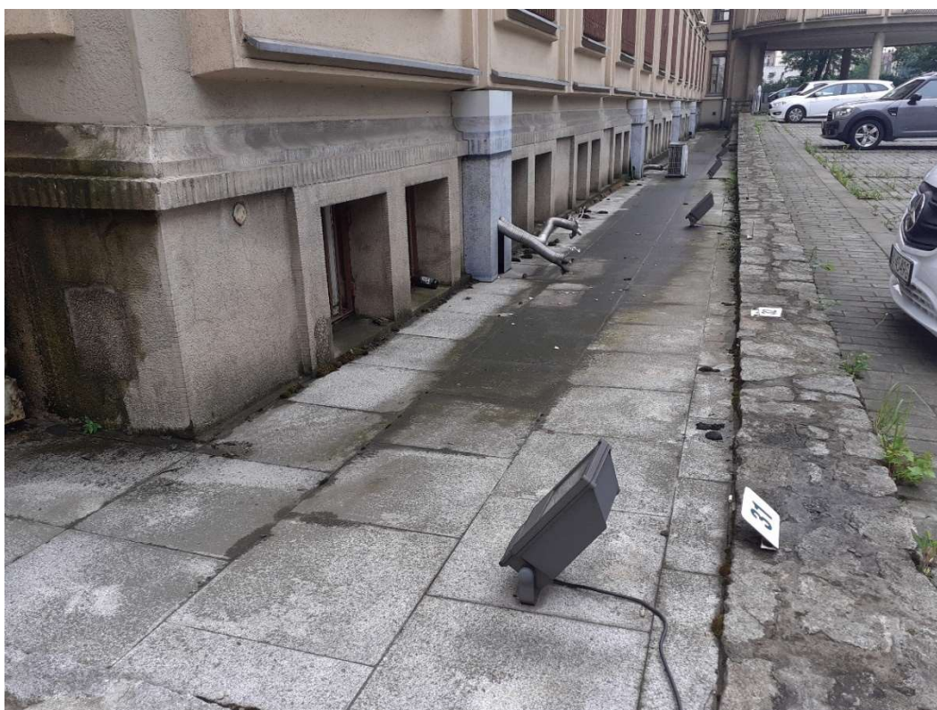
Fot. 3 teren bezpośrednio przed budynkiem – brak odpowiedniego odwodnienia, przy oknach widoczne ślady po wodzie która zalewa wnętrze budynku, widoczne zastoiska wody, zdegradowane elementy nawierzchni, murki oporowe, murki terenowe do renowacji. zdegradowane elementy nawierzchni, murki oporowe, murki terenowe do renowacji.
