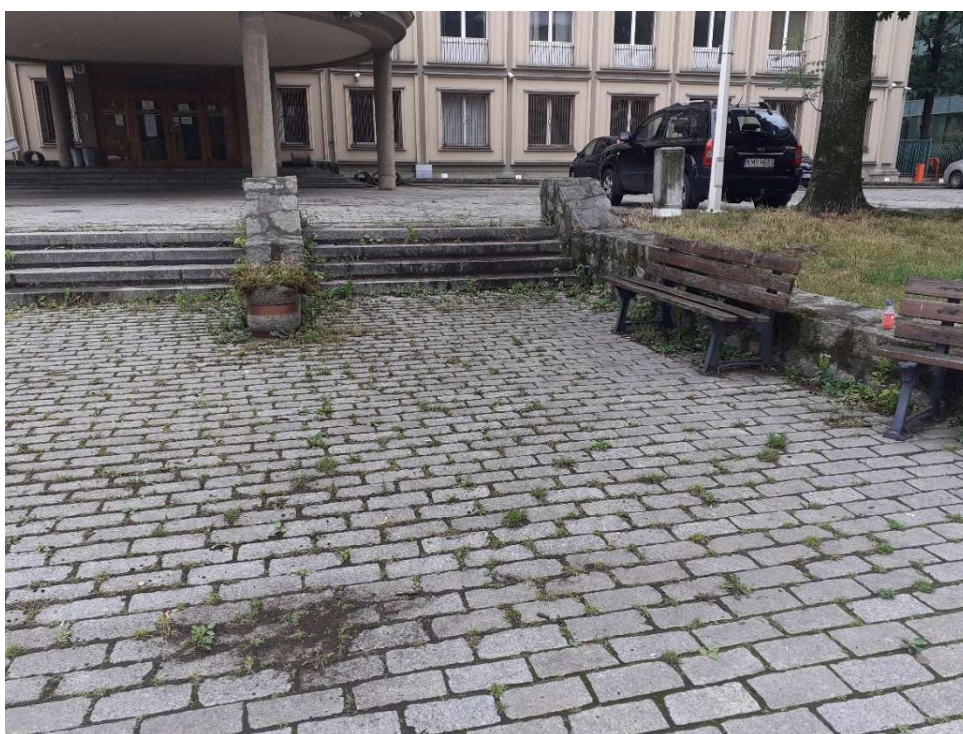
Fot.2 teren przed schodami i schody główne z nierównościami, brak odwodnienia, widoczne nierówności ze śladami po kałużach i zastoiskach wody.
