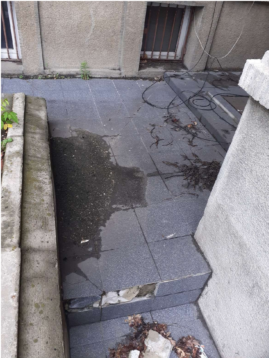
Fot.46 teren za budynkiem, zdegradowana nawierzchnia, brak odpowiedniego odwodnienia – poziom wody przy obfitych opadach dochodzi do okien i zalewa wnętrze budynku – przy oknach widoczne ślady po wodzie deszczowej, która zalewa wnętrze budynku, płytki gresowe w większości odspojone – słychać głuchy odgłos przy uderzaniu płytek – do zastąpienia inną, adekwatną nawierzchnią.
