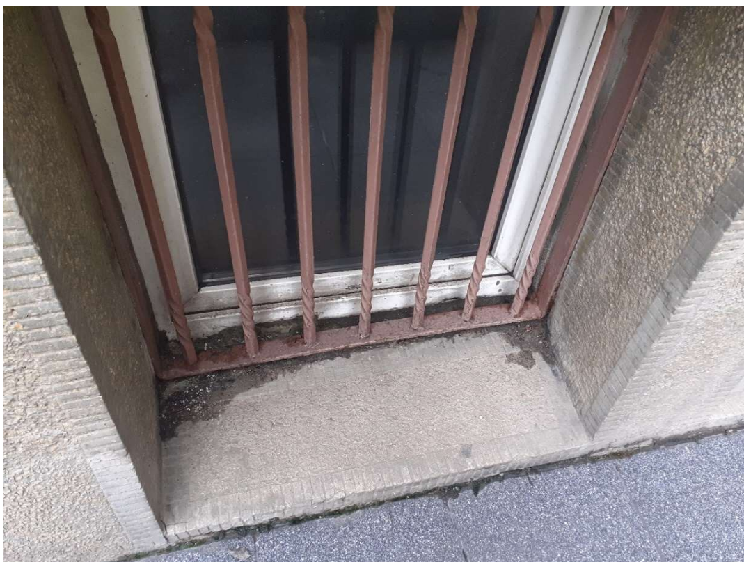
Fot.52 teren za budynkiem, zdegradowana nawierzchnia, brak odpowiedniego odwodnienia – poziom wody przy obfitych opadach dochodzi do okien i zalewa wnętrze budynku – przy oknach widoczne ślady po wodzie deszczowej, która zalewa wnętrze budynku.
