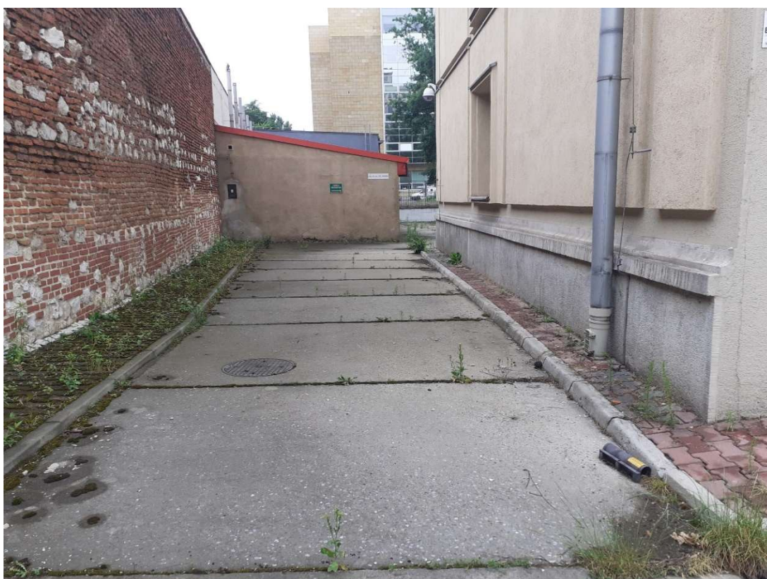
Fot.34 teren za budynkiem, zdegradowana nawierzchnia, uskoki pomiędzy płytami, brak odpowiedniego odwodnienia terenu.
