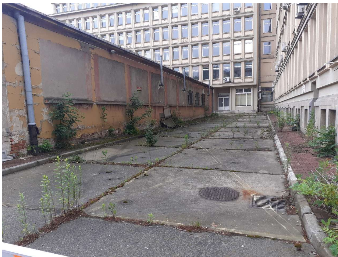
Fot. 7 teren za budynkiem – brak odpowiedniego odwodnienia, zdegradowane elementy nawierzchni, budynek po Archiwum Narodowym planowany do rozbiórki.
