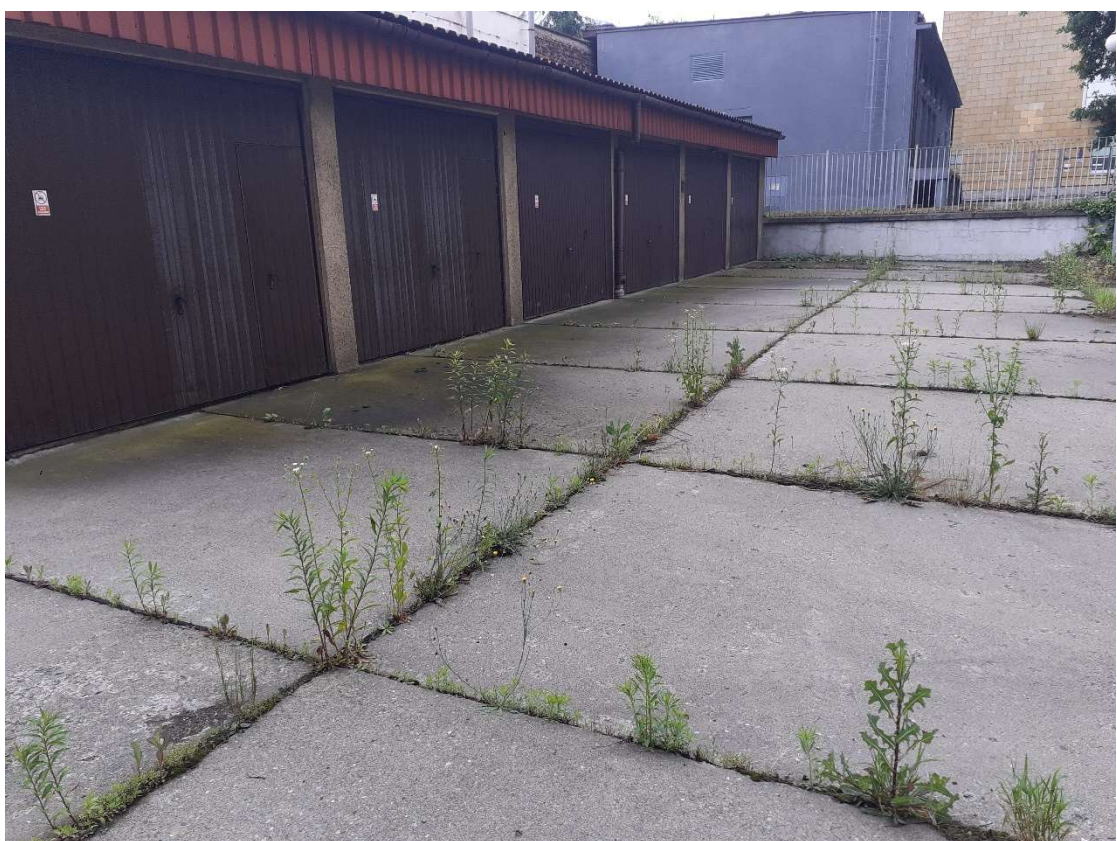
Fot.36 teren za budynkiem, zdegradowana nawierzchnia, uskoki pomiędzy płytami.
