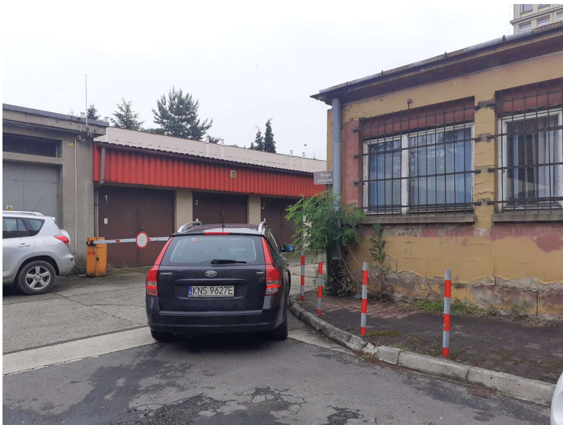
Fot.26 teren za budynkiem, zdegradowana nawierzchnia, budynek po Archiwum Narodowym planowany do rozbiórki.
