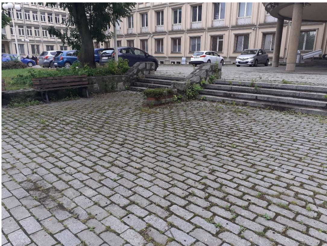
Fot.3 teren przed schodami i schody główne z nierównościami, brak odwodnienia, widoczne nierówności ze śladami po kałużach i zastoiskach wody.
