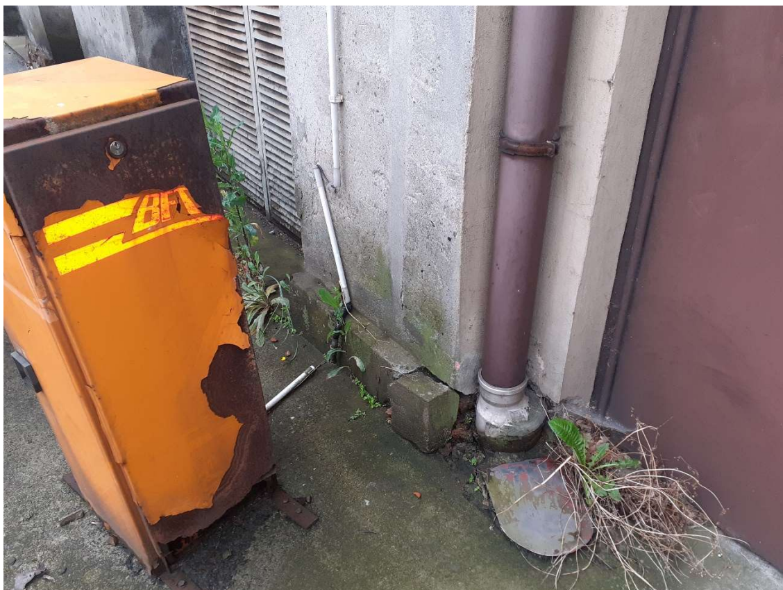
Fot.29 teren za budynkiem, zdegradowana nawierzchnia, elewacja budynku stacji trafo i garaży.
