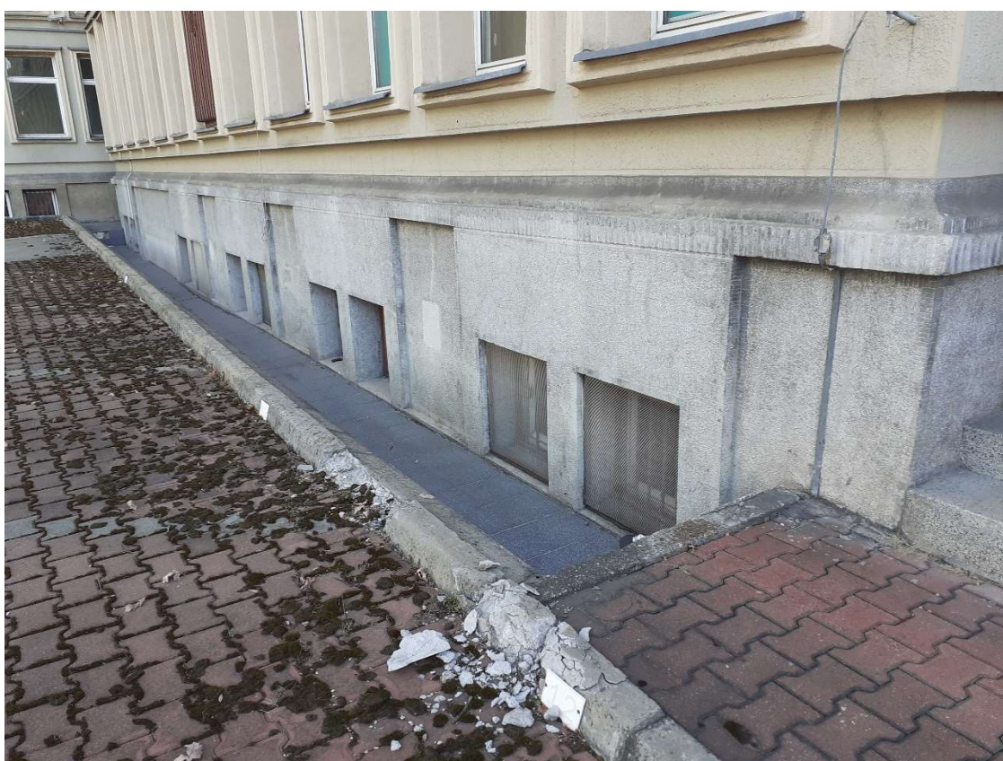
Fot.42 teren za budynkiem, zdegradowana nawierzchnia, brak odwodnienia – poziom wody przy obfitych opadach dochodzi do okien i zalewa wnętrza budynku, płytki gresowe w większości odspojone – słychać głuchy odgłos przy uderzaniu płytek – do zastąpienia inną, adekwatną nawierzchnią.
