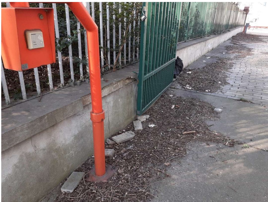
Fot.68 teren z boku budynku, brak odpowiedniego odwodnienia, zdegradowana nawierzchnia, uskoki pomiędzy płytami, zdegradowane murki terenowe, murki ogrodzeniowe.
