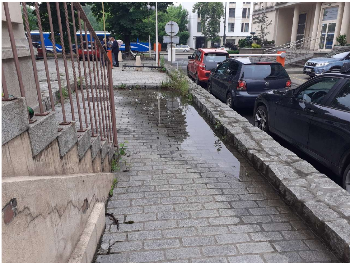
Fot. 5 teren bezpośrednio przed budynkiem – brak odpowiedniego odwodnienia – widoczne zastoiska wody, zdegradowane elementy nawierzchni, murki oporowe, murki terenowe do renowacji.
