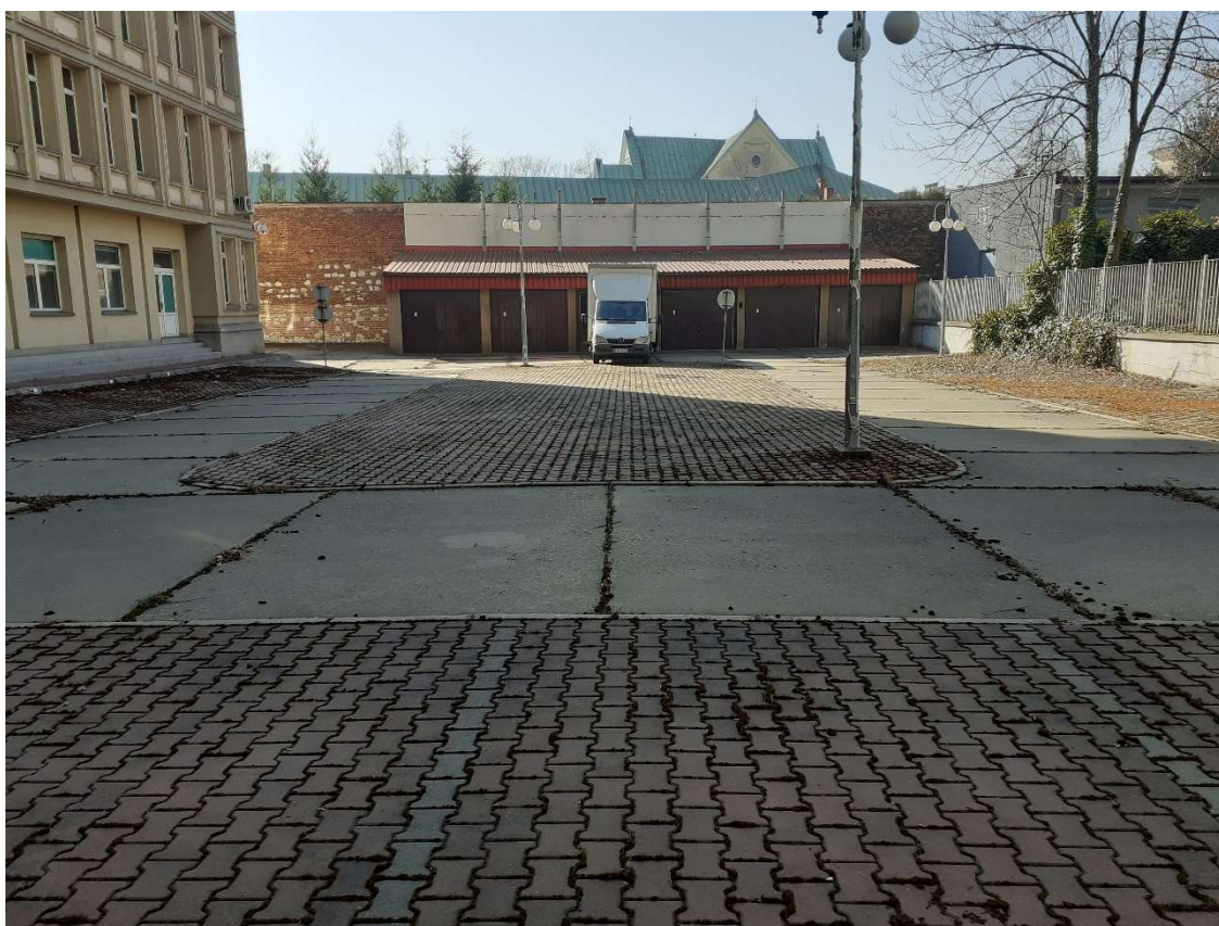
Fot.59 teren za budynkiem, zdegradowana nawierzchnia, murki terenowe, uskoki pomiędzy płytami
