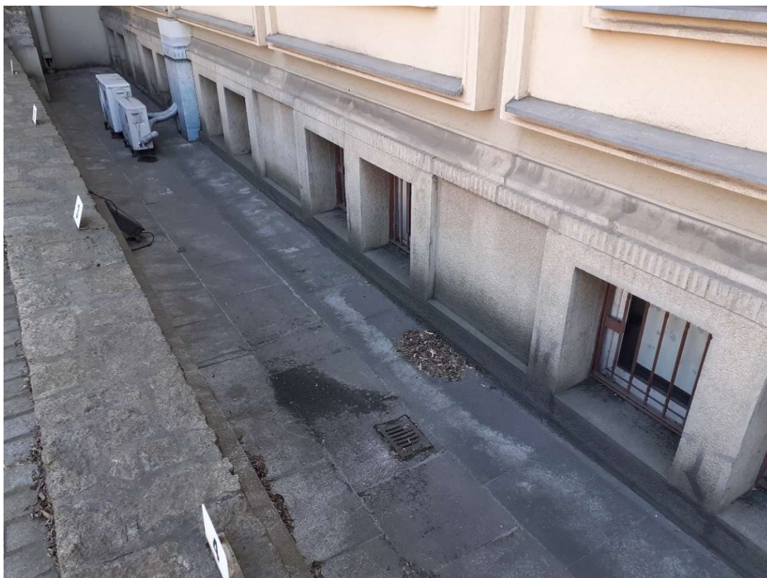
Fot.64 teren przed budynkiem, brak odpowiedniego odwodnienia, podczas obfitych deszczy poziom wody dochodzi do okien i zalewa wnętrze budynku – przy oknach widoczne ślady wilgoci po wodzie opadowej.
