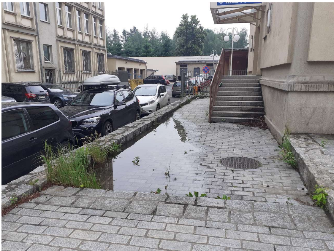
Fot. 4 teren bezpośrednio przed budynkiem – brak odpowiedniego odwodnienia – widoczne zastoiska wody, zdegradowane elementy nawierzchni, murki oporowe, murki terenowe do renowacji.
