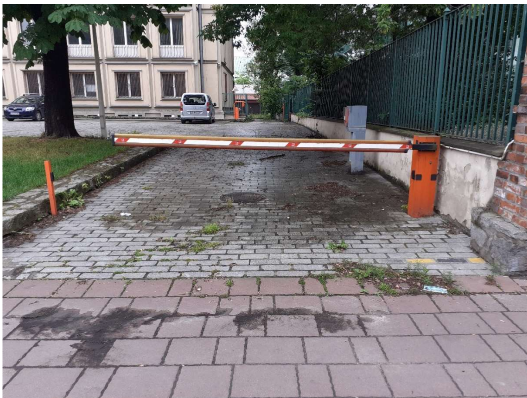
Fot.72 teren przed budynkiem, brak odpowiedniego odwodnienia, zdegradowane murki terenowe, murki ogrodzeniowe, zdegradowana nawierzchnia, widoczne wgłębienia z zastoiskami po wodzie opadowej.
