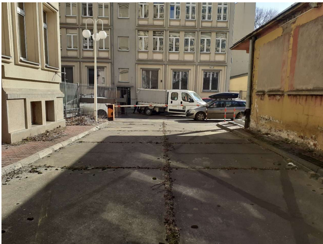
Fot.10 teren za budynkiem – brak odpowiedniego odwodnienia, zdegradowane elementy nawierzchni, budynek po Archiwum Narodowym planowany do rozbiórki.
