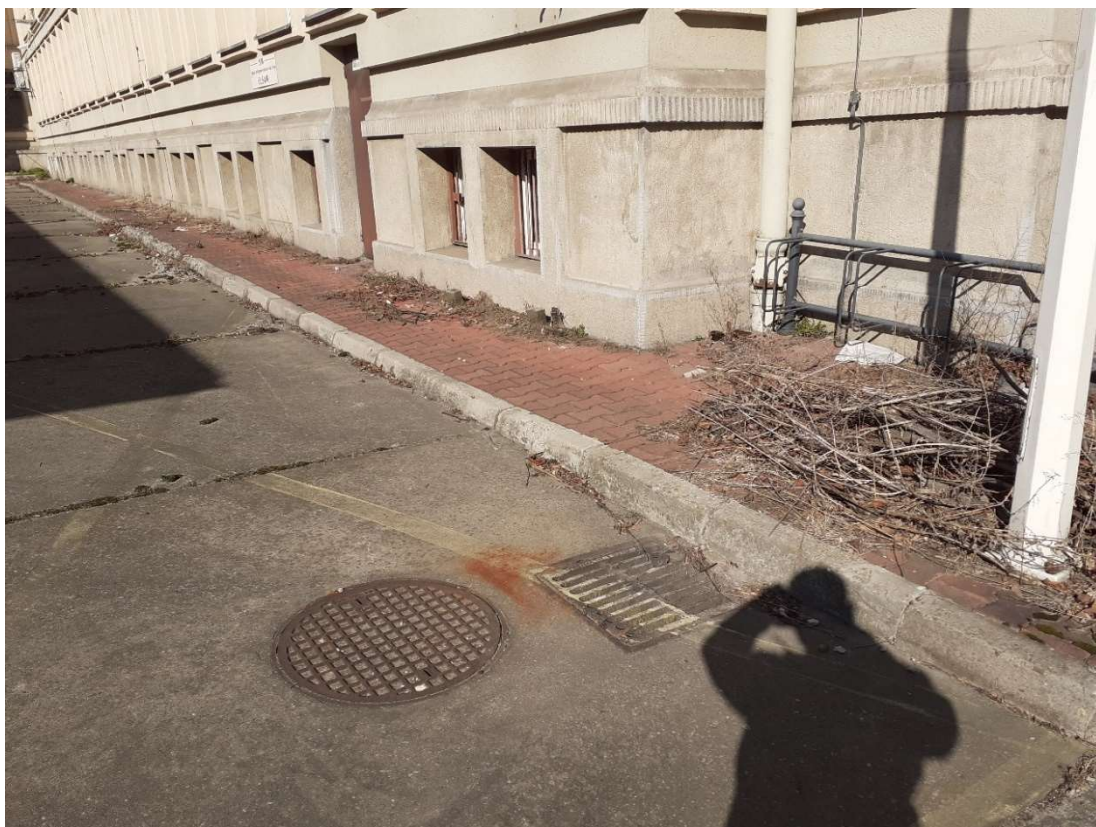
Fot. 8 teren za budynkiem – brak odpowiedniego odwodnienia, zdegradowane elementy nawierzchni.
