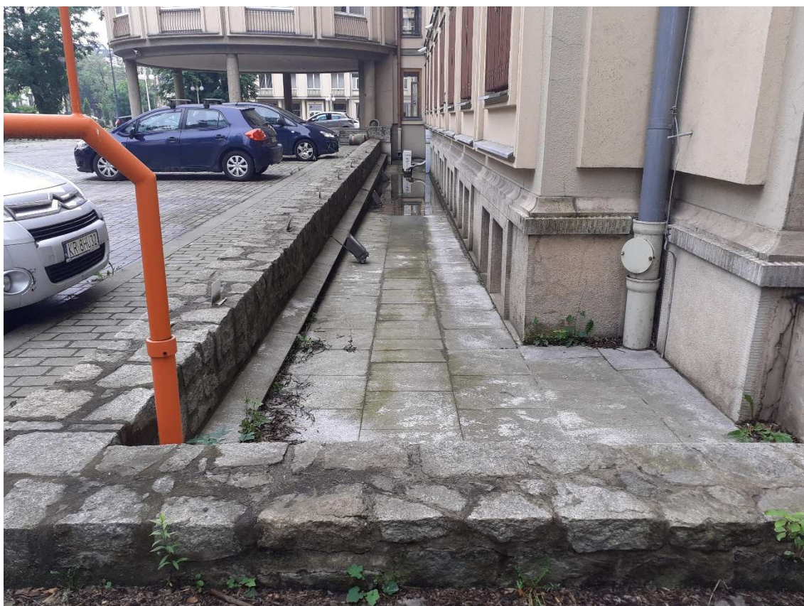
Fot.61 teren przed budynkiem, brak odpowiedniego odwodnienia, zdegradowane elementy terenu zewnętrznego do renowacji.
