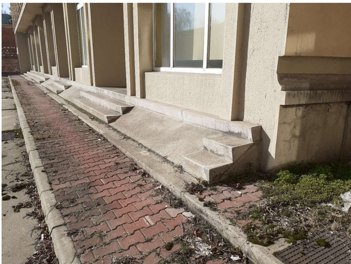
Fot.12 teren za budynkiem, zdegradowane elementy nawierzchni.
