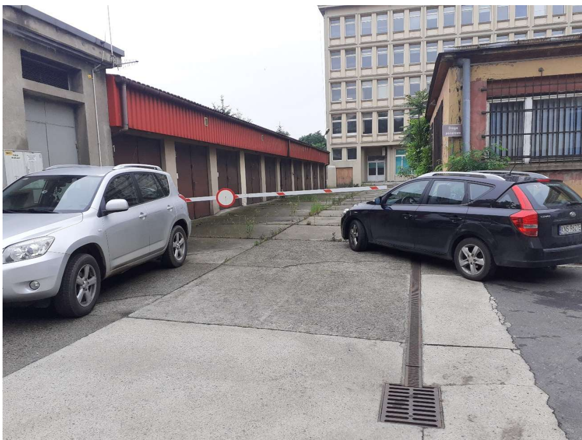
Fot.31 teren za budynkiem, zdegradowana nawierzchnia, budynek Archiwum Narodowego planowany do rozbiórki.
