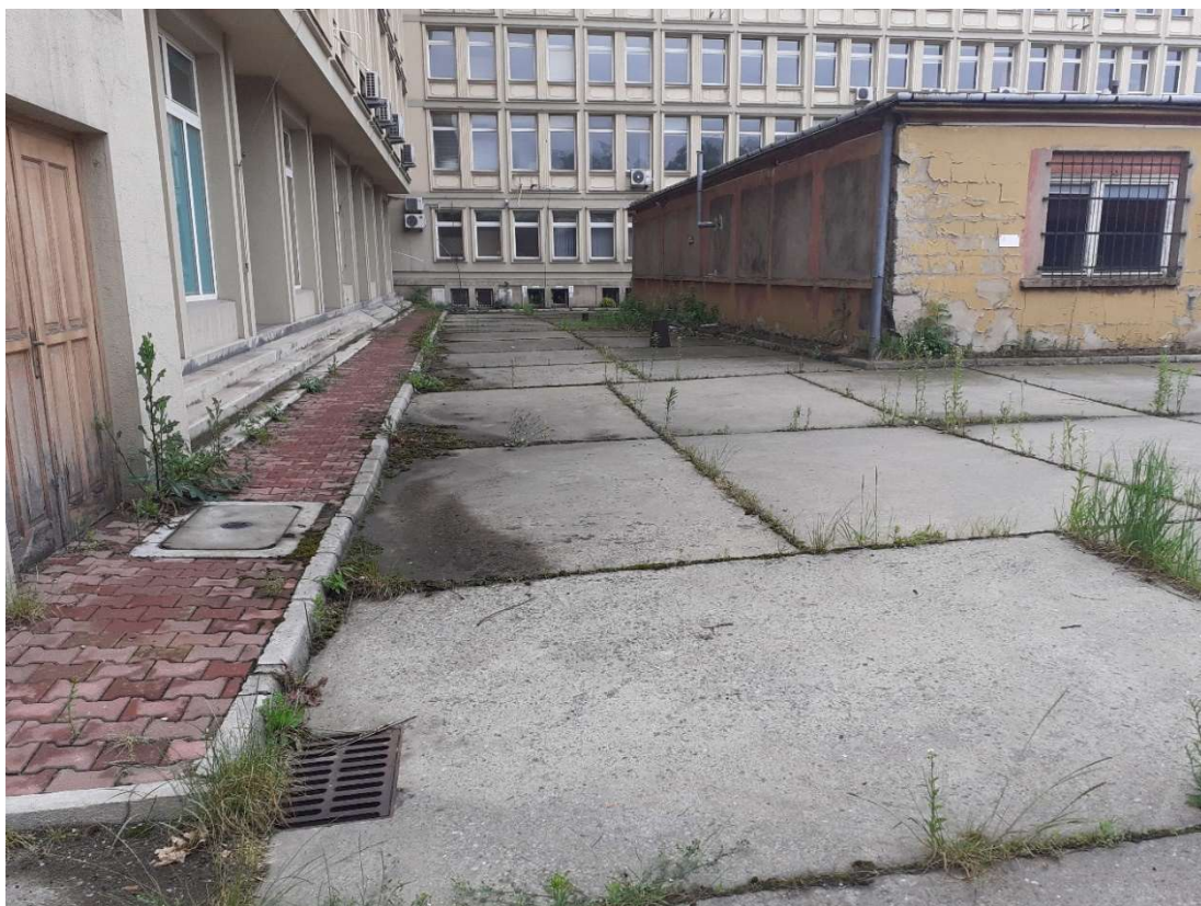
Fot.33 teren za budynkiem, zdegradowana nawierzchnia, uskoki pomiędzy płytami, brak odpowiedniego odwodnienia terenu, budynek po Archiwum Narodowym planowany do rozbiórki.
