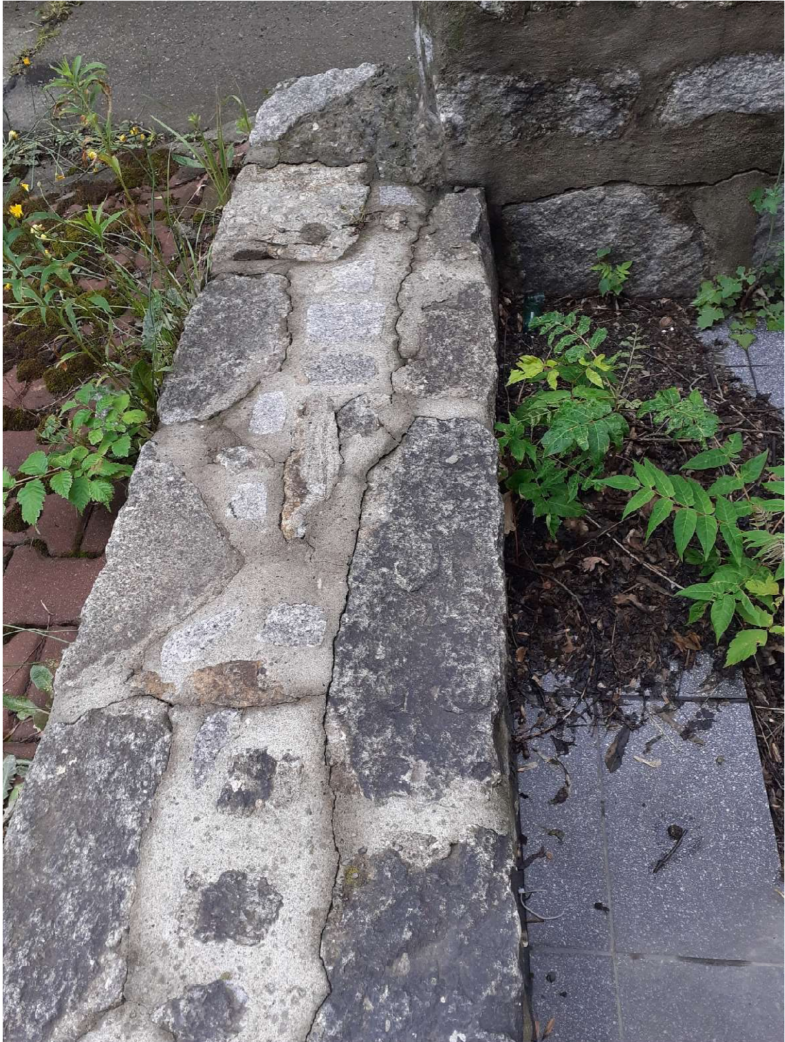
Fot.55 teren za budynkiem, zdegradowane murki terenowe do renowacji – widok z góry.
