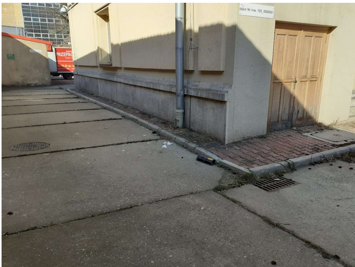
Fot.15 teren za budynkiem, zdegradowane elementy nawierzchni, uskoki pomiędzy płytami.
